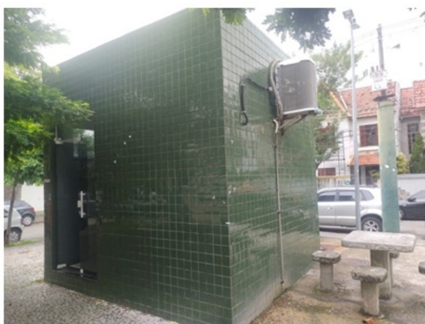
Foto 10 – Abrigo quadros elétricos de comando
