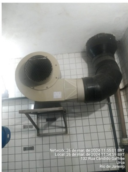
Foto 5 – Exaustor abrigo das bombas
