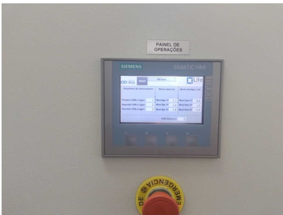
Foto 14 – Sequência acionamento bombas
