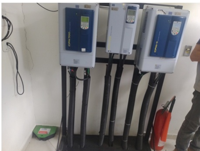
Foto 12 – Inversores de frequência
