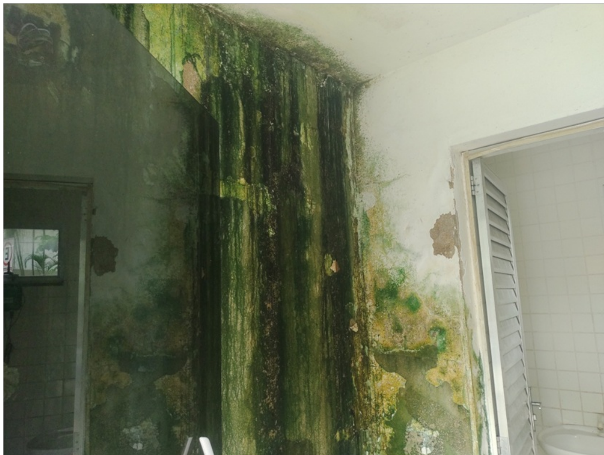
Foto 16 – Infiltração severa abrigo dos quadros da elevatória
