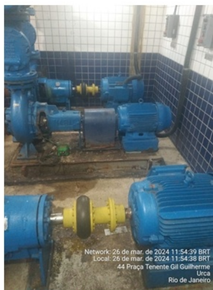
Foto 6 – Conjunto motores bombas
