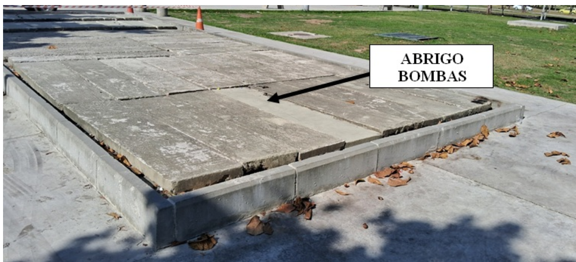
Foto 3 – Abrigo gradeamento e bombas
