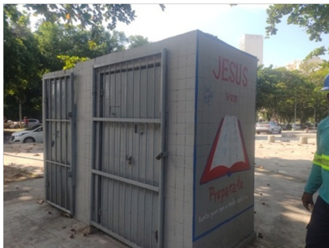
Foto 8 – Abrigo quadro elétrico de comando
