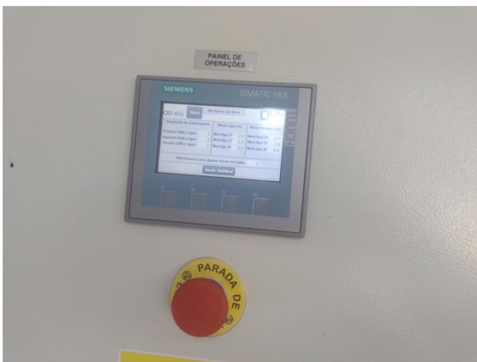
Foto 12 – Sequência acionamento bombas
