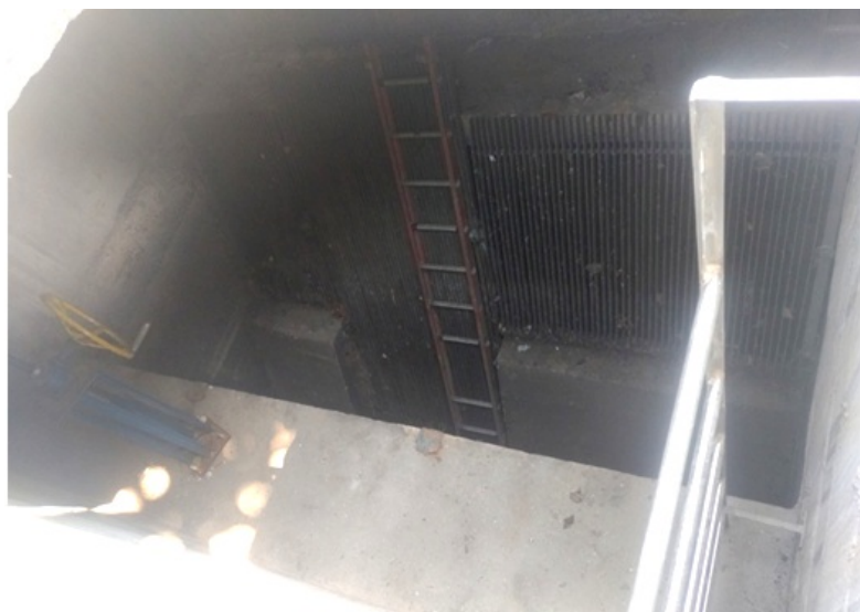
Foto 4 – Poço de visita (Gradeamento)
