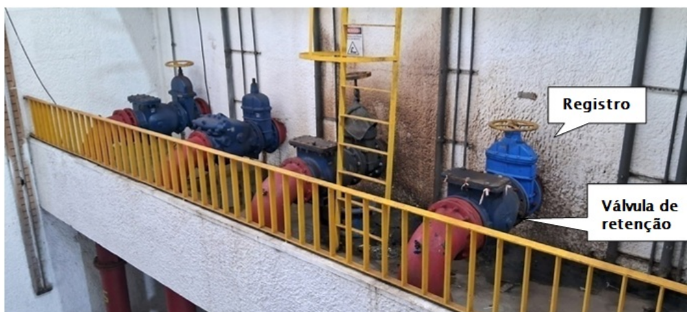
Foto 7 - Válvulas de retenção e registros das motobombas.
