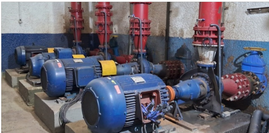
Foto 6 – Conjunto das 4 motobombas da elevatória.
