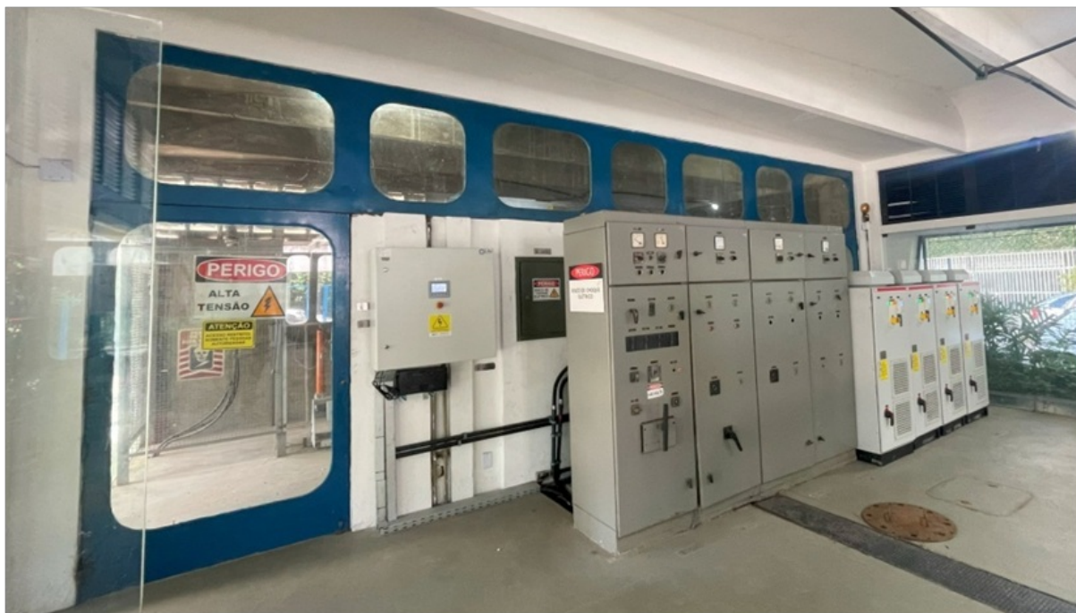
Foto 9 - Localização dos painéis de controle das bombas com sinalização de risco de choque elétrico.
