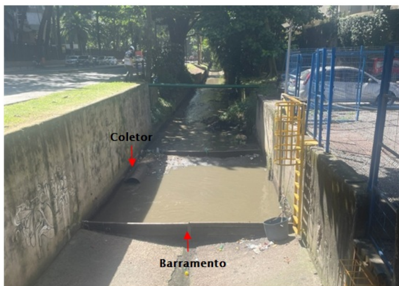
Foto 2 – Coletor de chegada do esgoto.
