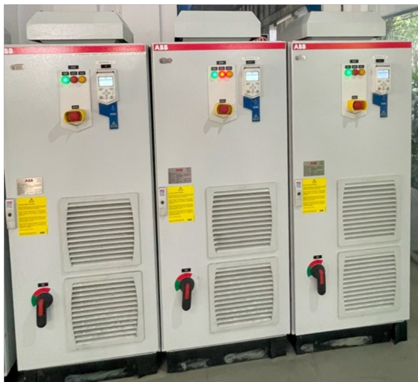
Foto 10 - Painéis de controle das bombas em bom estado de conservação e devidamente sinalizados contra riscos de choque elétrico.
