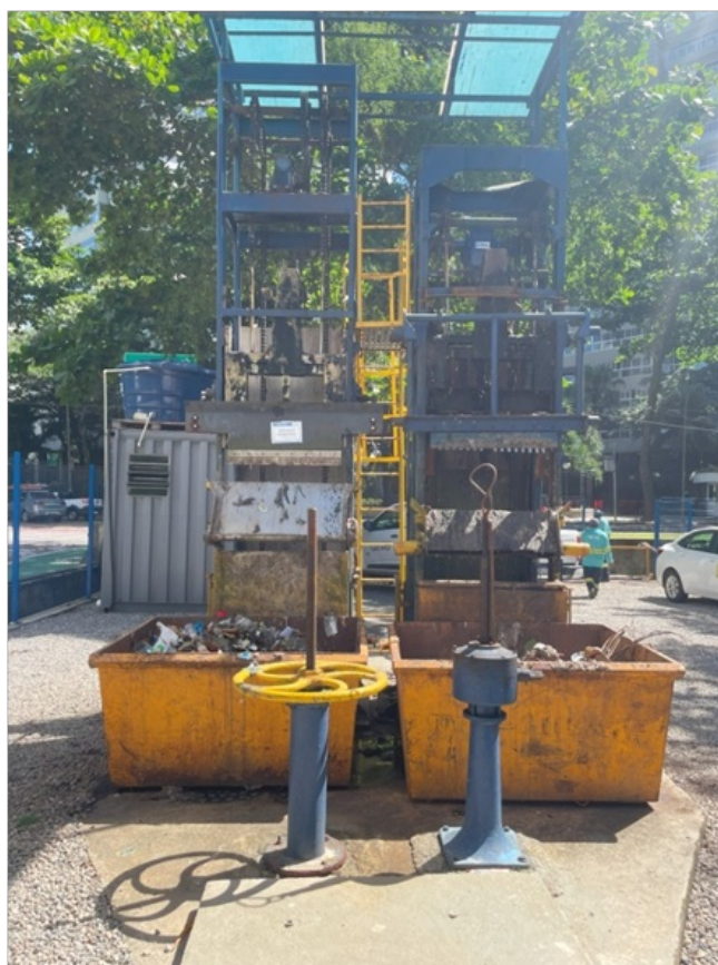
Foto 5 – Gradeamento secundário com grades mecanizadas e caçambas de acumulação dos resíduos a céu aberto.
