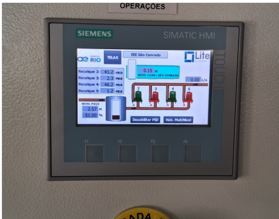
Foto 11 - Painel de comando das motobombas.
