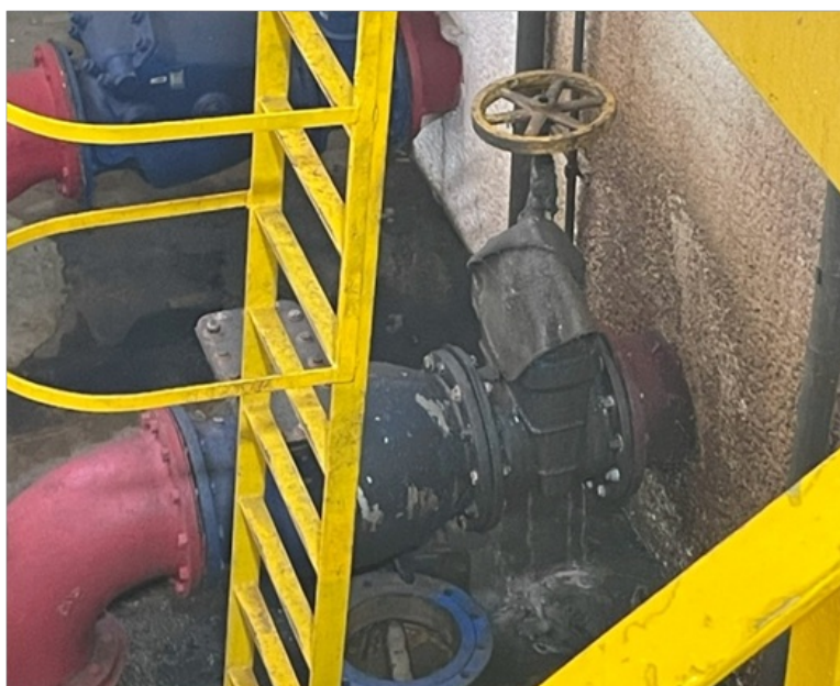
Foto 8 - Vazamento no registro de uma das motobombas.
