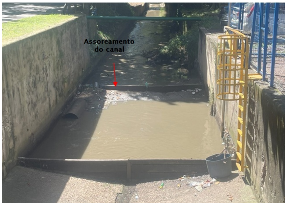
Foto 4 - Assoreamento na chegada do esgoto.
