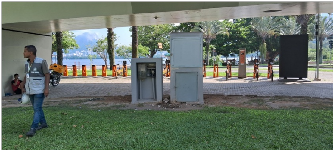
Foto 1 – Vista geral da estação com destaque para os painéis elétricos de controle
