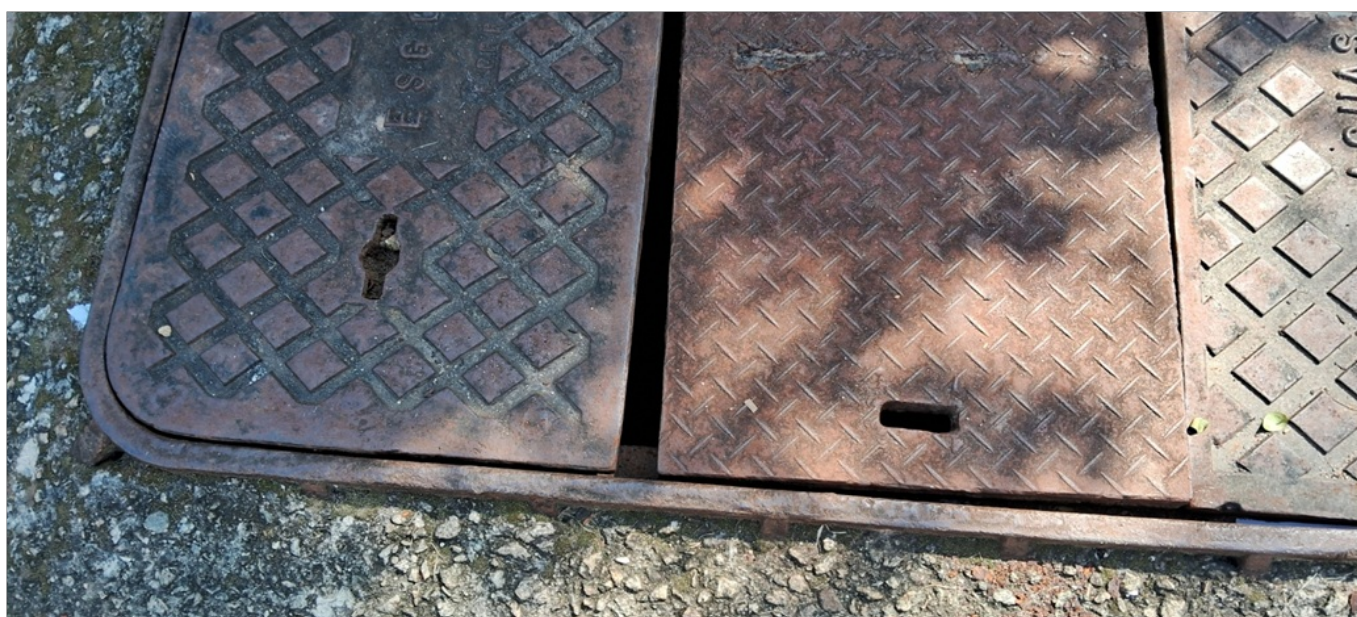
Foto 6 – Tampas do poço de visita das bombas, destaque do grande vão entre as tampas
