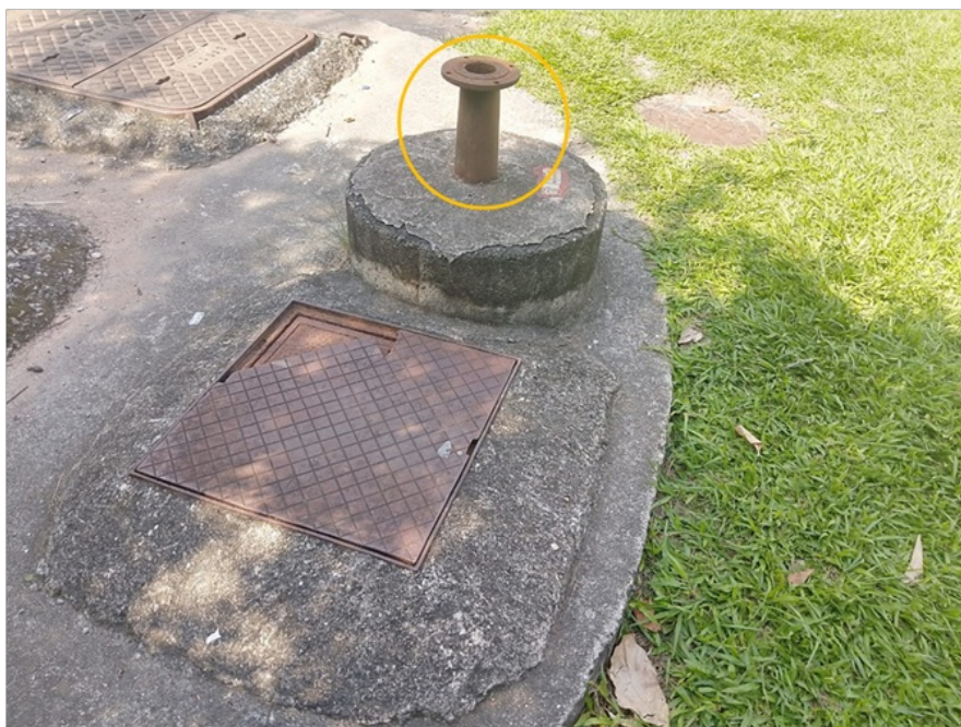
Foto 7 – Corpo do registro da comporta que não está funcionando
