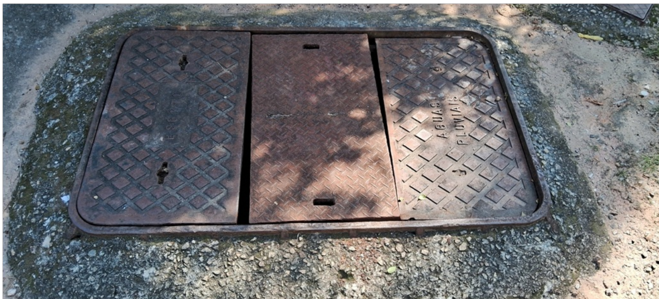
Foto 5 – Tampa do poço de visita das bombas, destaca-se a vedação inadequada
