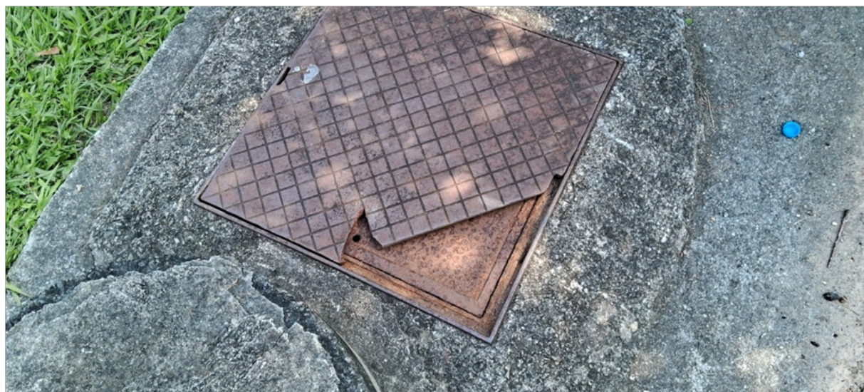
Foto 3 – Tampa do poço de sucção danificada
