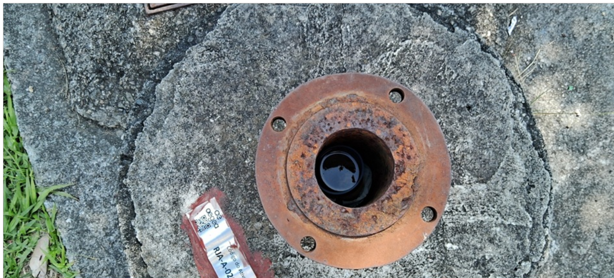
Foto 8 – Corpo do registro quebrado servindo para acúmulo de água
