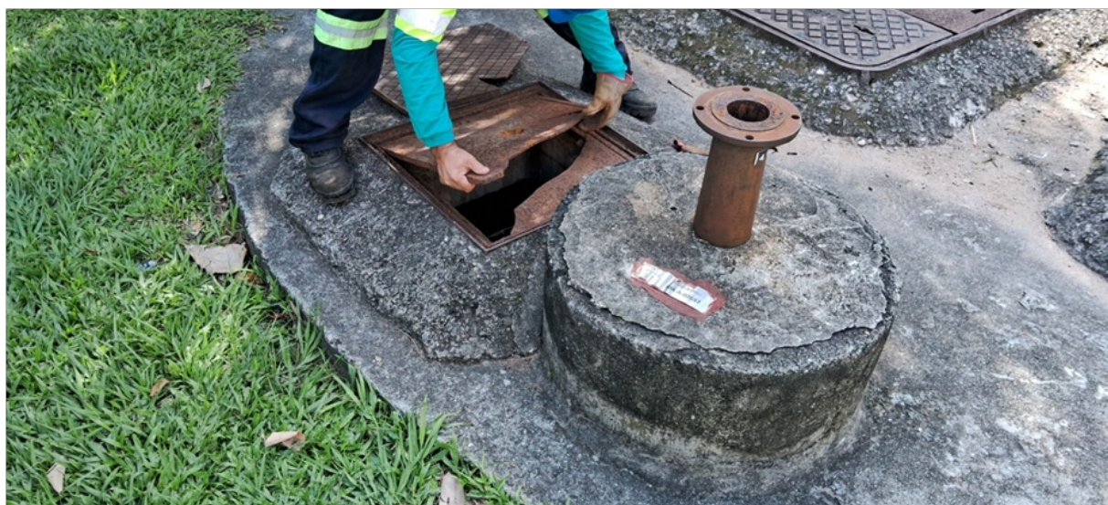
Foto 4 – Operador retirando a tampa danificada, que fica próxima à antiga comporta
