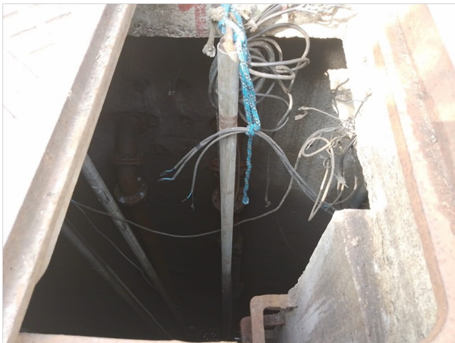
Foto 10 – Vista interna do poço das bombas e barrilete de recalque
