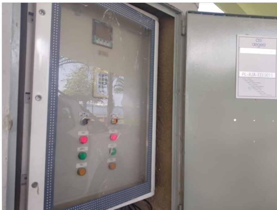
Foto 13 – Pannel elétrico de comando
