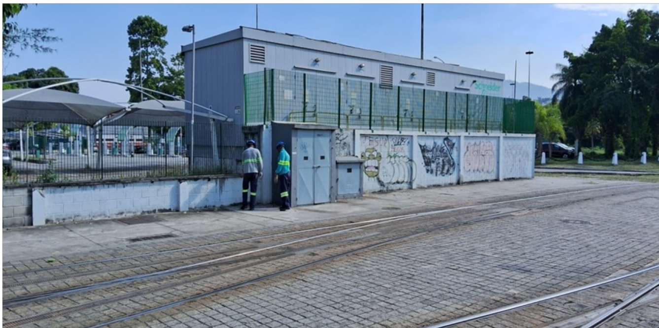
Foto 1 – Abrigo do painel de controle dos conjuntos motobombas e painel de equipamentos elétricos.
