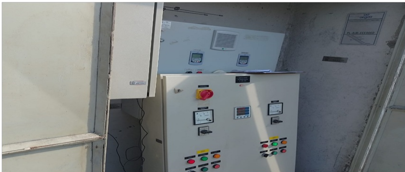
Foto 3 – Vista dos painéis de comando.
