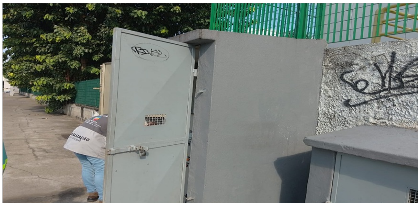
Foto 2 – Abrigo do painel de controle e painel de equipamentos elétricos.
