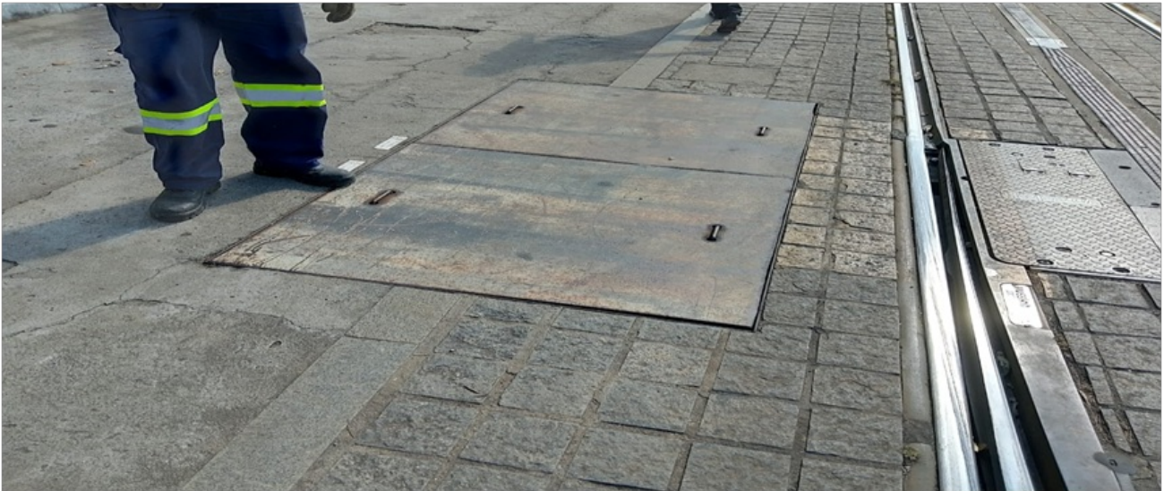
Foto 5 – Poço de sucção onde estão localizados os conjuntos motobombas submersíveis
