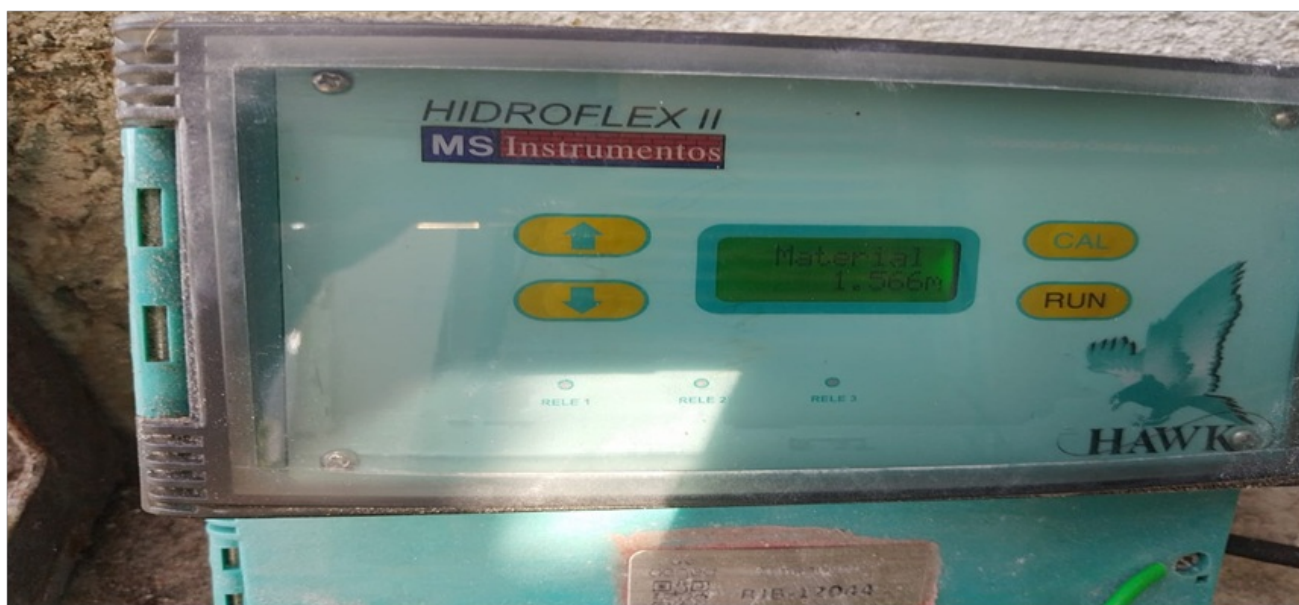
Foto 4– Vista do sensor de nível do poço de sucção.
