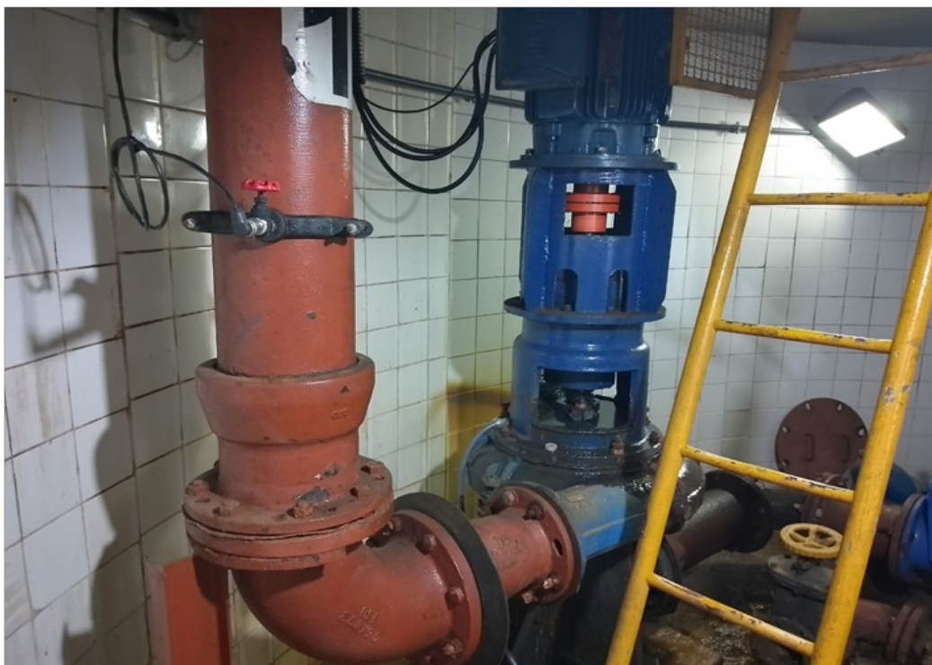
Figura 8 - Área da bomba 1.
