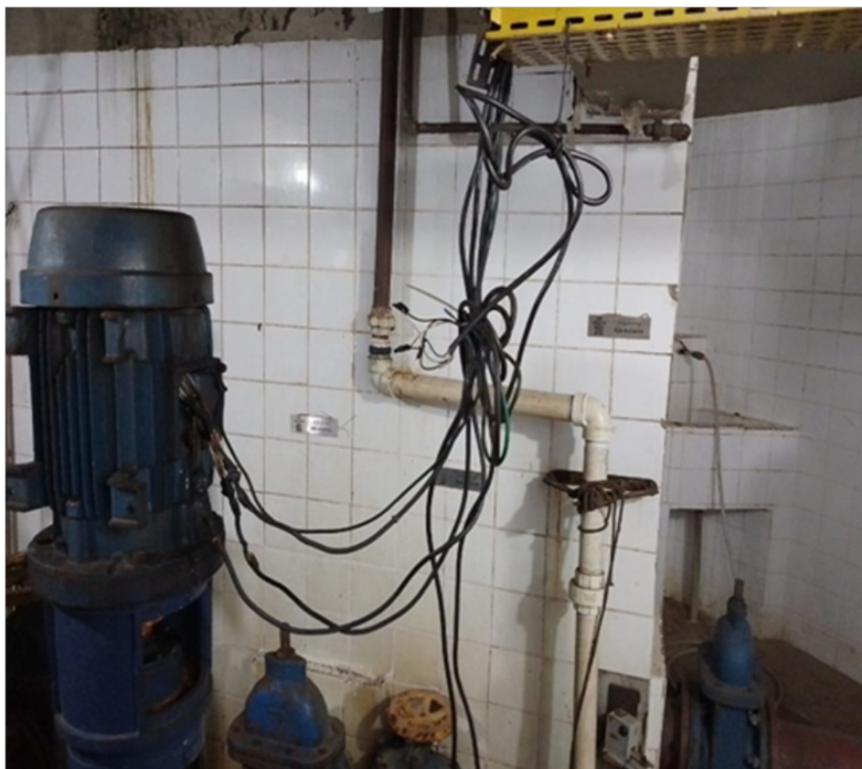
Figura 6 – Banco de dutos elétricos das bombas
