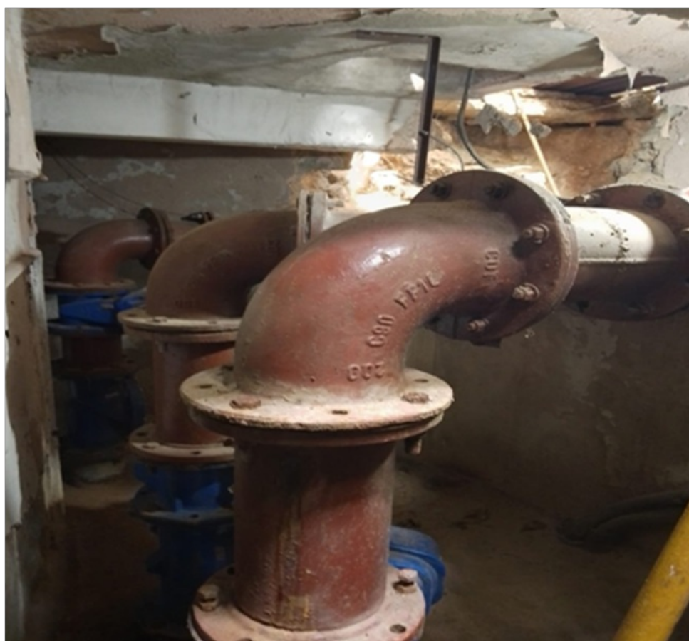
Figura 7- tubulação de recalque.
