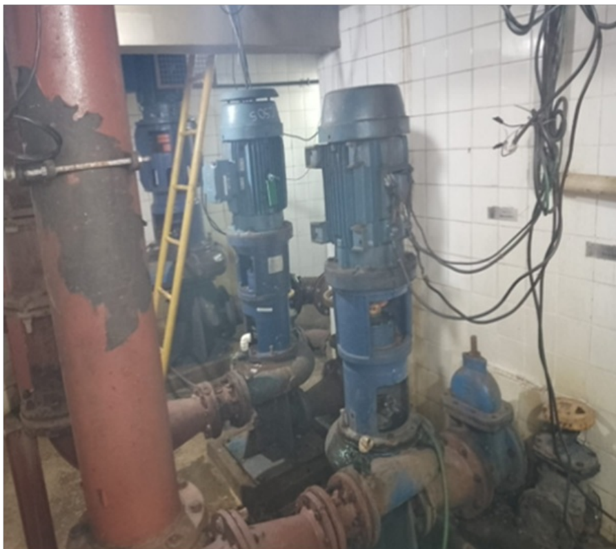
Figura 5 - Vista dos conjuntos motobombas
