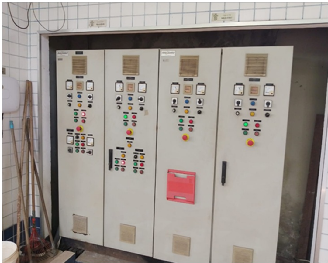
Foto 2 - Vista dos painéis de comando
