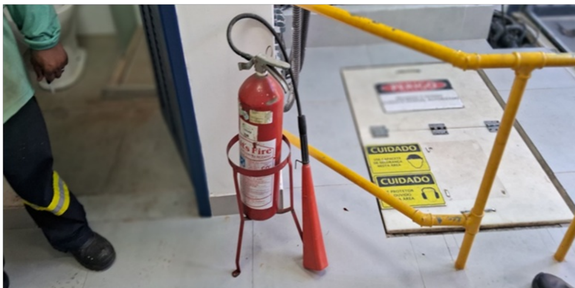
Foto 4 - Vista do tampão interno para acesso ao compartimento das bombas
