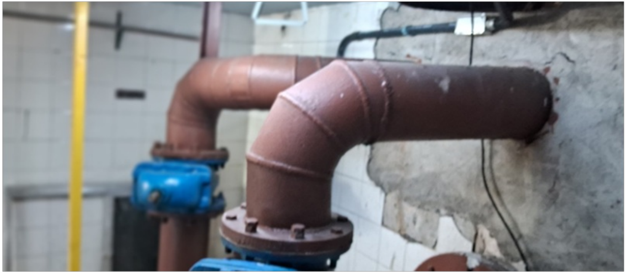
Foto 8- Tubulação barrilete de recalque de DN 200 mm
