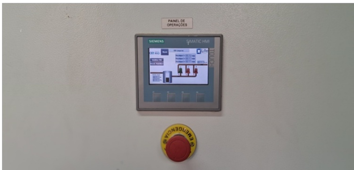
Foto 5 - Vista do painel de operações
