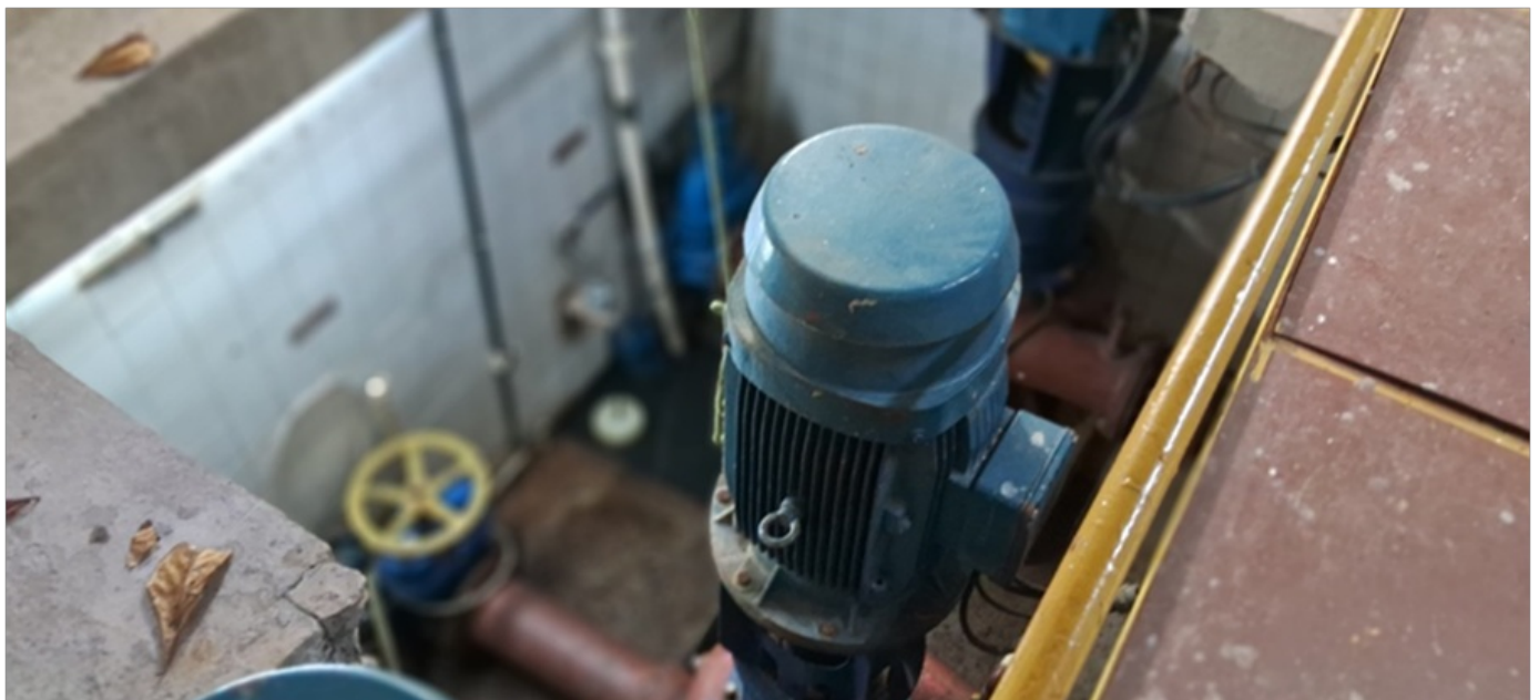
Foto 7- Vista dos conjuntos motobombas
