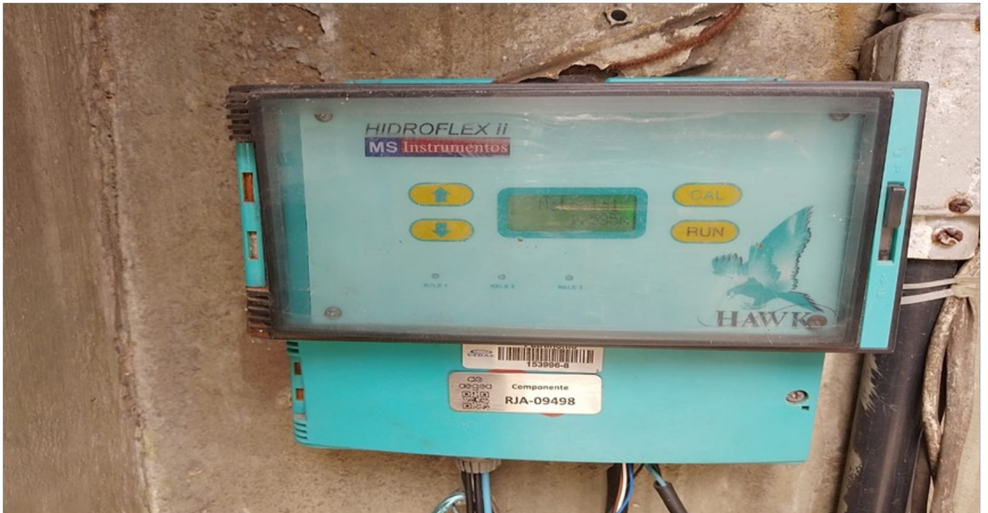
Foto 3- Vista do sensor de nível do poço de sucção.
