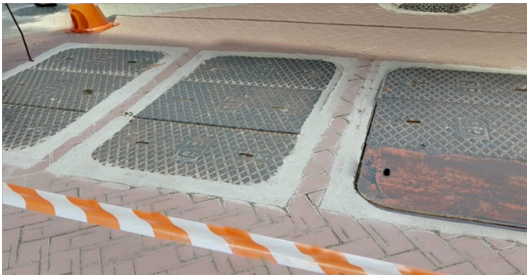
Foto 4 -Vista do tampão para acesso ao compartimento das bombas
