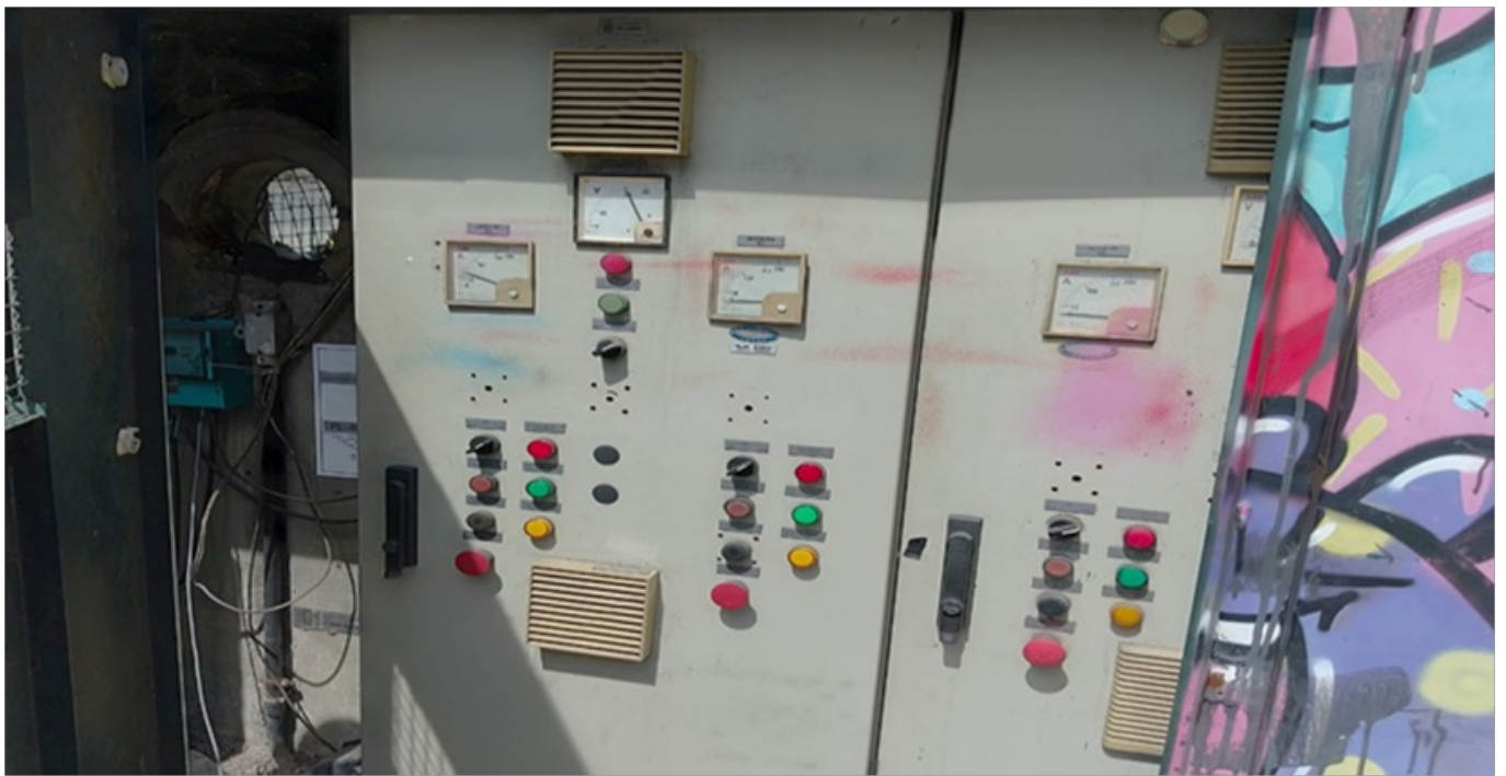
Foto 2- Vista dos painéis de comando.
