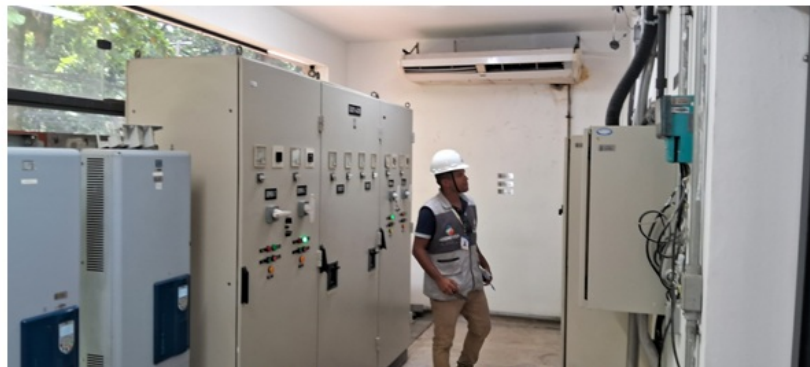
Figura 28 – Vista da sala de comando e controle.
