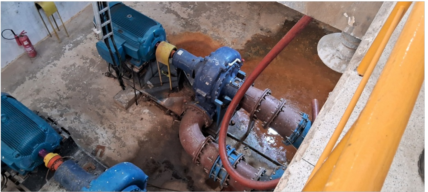
Figura 14 – Sala de bombas, vista do conjunto motor-bomba 4, em que havia vazamento
