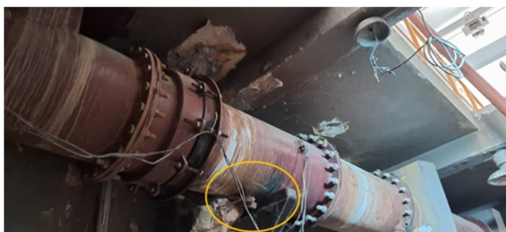
Figura 20 – Tubulação de recalque apoiada improvisadamente sobre cunhas de madeira, luminária sem lâmpada para servir de ponto elétrico.
