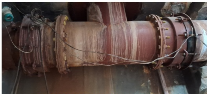
Figura 19 – Marcas de vazamento de efluentes no barrilete do recalque.
