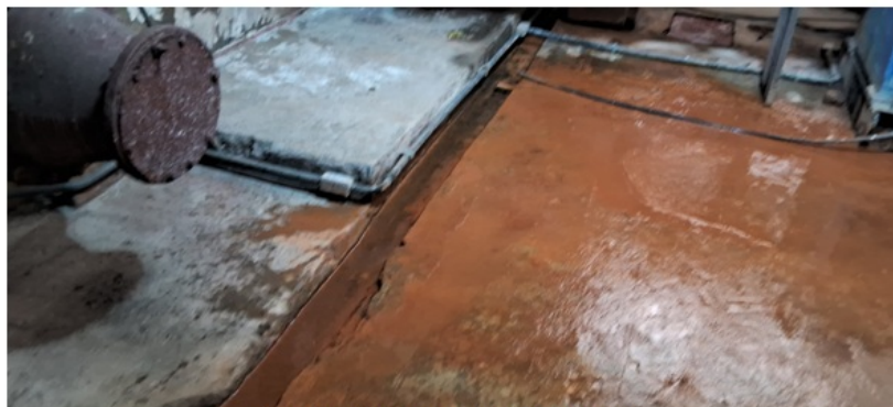
Figura 21 – Esgoto escoando pelo piso das bombas.
