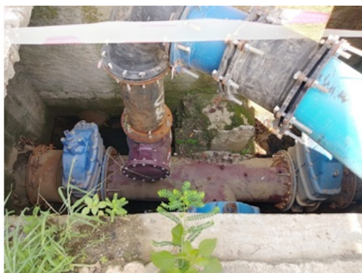
Figura 23 – Vista do barrilete da tubulação de recalque.
