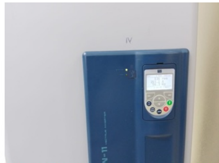
Figura 27 – Painel do inversor de frequência da motor-bomba 4.
