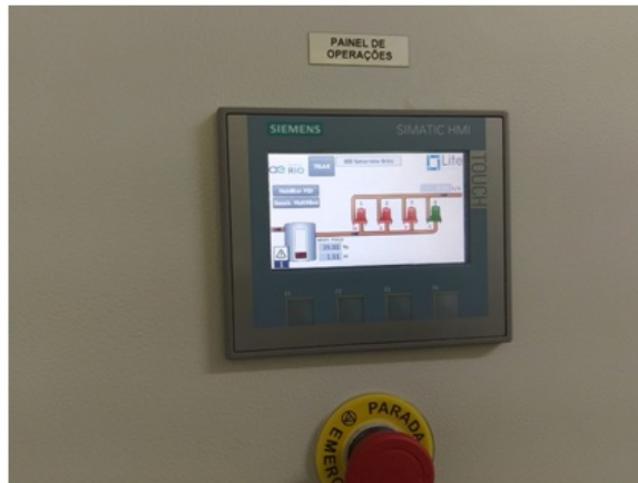
Figura 26 - Display de monitoramento das motor-bombas e poço de sucção.
