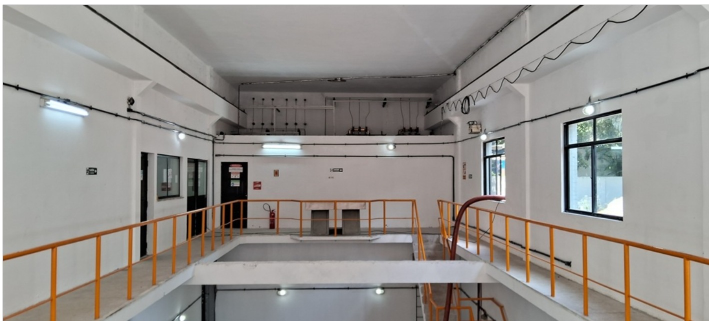
Figura 9 – Sala de bombas, vista do patamar dos quadros elétricos de comando
