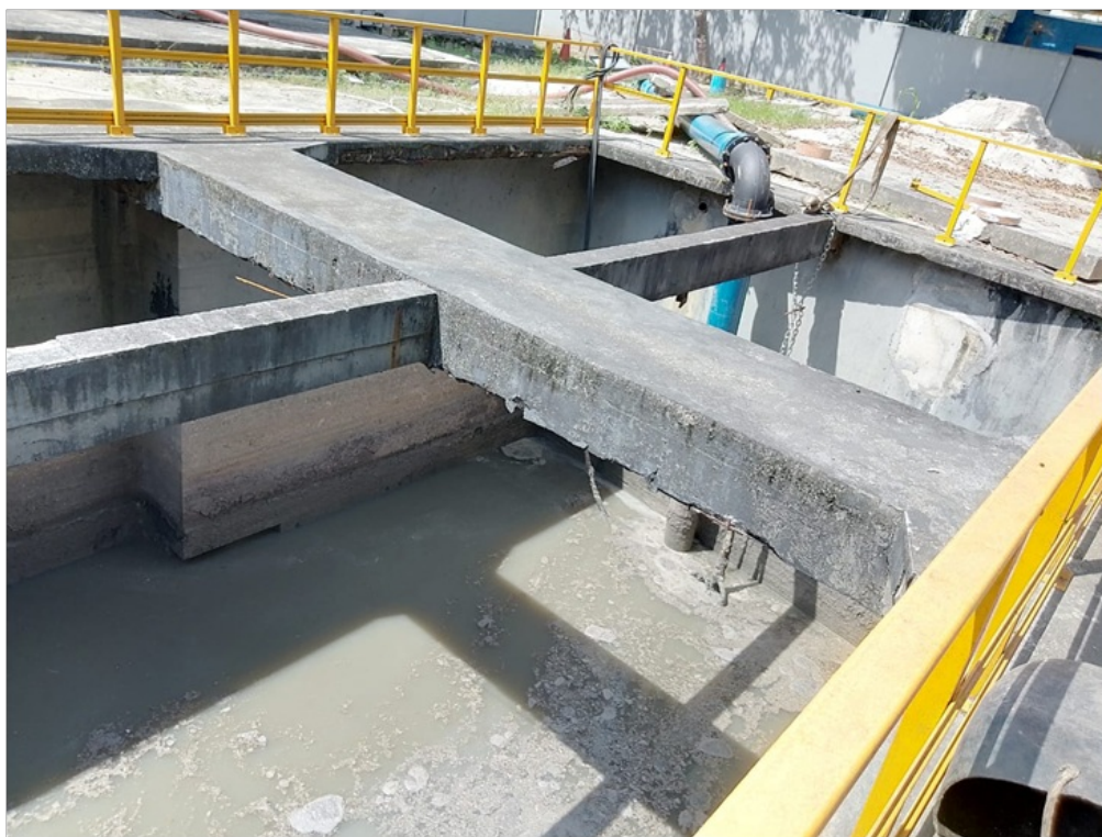
Figura 8 – Poço de sucção
