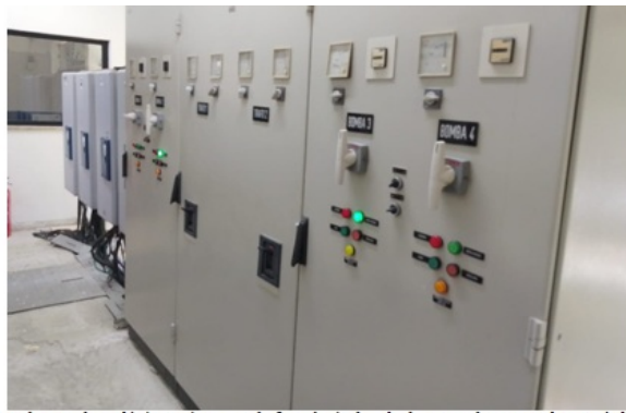
Figura 25 – Vista dos quadros elétricos e inversor de frequência da sala de comando e controle, que é climatizada.
