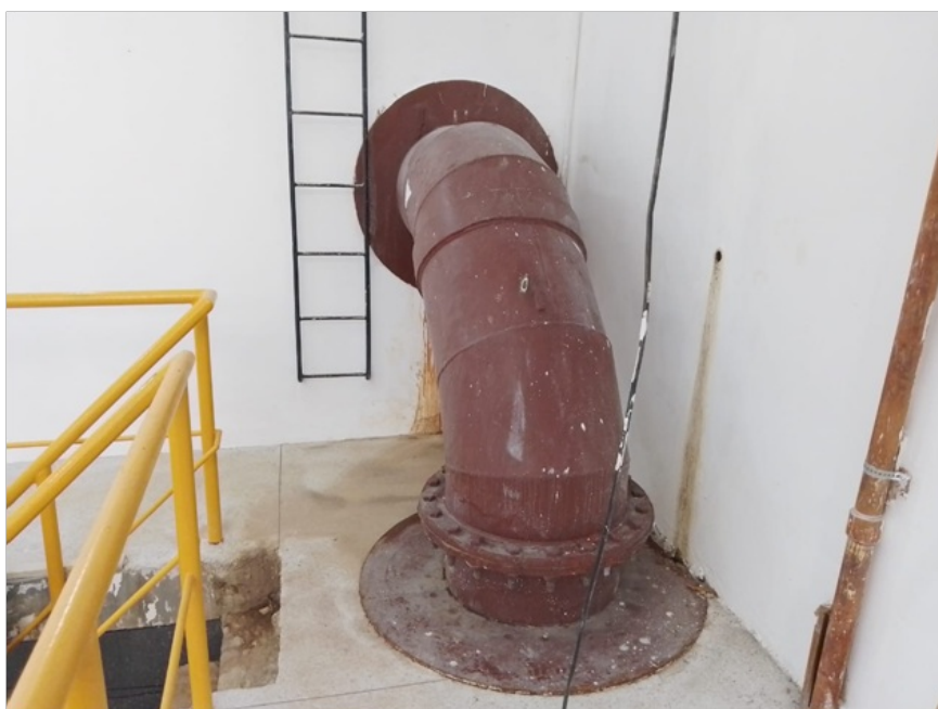
Figura 12 – Tubulação de recalque localizada no patamar intermediário.
