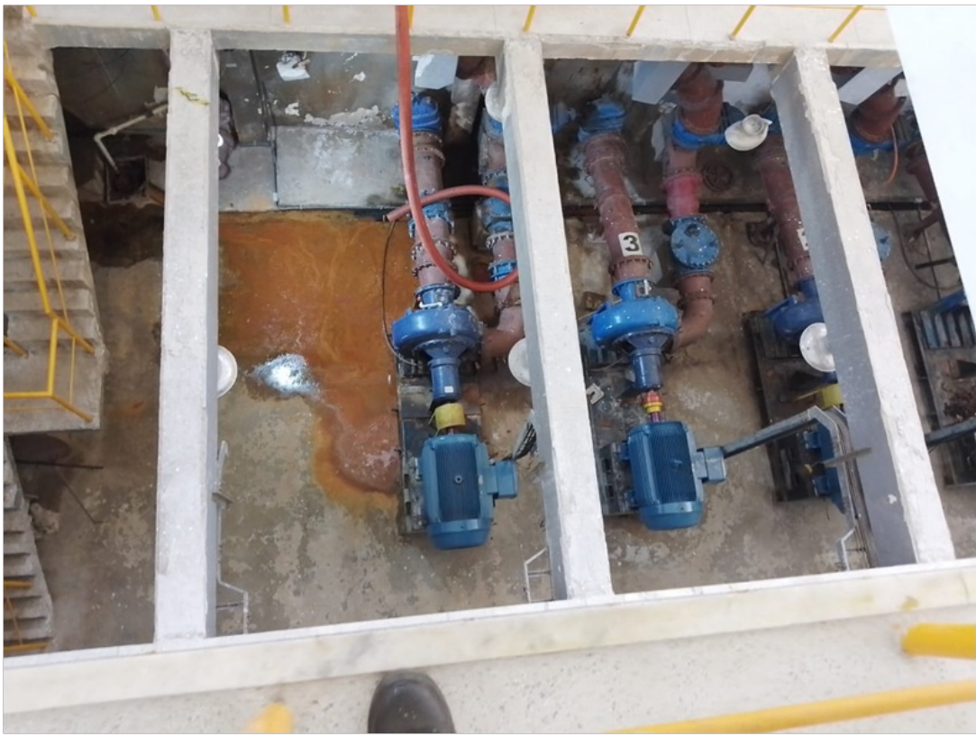
Figura 13 – Sala de bombas, vista do piso dos conjuntos motor-bombas e área com vazamento
