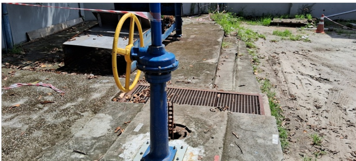
Figura 4 – Volante da comporta do gradeamento 1. Nota-se que o mecanismo de fechamento antigo foi substituído, mas não foi retirado
