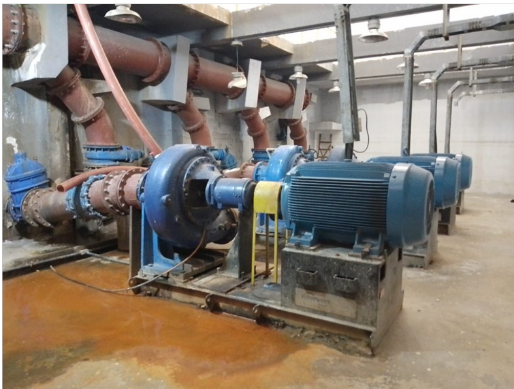
Figura 15 – Sala de bombas, vista da bomba 4, em que havia vazamento
