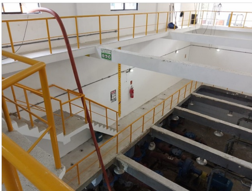
Figura 11 – Sala de bombas, vista do patamar intermediário
