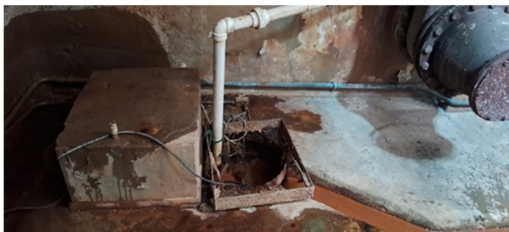
Figura 18 – Poço e tubulação de drenagem dos vazamentos ocorridos na sala de bombas.
