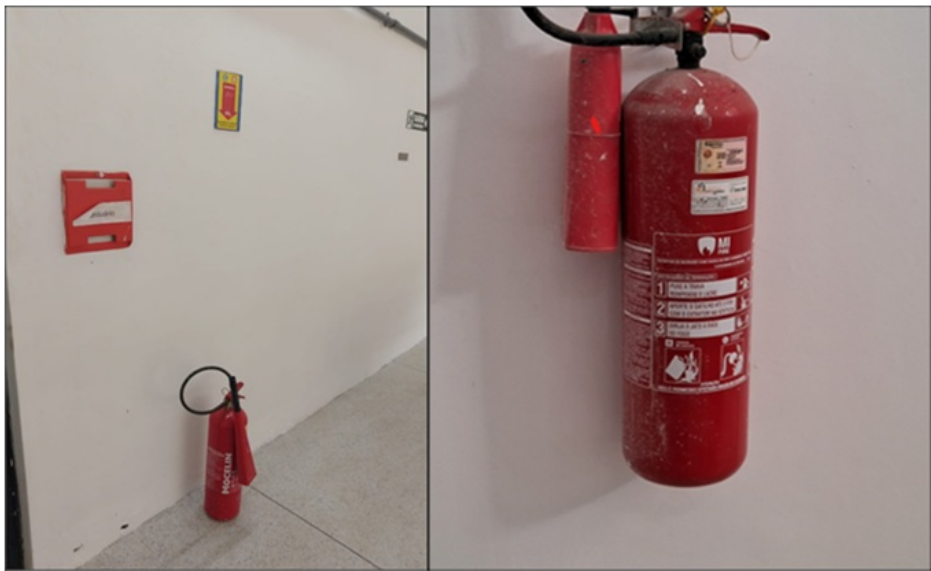
Figura 29 – Extintores de incêndio disponíveis na sala de bombas
