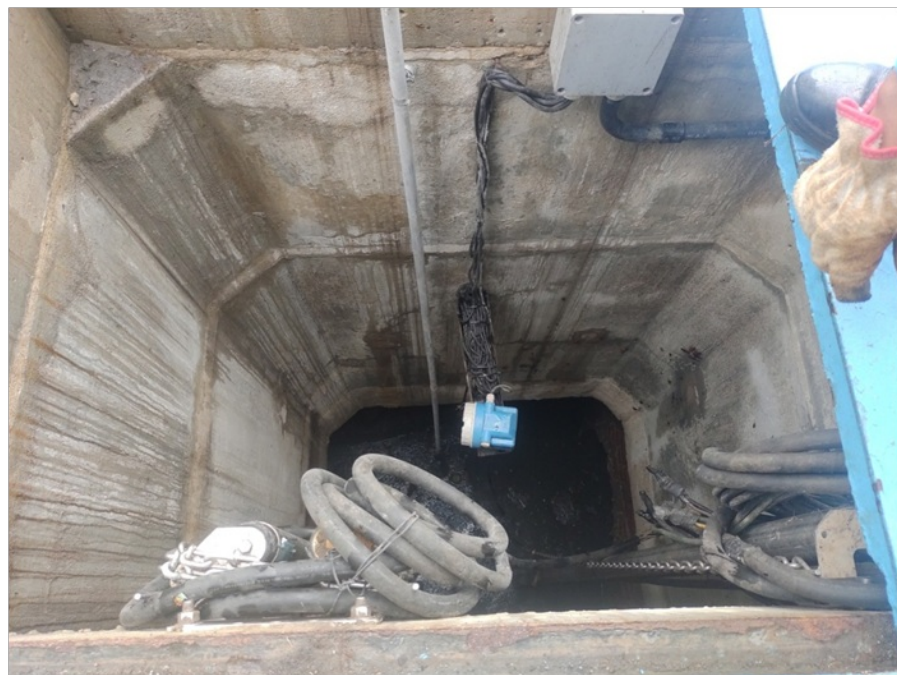
Figura 4 – Poço de sucção – vista do sensor de nível.
