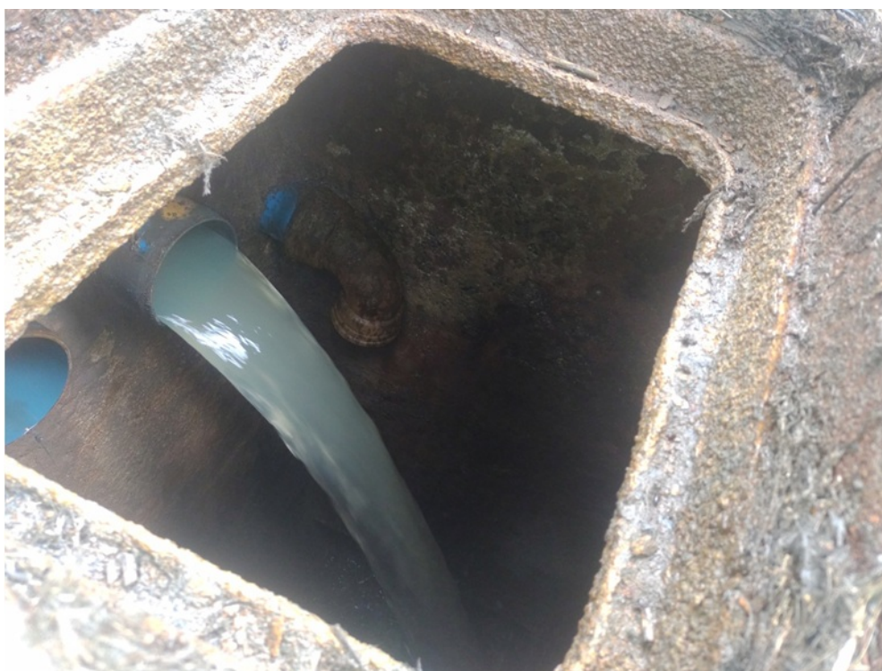
Figura 10 – Área interna do PV onde ocorre a descarga do efluente
