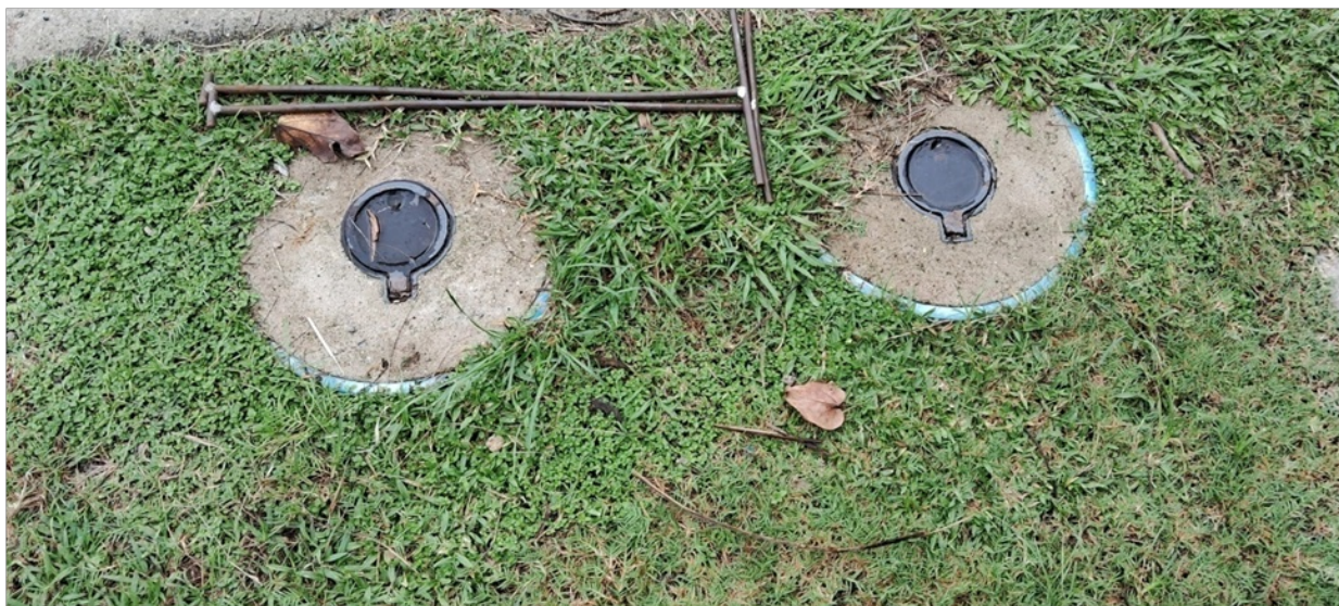
Figura 5 – Vista dos registros para fechamento da tubulação de recalque
