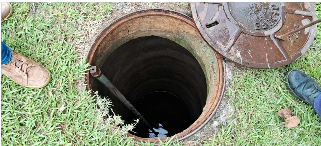
Figura 8 – Poço onde se localiza registro para controle do fluxo do esgoto afluyente à estação
