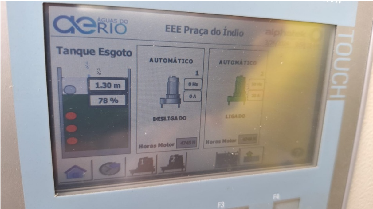
Foto 12 – Tela de controle do painel de comando eletroeletrônico indicando o nível do esgoto no poço
