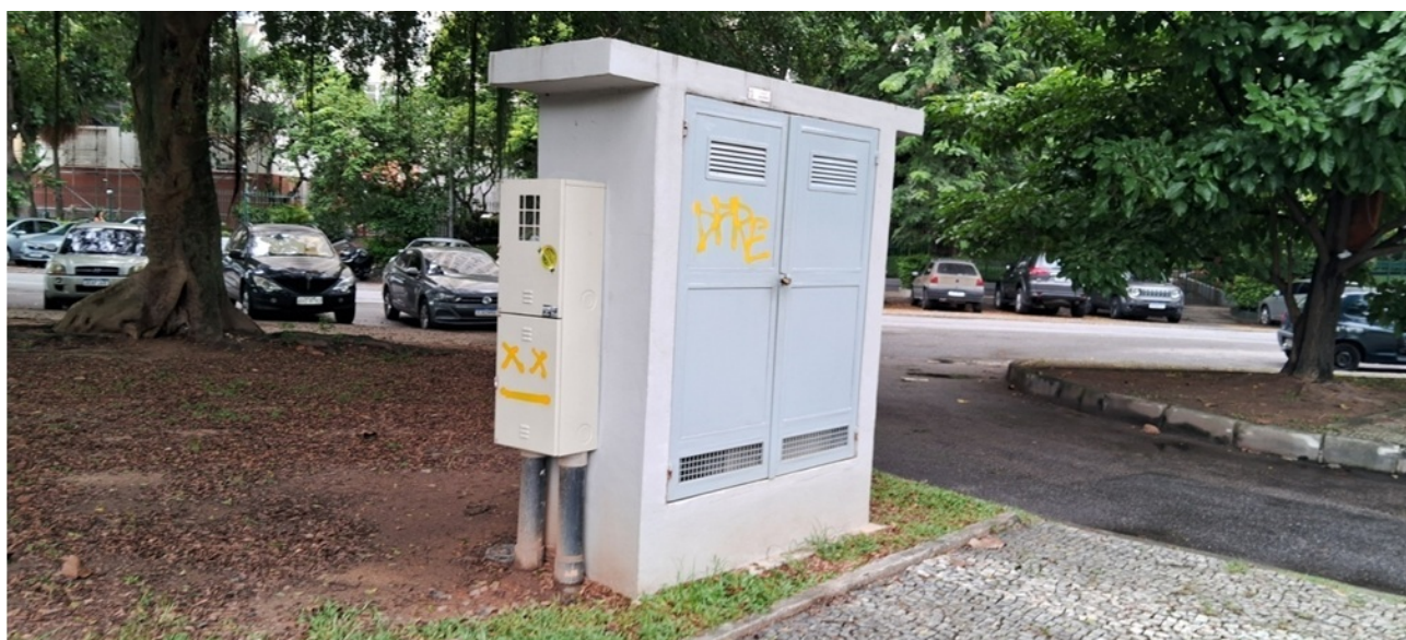
Foto 11 – Abrigo do quadro de energia e painel de comando eletroeletrônico e medidor de energia
