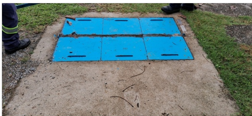
Figura 2 – Tampa do poço de sucção, bem conservada, nivelada e com cadeados.
