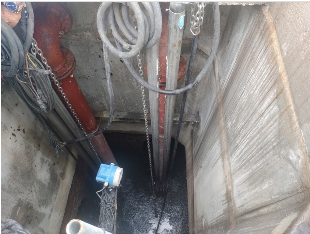
Figura 3 – Poço de sucção – vista dos ramais de recalque.
