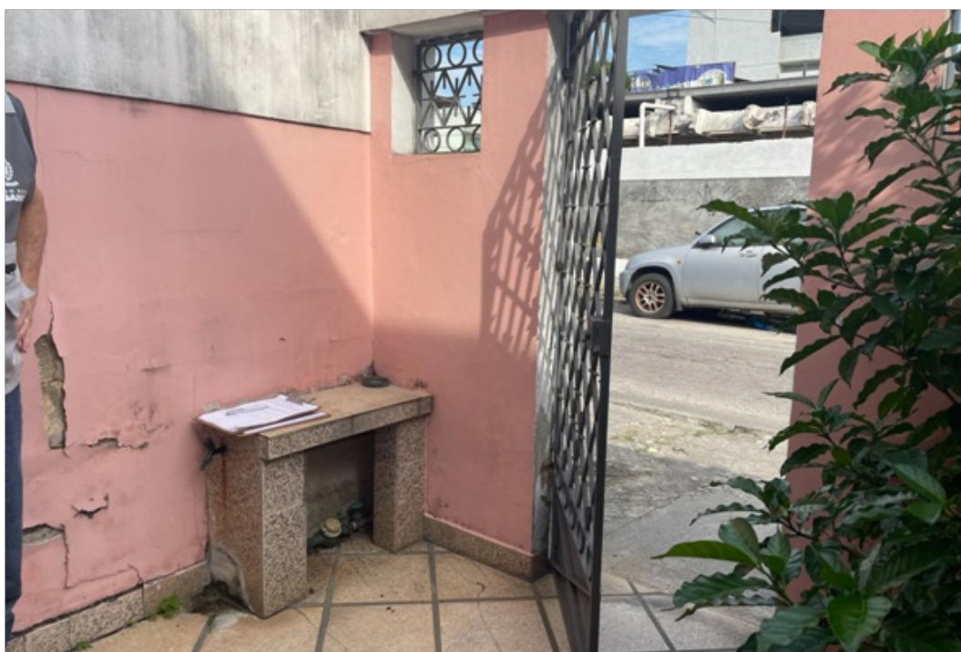
Foto 2 - Hidrômetro localizado perto do portão de entrada da residência.
