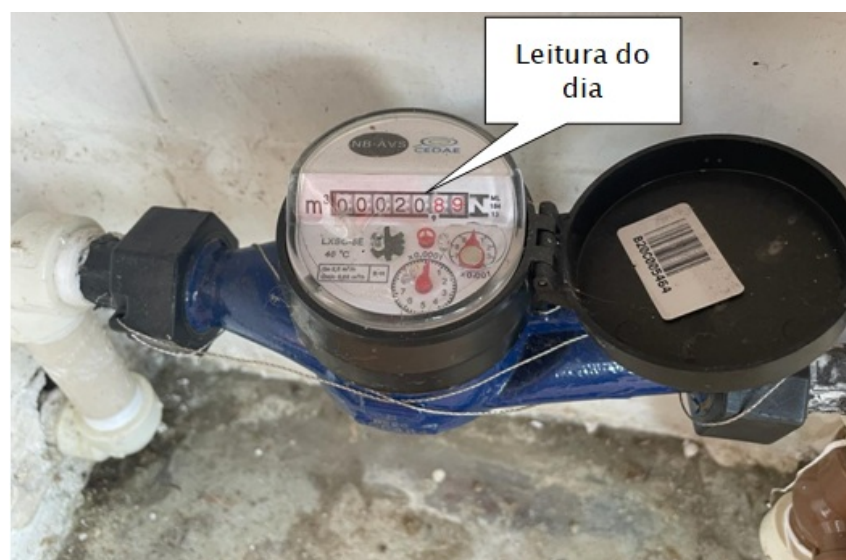
Foto 4 - Hidrômetro com tampa aberta para aferição da leitura.
