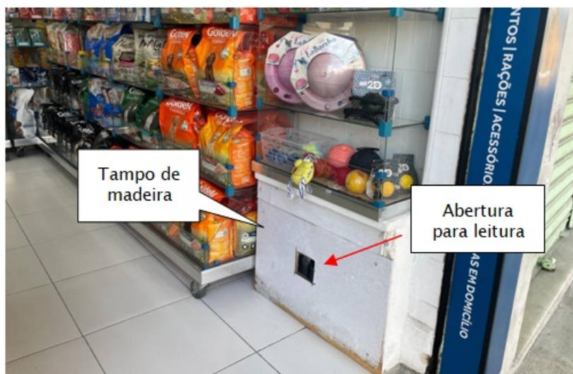
Foto 2 - Localização do hidrômetro dentro do imóvel, protegido por uma tampa de madeira parafusada.
