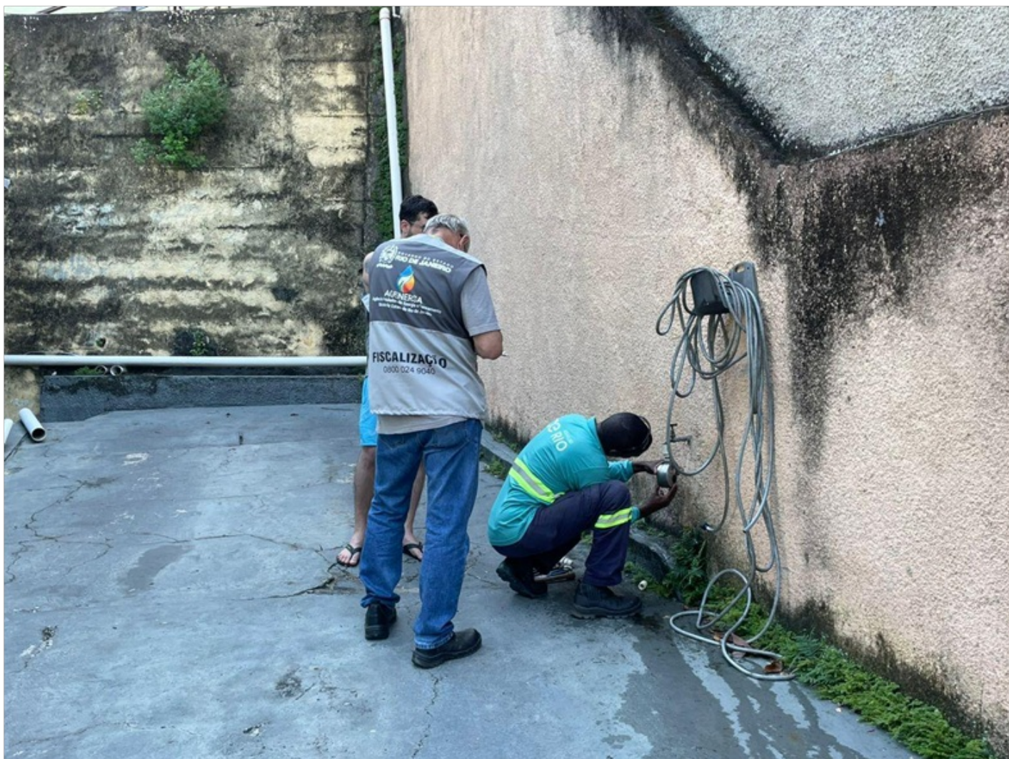
Foto 2 – Medição de pressão manométrica no imóvel nº 94, casa 2, da rua Etna.
