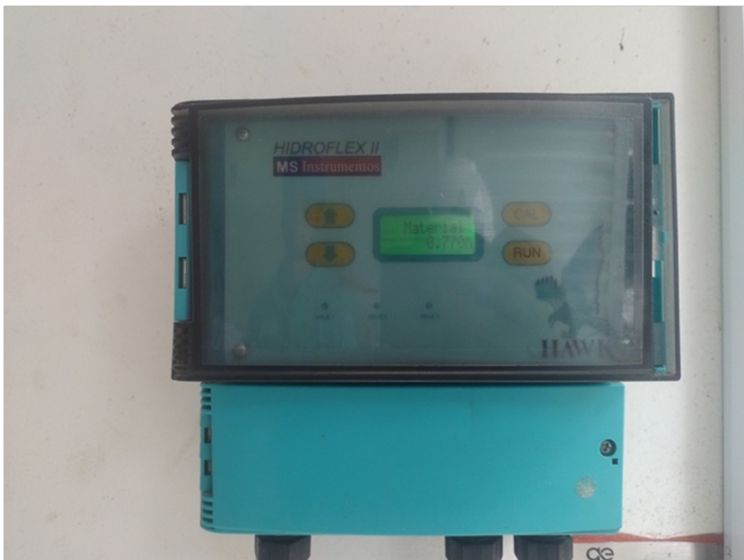
Figura 4 – Painel eletrônico indicando o nível de efluente no poço de sucção
