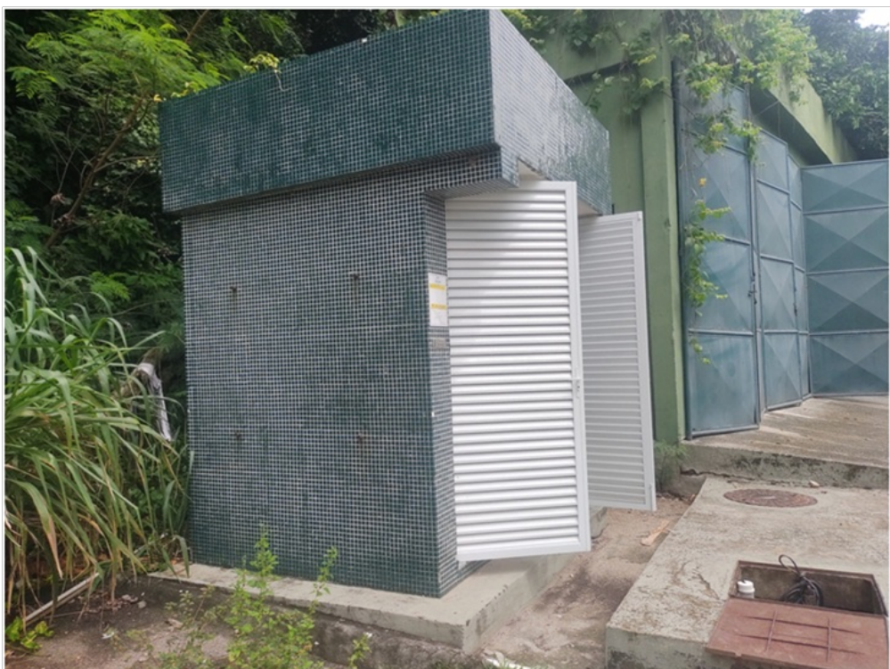
Figura 1 – Abrigo do quadro de controle elétrico.
