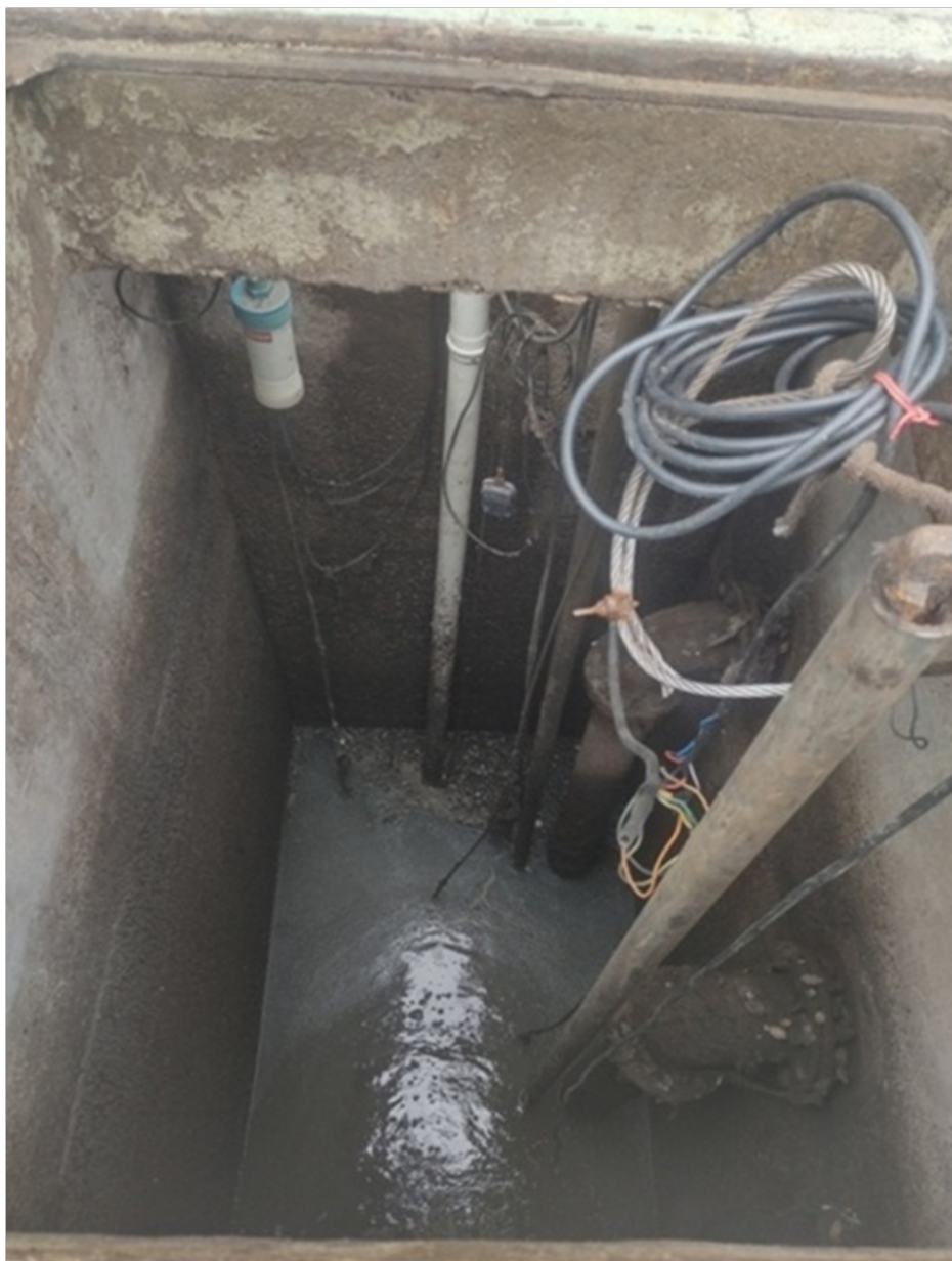
Figura 5 - Poço de sucção com monitoramento eletrônico do nível do efluente.
