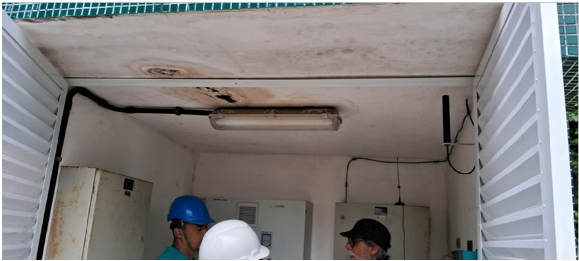
Figura 3 – Manchas no teto do abrigo indicando infiltrações e mofo.
