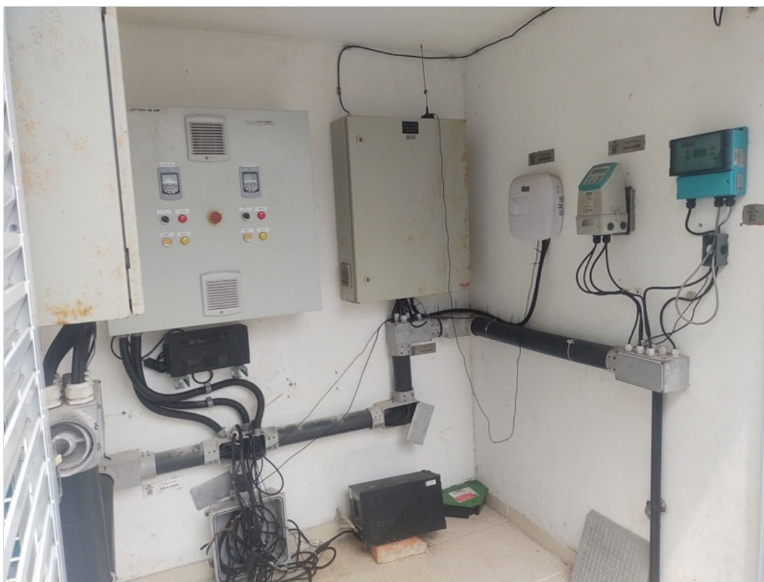
Figura 2 – Área interna do abrigo. Cabos elétricos expostos e equipamento apoiado de maneira improvisada.
