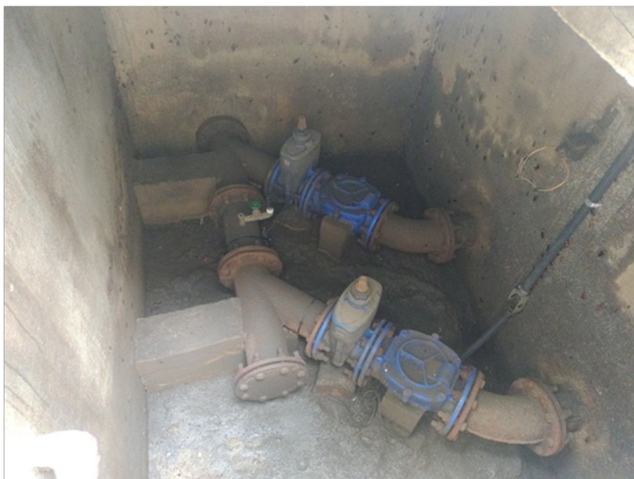
Figura 7 – Barrilete da tubulação de recalque, que possui registro e válvula de retenção para proteção e manutenção da tubulação.
