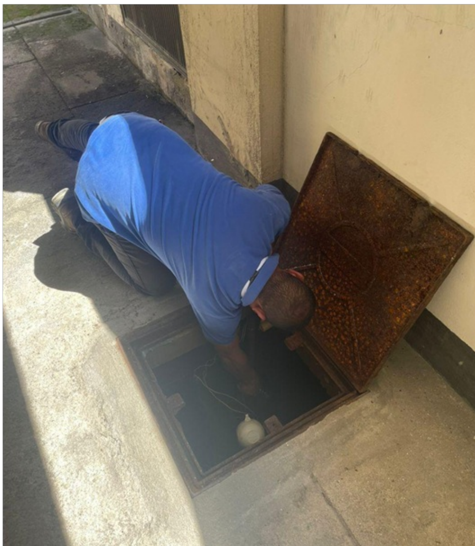
Foto 2 – Reservatório inferior do imóvel nº 396 da rua Formosa, sendo abastecido via distribuidor público.
