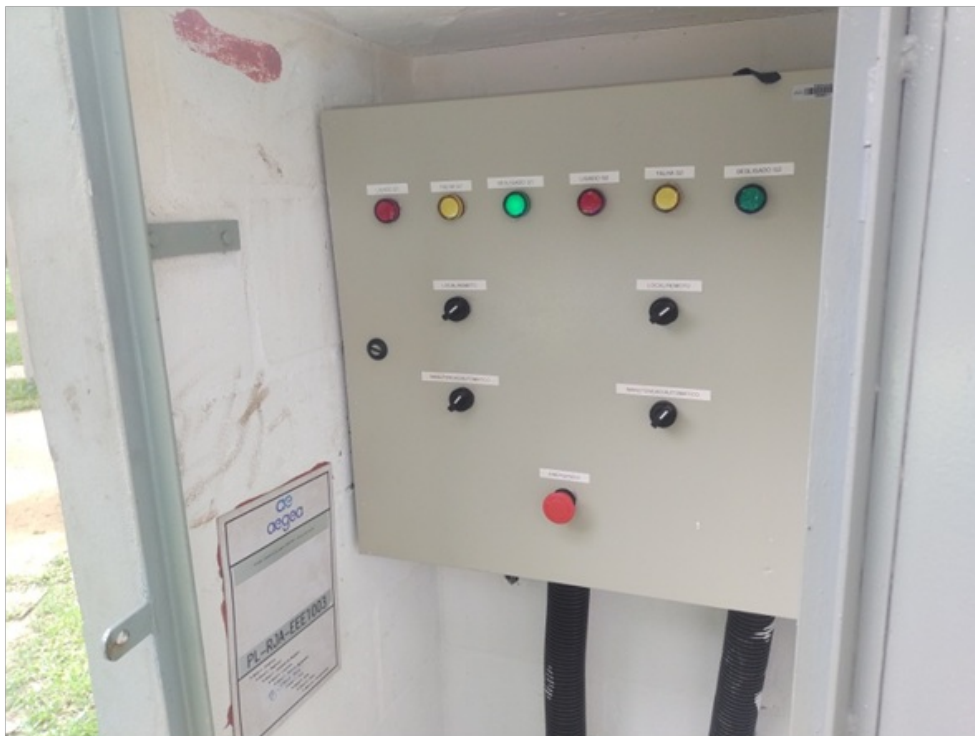
Foto 5 - Painel elétrico em abrigo com bom estado de conservação, mas sem sinalização de risco de choque elétrico.
