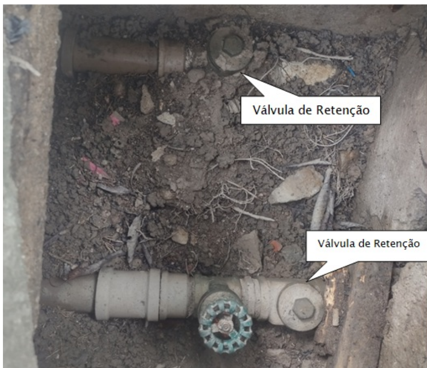
Foto 3 - Barrilete onde está localizada a válvula de retenção e a ventosa
