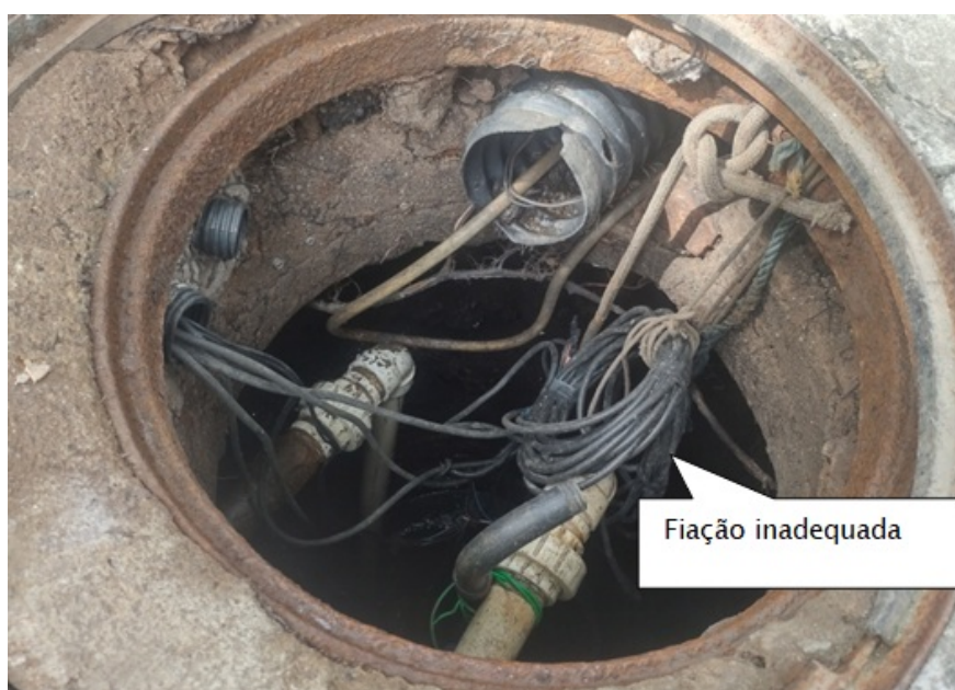
Foto 2 - Poço de sucção onde está instalado o conjunto motobomba.
