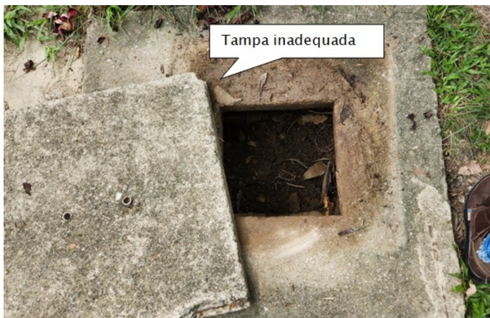
Foto 4 - Tampa inadequada no barrilete.
