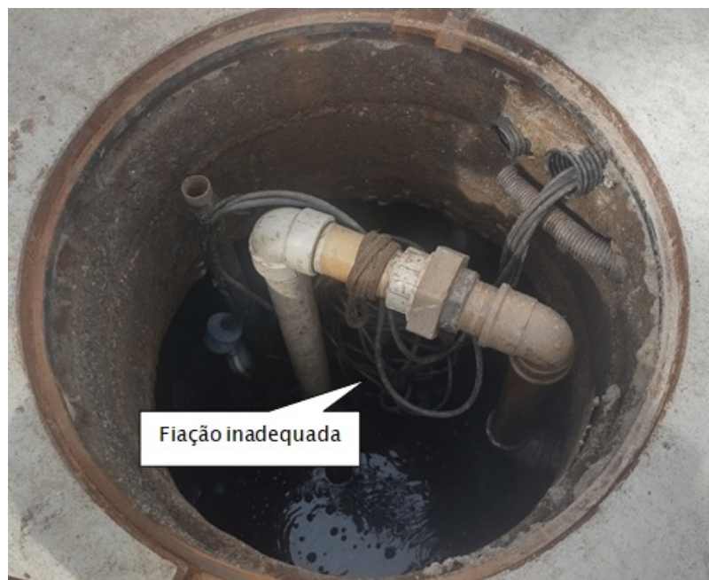
Foto 2 - Poço de sucção onde está instalado o conjunto motobomba.
