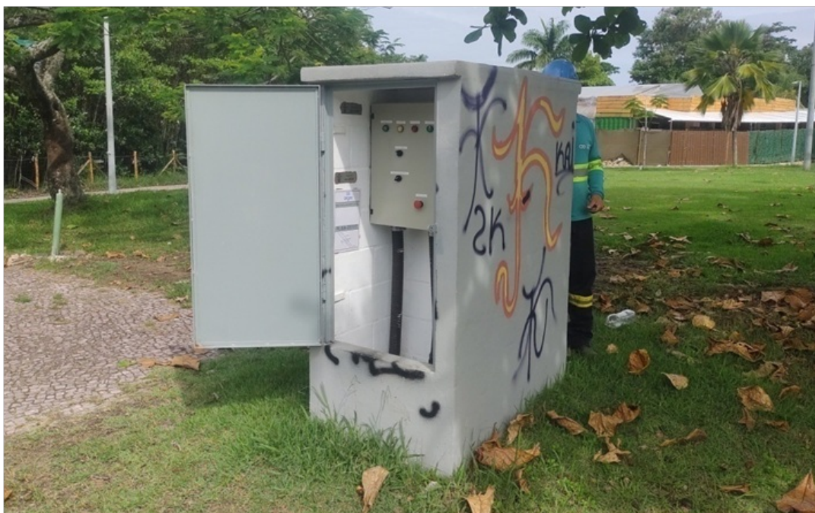
Foto 4 - Painél Elétrico em abrigo com bom estado de conservação.
