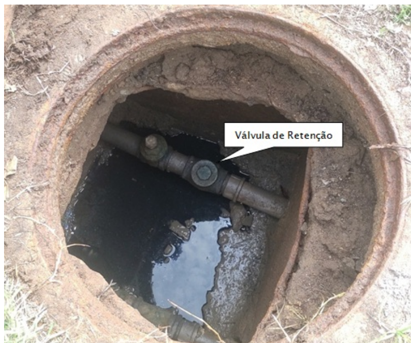
Foto 3 - Barrilete onde está localizada a válvula de retenção.
