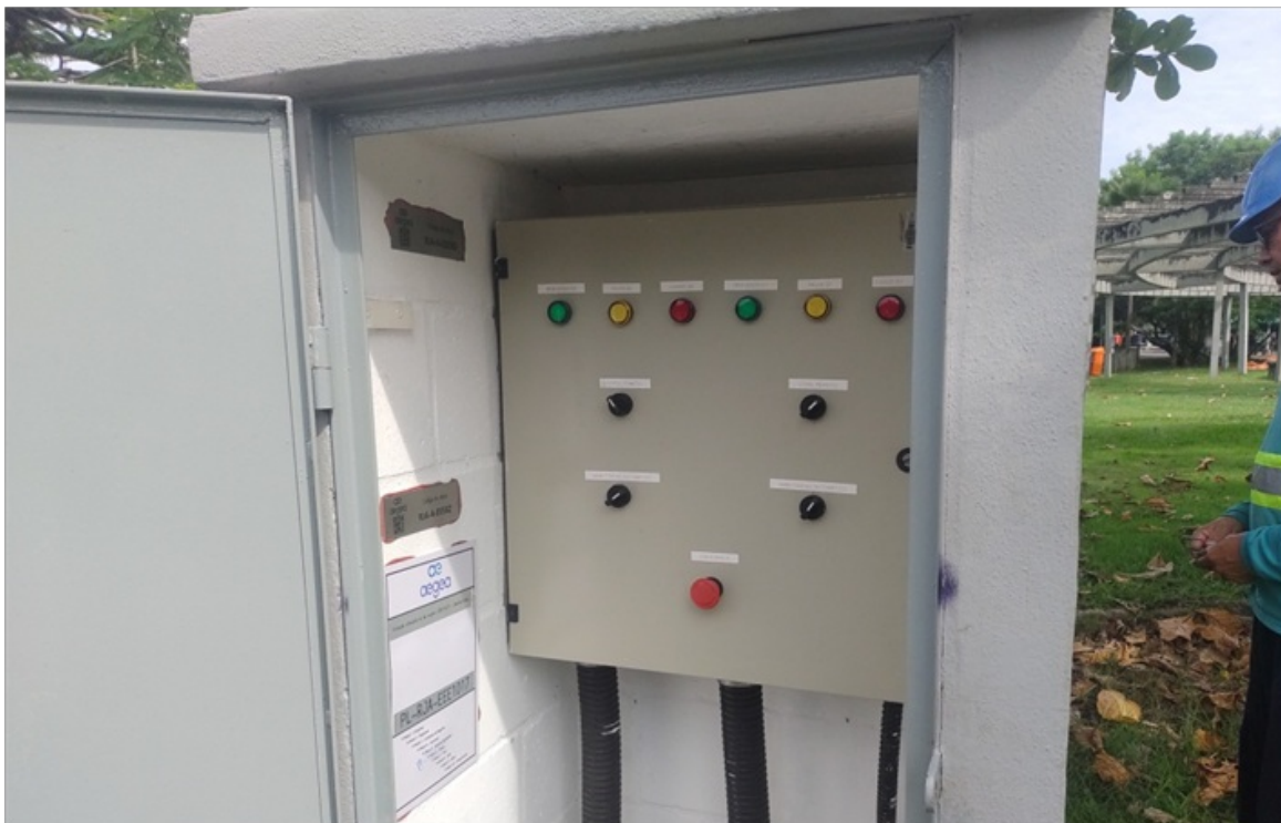
Foto 5 - Painél Elétrico sem sinalização de risco de choque elétrico.
