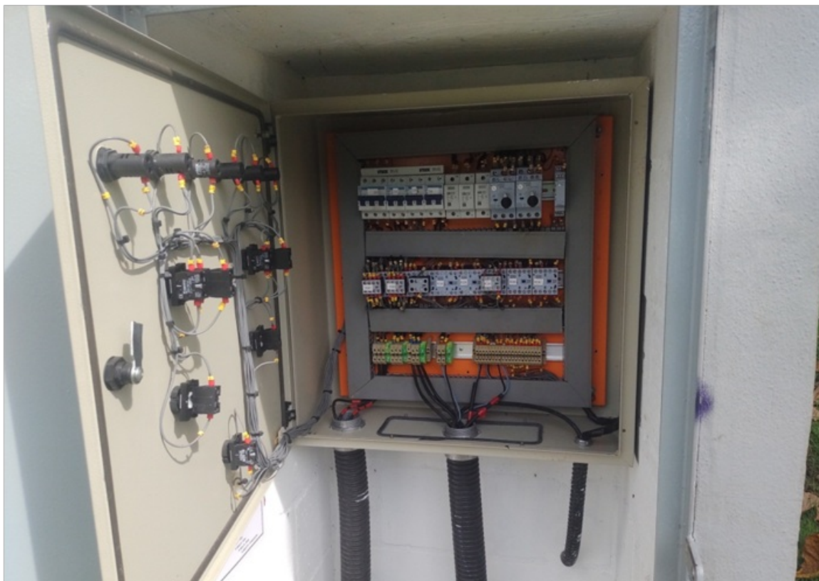
Foto 6 - Painél de comando elétrico.
