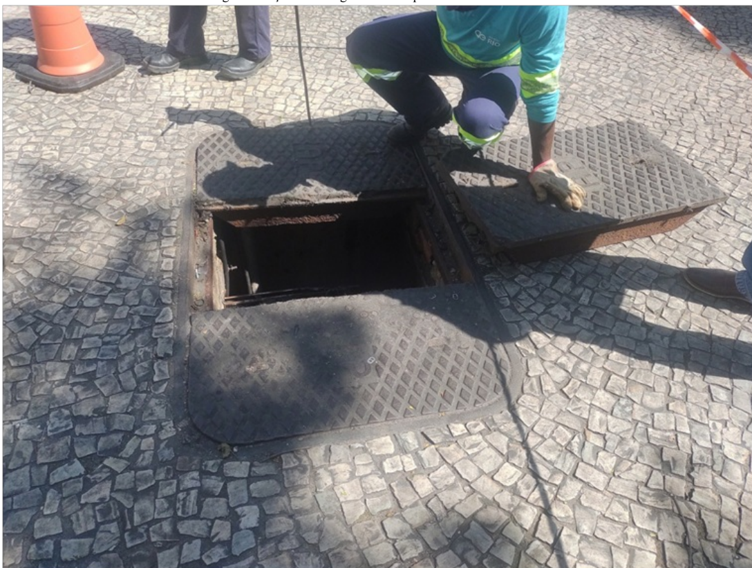
Figura 4 – Abertura do acesso ao poço de sucção onde estão localizados os conjuntos motobombas submersíveis.
