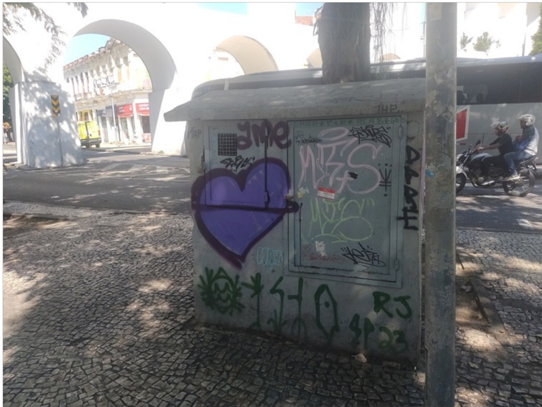
Figura 6 – Abrigo do painel de comando elétrico.
