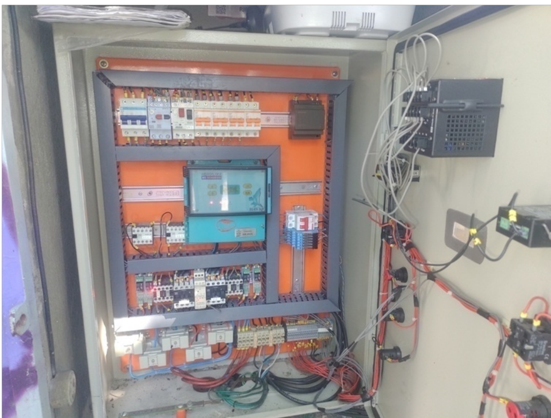
Figura 8 – Painel de comando elétrico com a porta aberta
