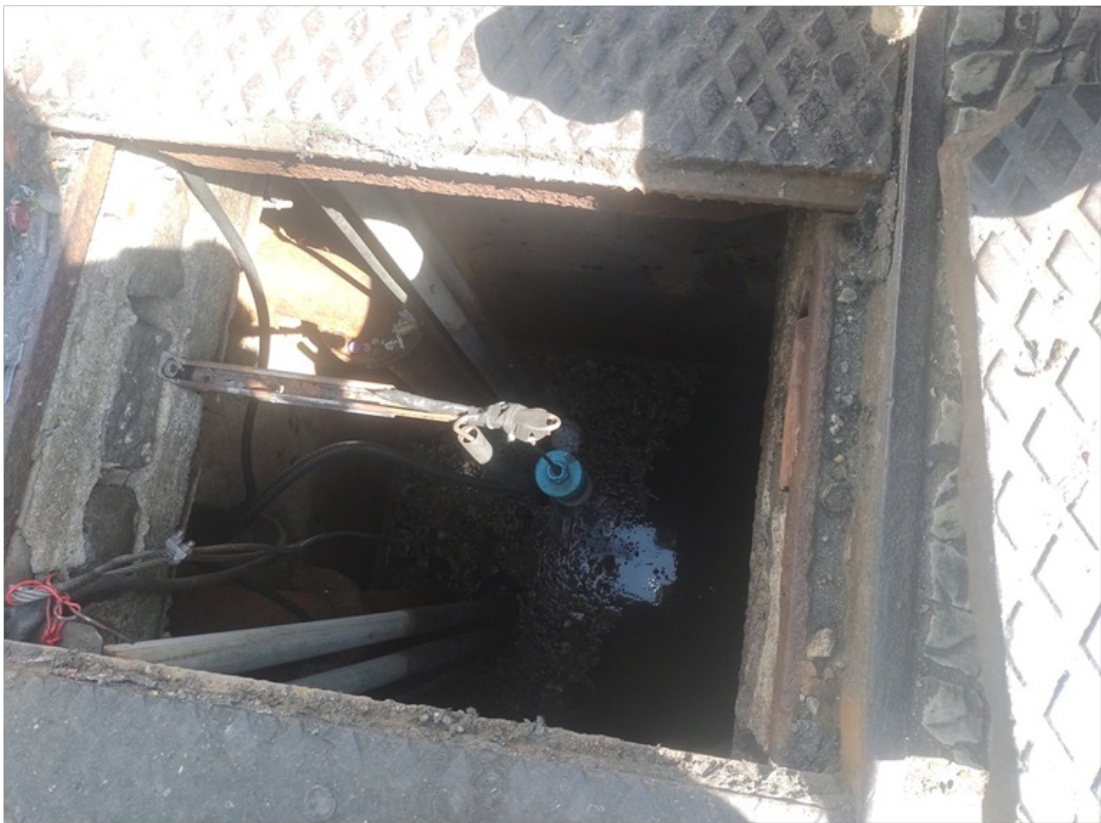
Figura 5 - Poço de sucção com monitoramento eletrônico do nível do efluente.
