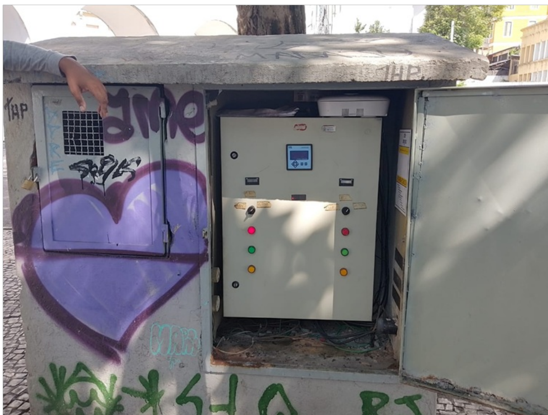
Figura 7 – À esquerda portinhola onde está abrigado o medidor de energia elétrica e à direita o painel elétrico.
