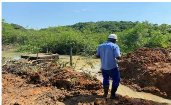
Foto 2 - Local da ocorrência do vazamento de água em Deodoro.
