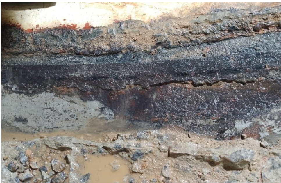
Foto 6 - Identificação do local do vazamento no interior da tubulação
