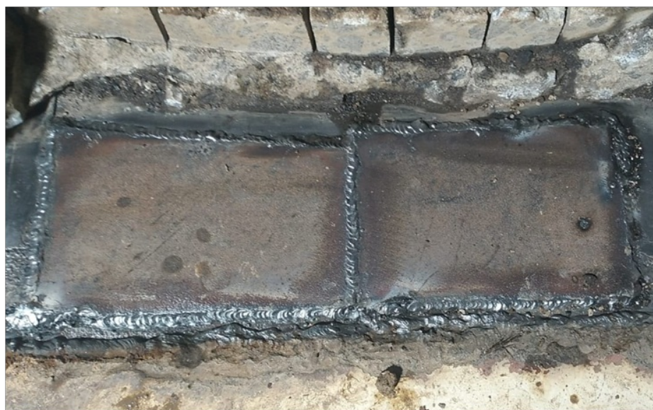
Foto 7 - Reparo realizado com solda em chapa no local do vazamento
