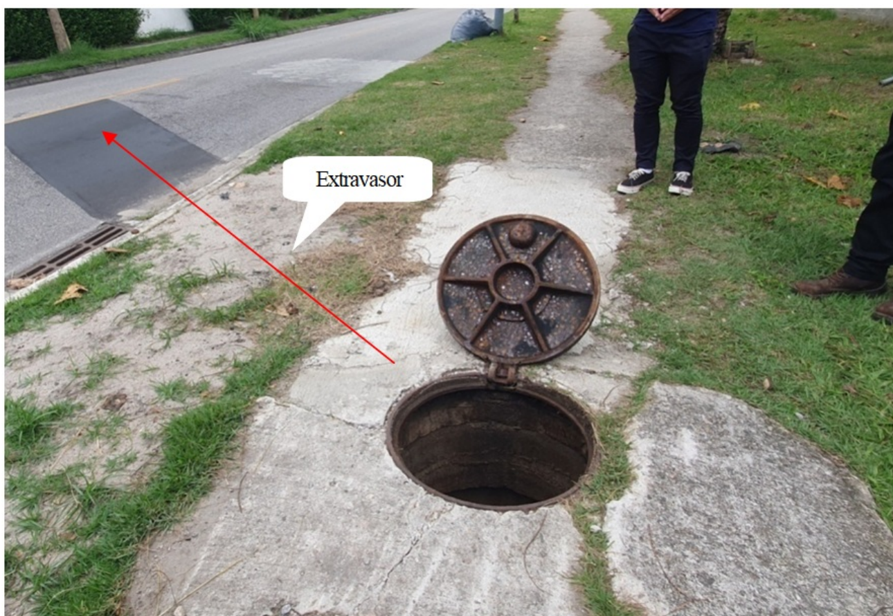
Foto 7 - Terceiro PV encontrado na rua lateral ao condomínio.
