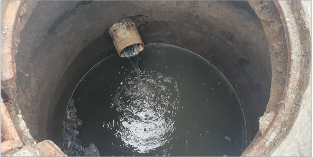
Foto 10 - Efluentes em fluxo de chegada ao quarto PV.
