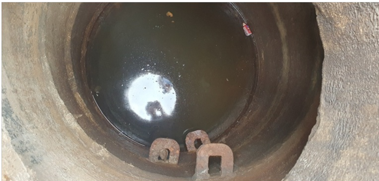
Foto 6 - Segundo PV encontrado na esquina próxima ao condomínio.
