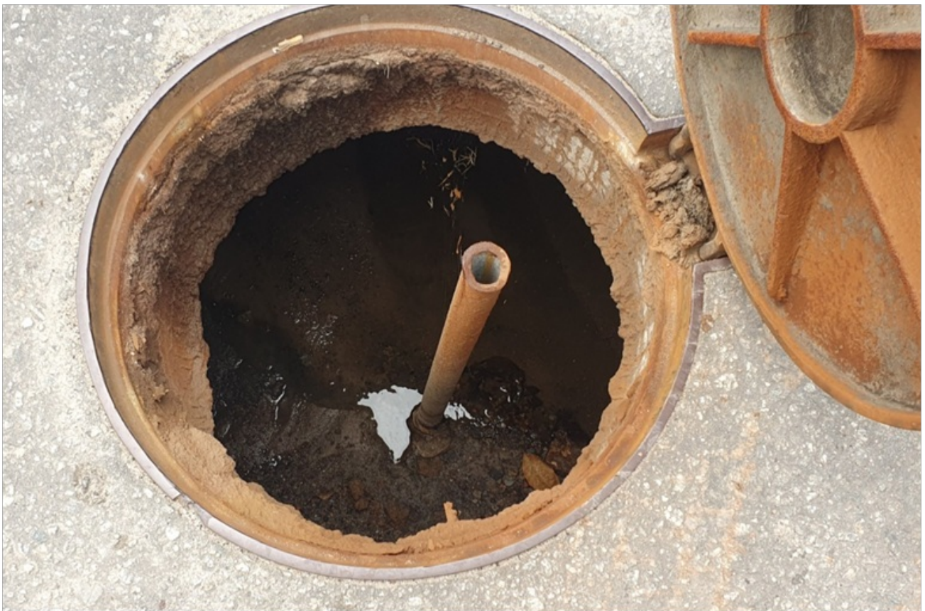
Foto 12 – Galeria de águas pluviais onde deságua a rede coletora.
