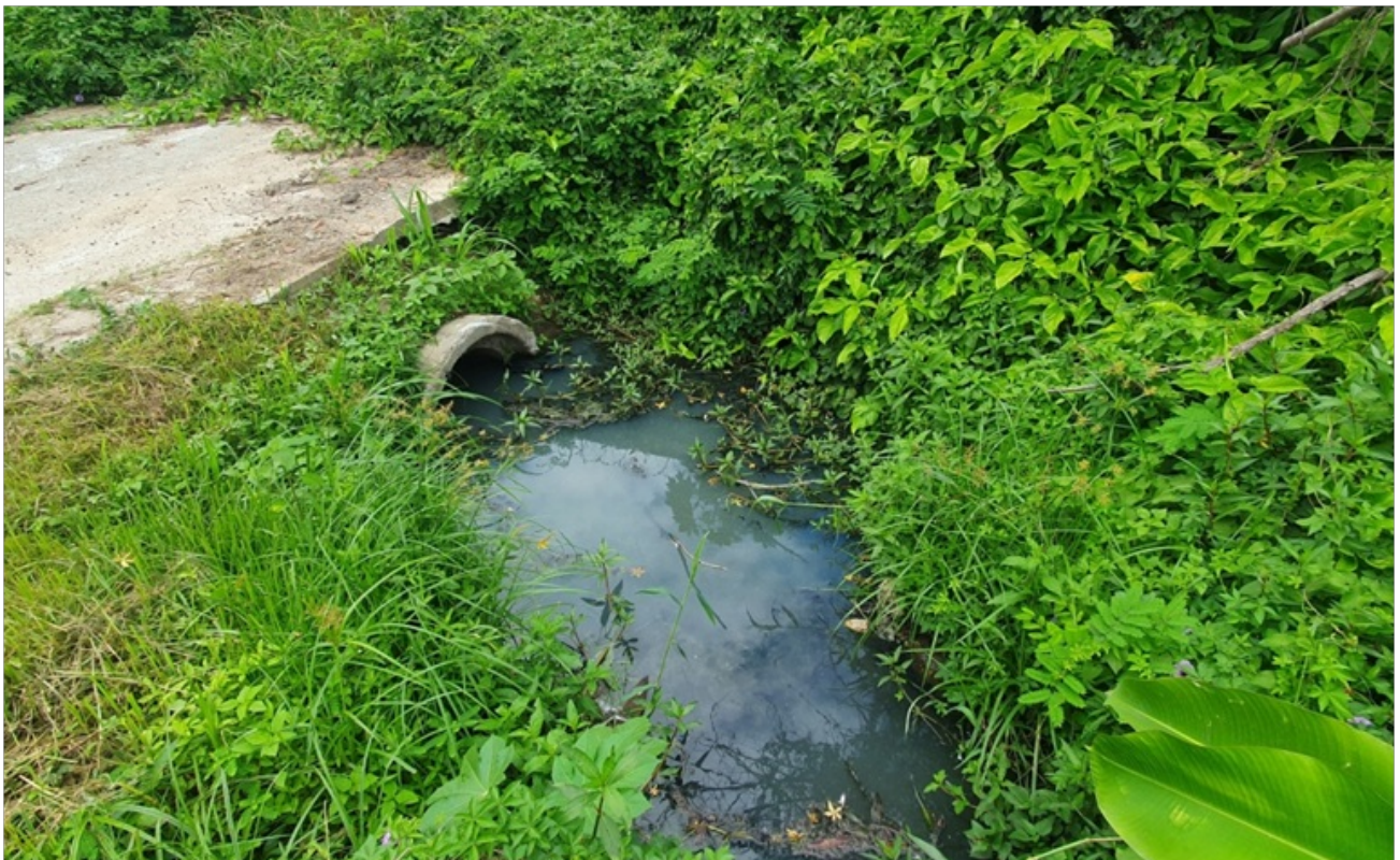
Foto 13 - Vala com indícios de esgoto a céu aberto, encontrada na rua atrás do condomínio
