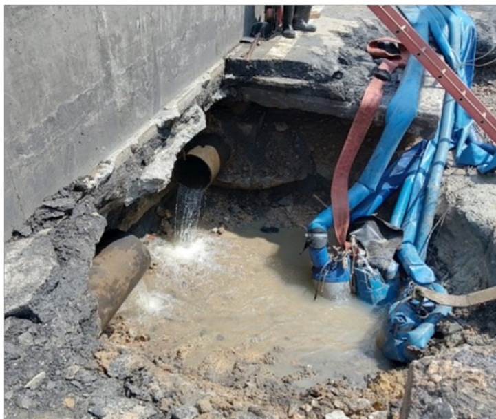
Foto 3- Local do rompimento tubulação DN 400 mm.
