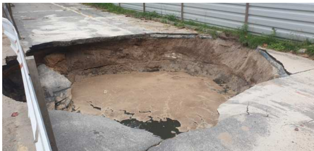
Figura 11 – "Cratera" aberta pelo vazamento de esgotos - 1º colapso vistoriado (30/12/23)
