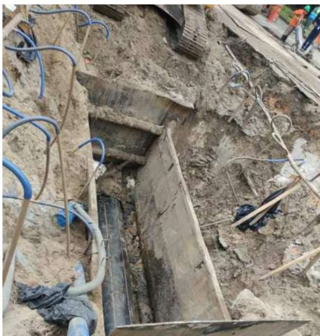
Figura 16 – Tubo de PEAD DE 1000mm inserido dentro do concreto no 1º trecho colapsado (1/1/24)
