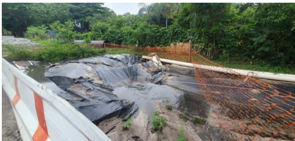
Figura 13 – Vazamento do 2º colapso vistoriado (2/1/24) do coletor tronco Novo Leblon
