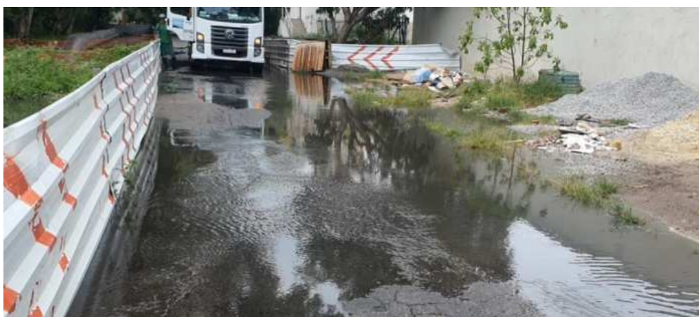
Figura 5 – Esgotamento do vazamento na Av. Pref. Dulcídio Cardoso com Caminhão limpa-fossa (30/12/23)
