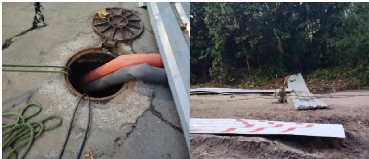
Figura 6 – Esgotamento provisório dos esgotos brutos para a Lagoa Marapendi até consertar os tubos existentes
