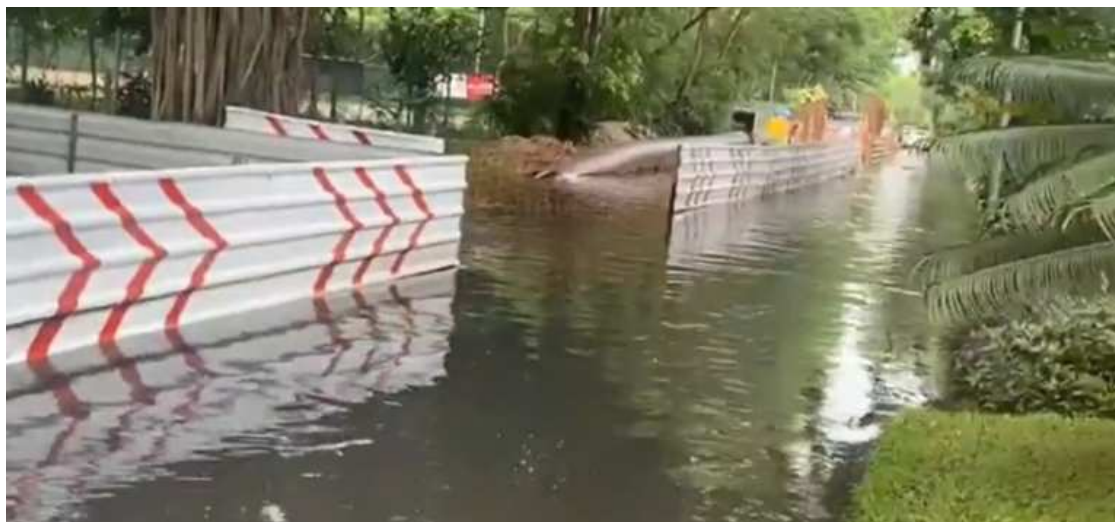
Figura 2 – Vazamento de esgotos brutos na Av. Pref. Dulcídio Cardoso (30/12/23)
