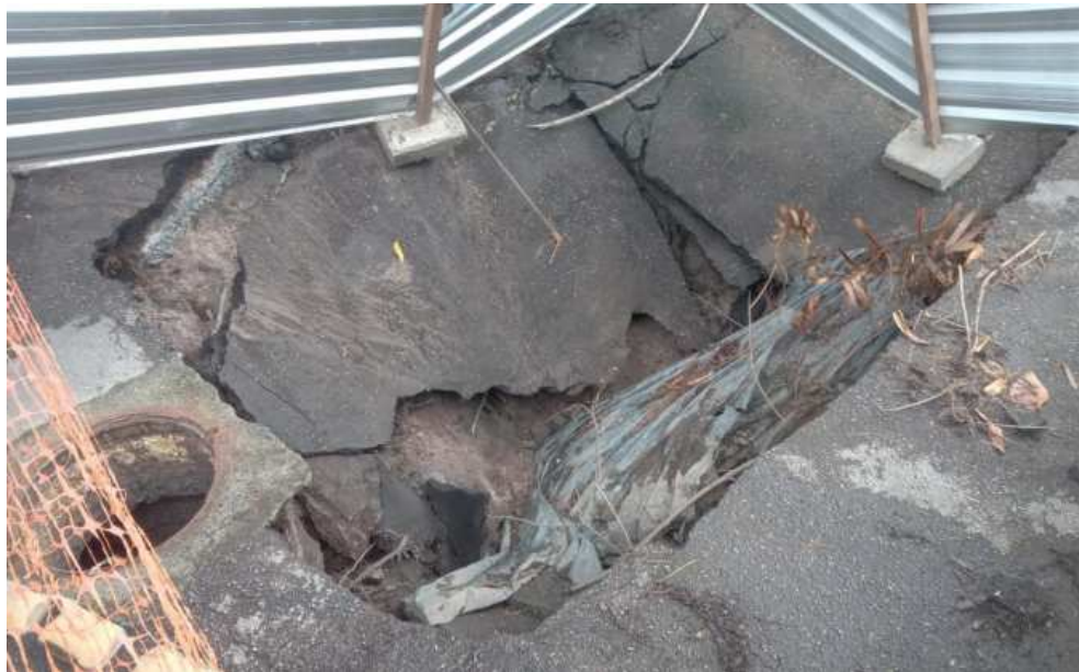
Figura 12 – Local do 2º colapso vistoriado (2/1/24) do coletor tronco Novo Leblon
