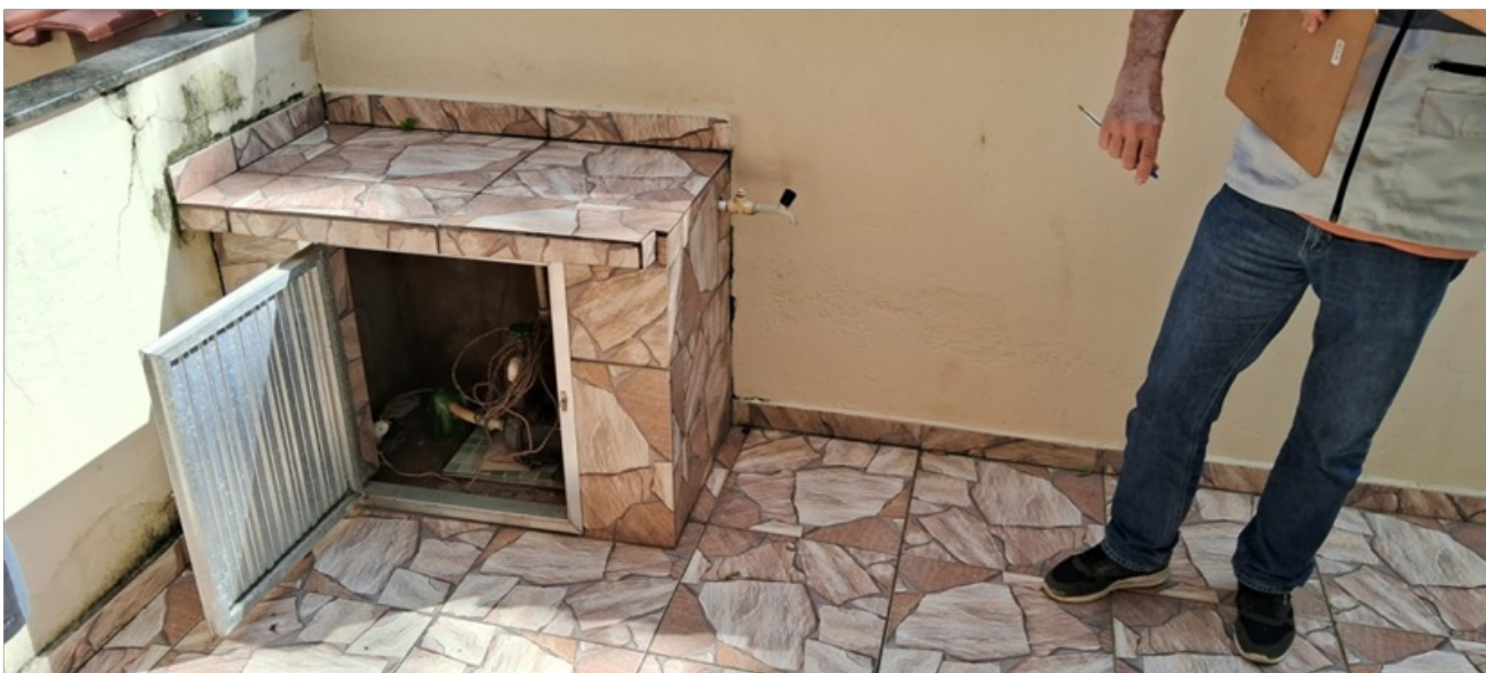
Foto 7 – Bomba conectada ao reservatório inferior.
