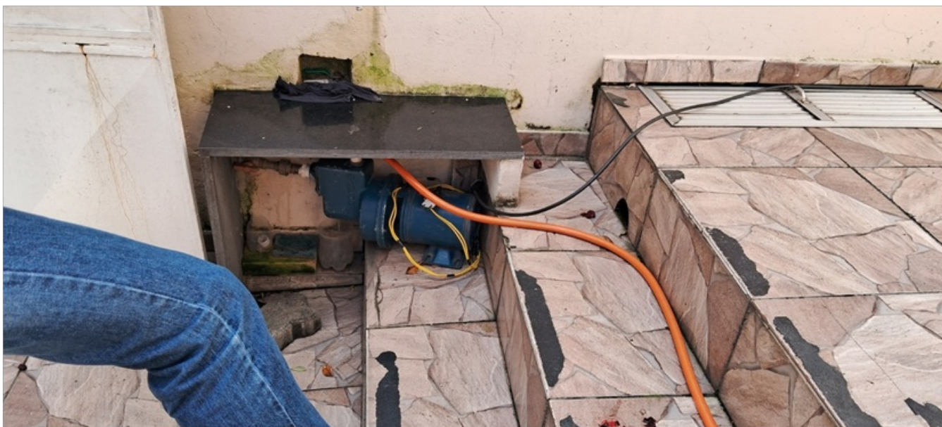
Foto 6 – Bomba conectada à rede pública de abastecimento.
