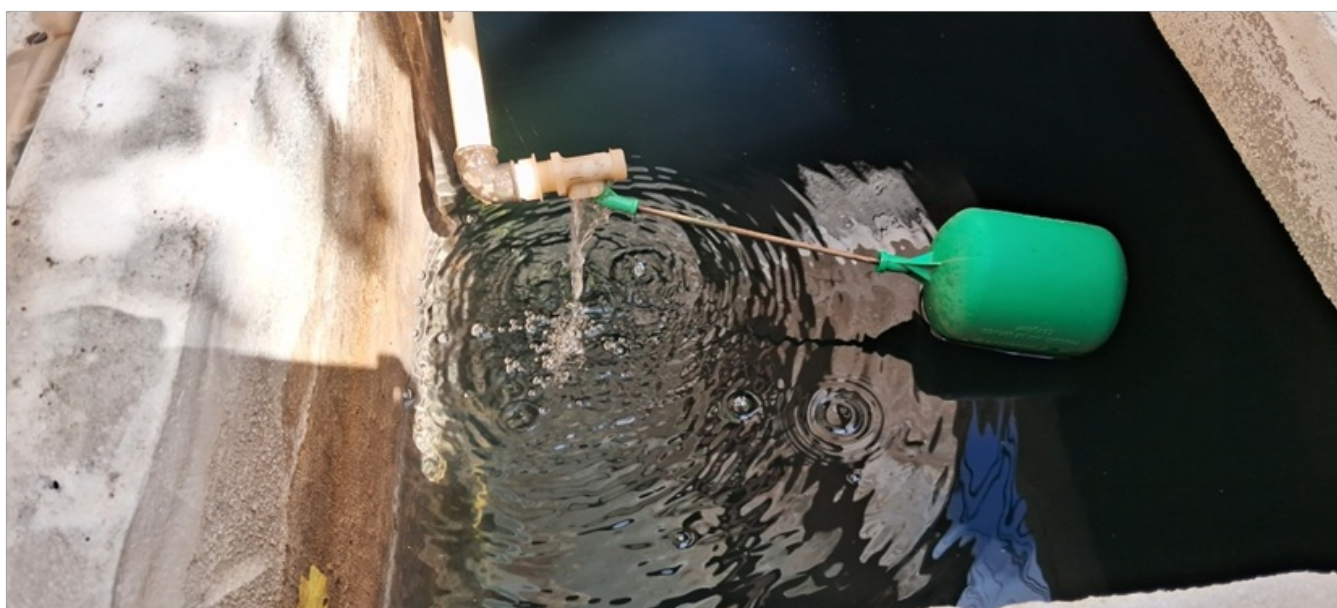
Foto 5 – Reservatório inferior abastecido.
