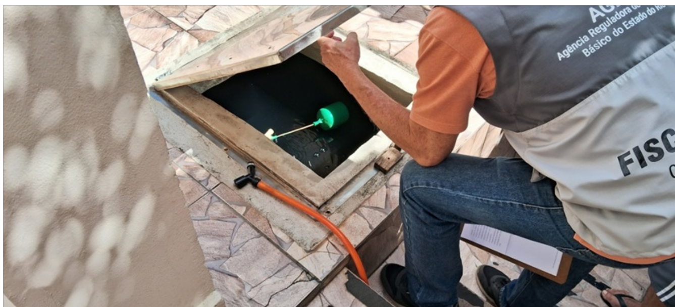
Foto 3 – Reservatório inferior com elevação aproximada de 1 metro em relação ao logradouro.
