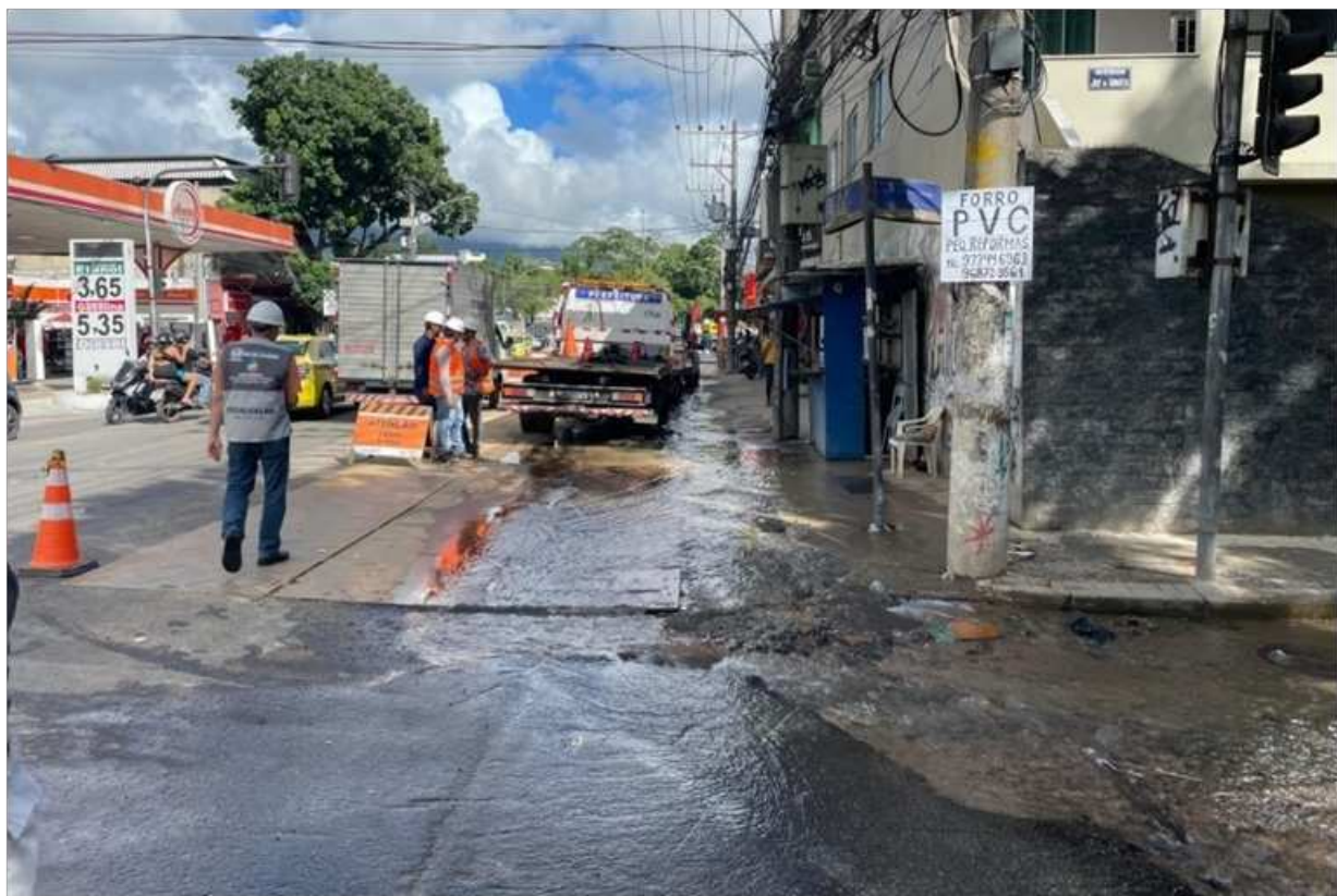
Figura 2 - Água escorrendo pela rua e escoando em um córrego próximo ao local
