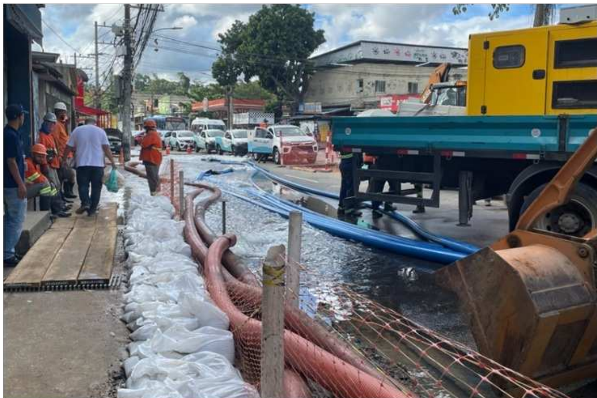
Figura 3 - Água escoando pela rua, próximo a calçada. Concessionária providenciou barreira com sacos de areia para proteção da calçada e pedestres que transitavam no local
