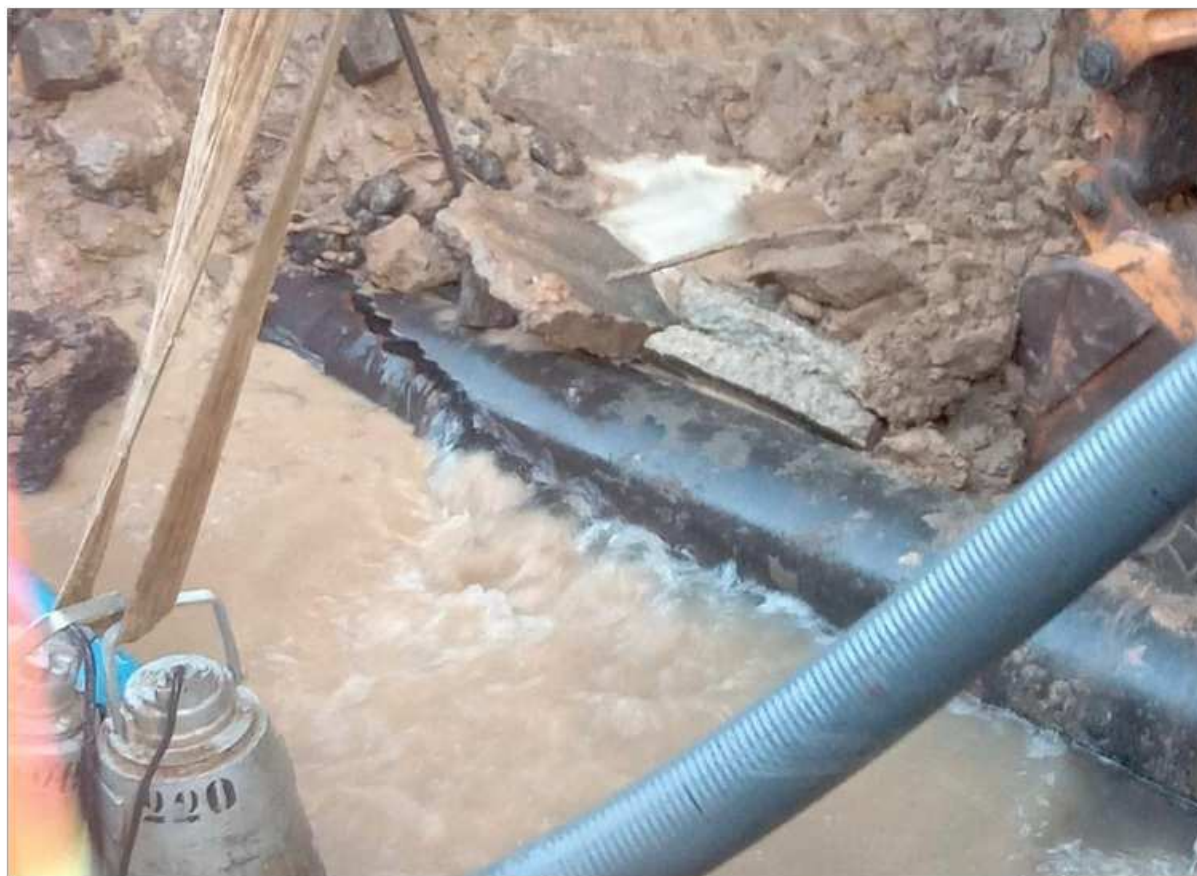
Figura 12 - Depois de esgotada quase toda água, foi possível verificar o tipo de rompimento e o diâmetro da tubulação (400 mm)
