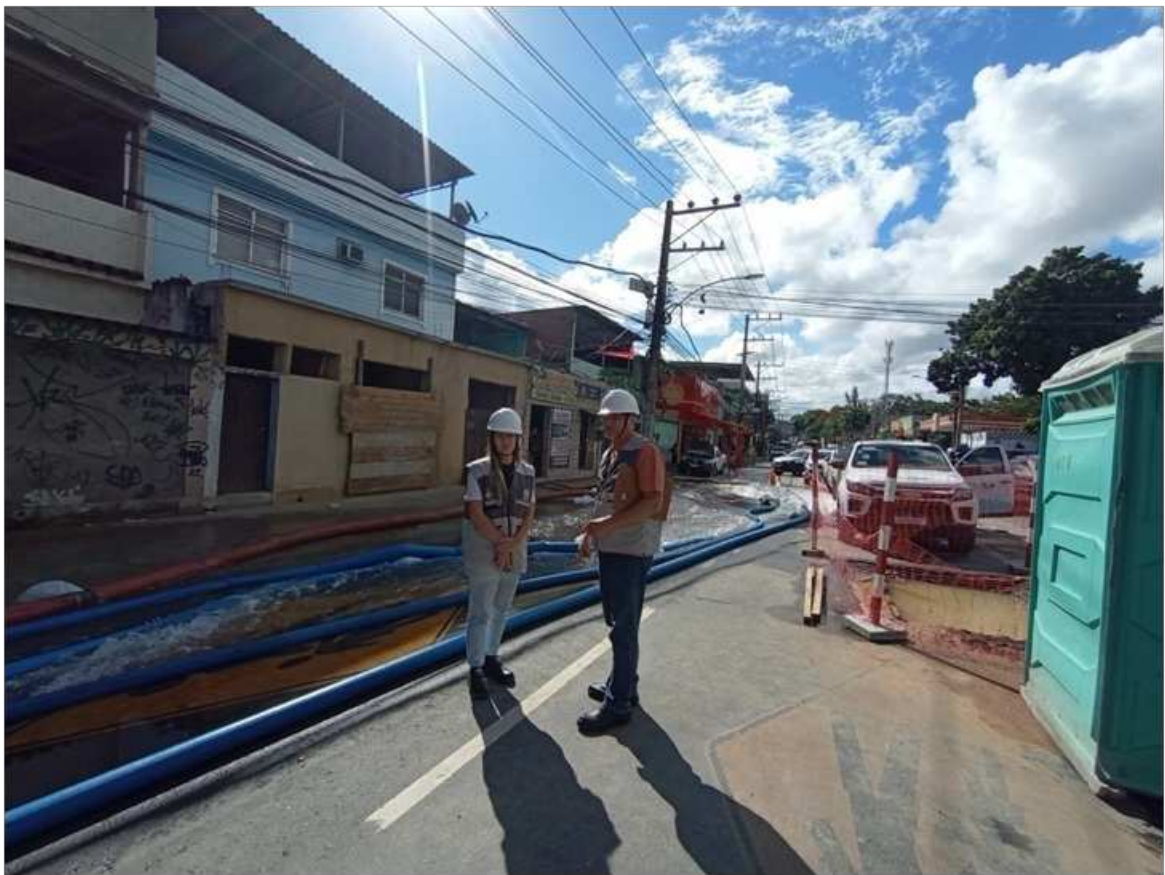
Figura 5 - Equipe da AGENERSA após a chegada ao local realizando o apanhado geral da situação do rompimento
