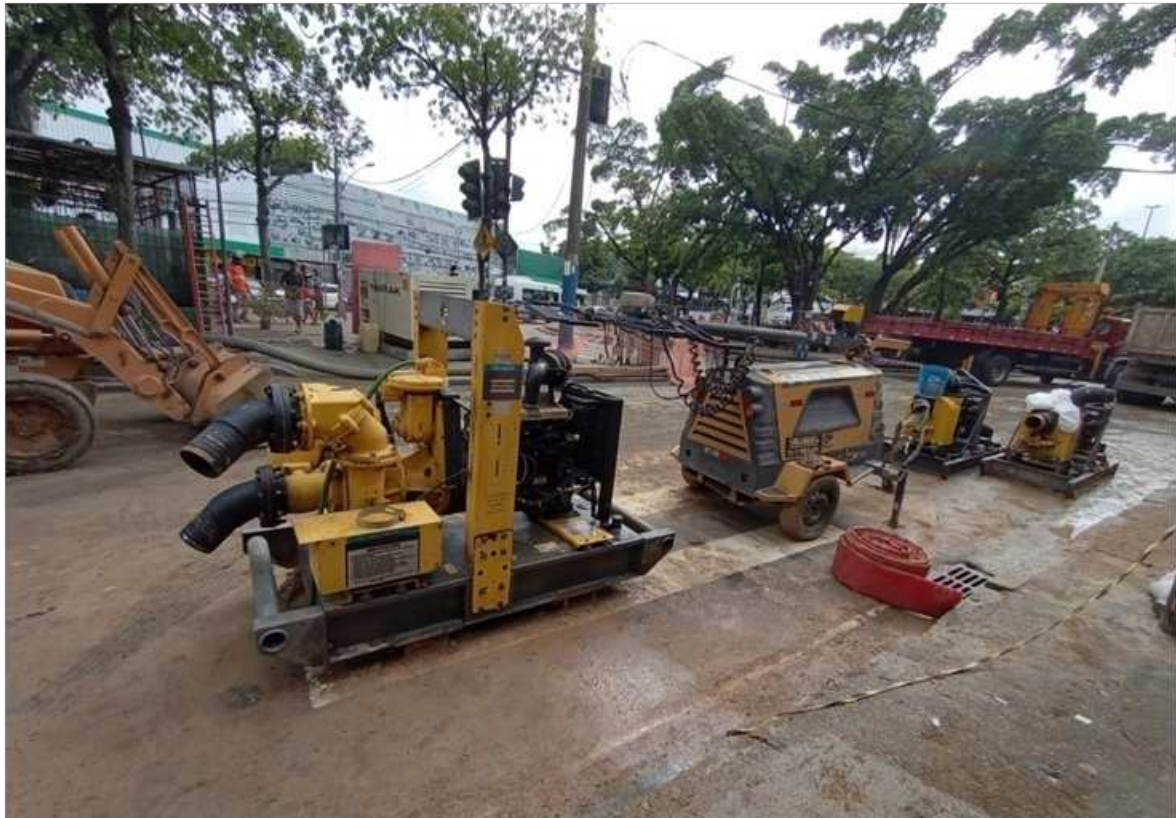
Figura 15- Grande quantidade de equipamentos ainda presentes no local (bombas, compressor, retro escavadeira, caminhão munk)
