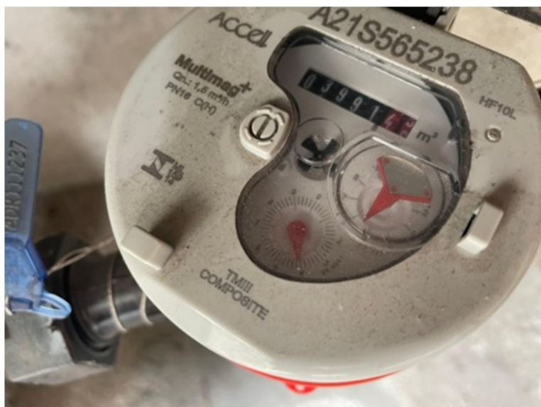
Foto 3 – Leitura do volume registrada no hidrômetro.
