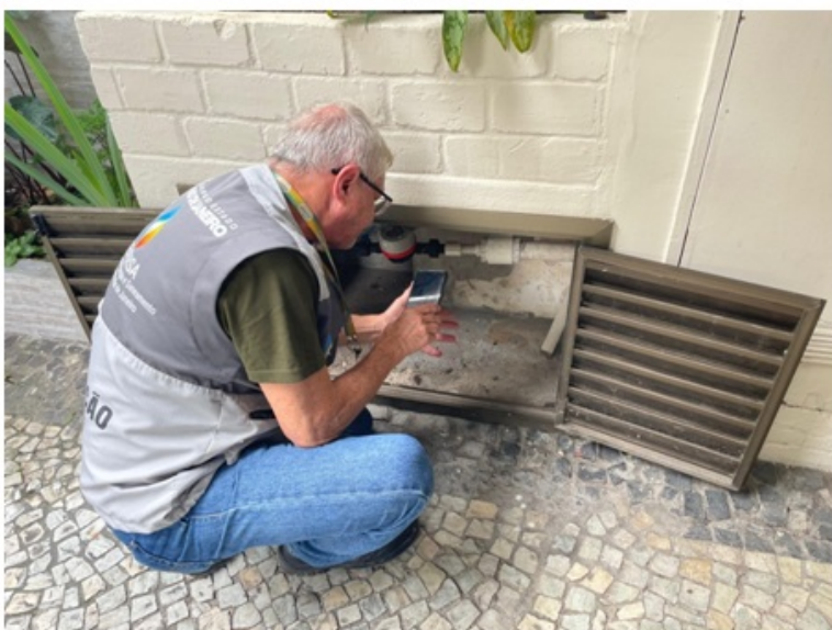
Foto 12 – Acessibilidade ao hidrômetro.
