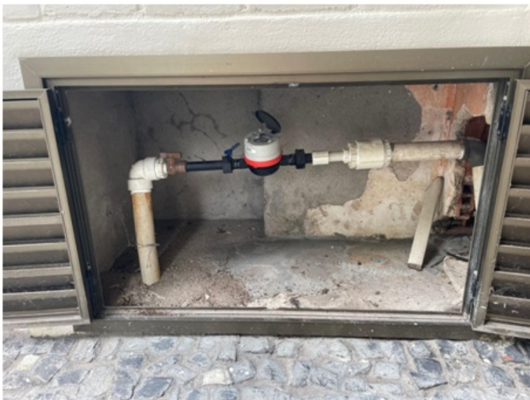
Foto 11 – Abrigo do hidrômetro.
