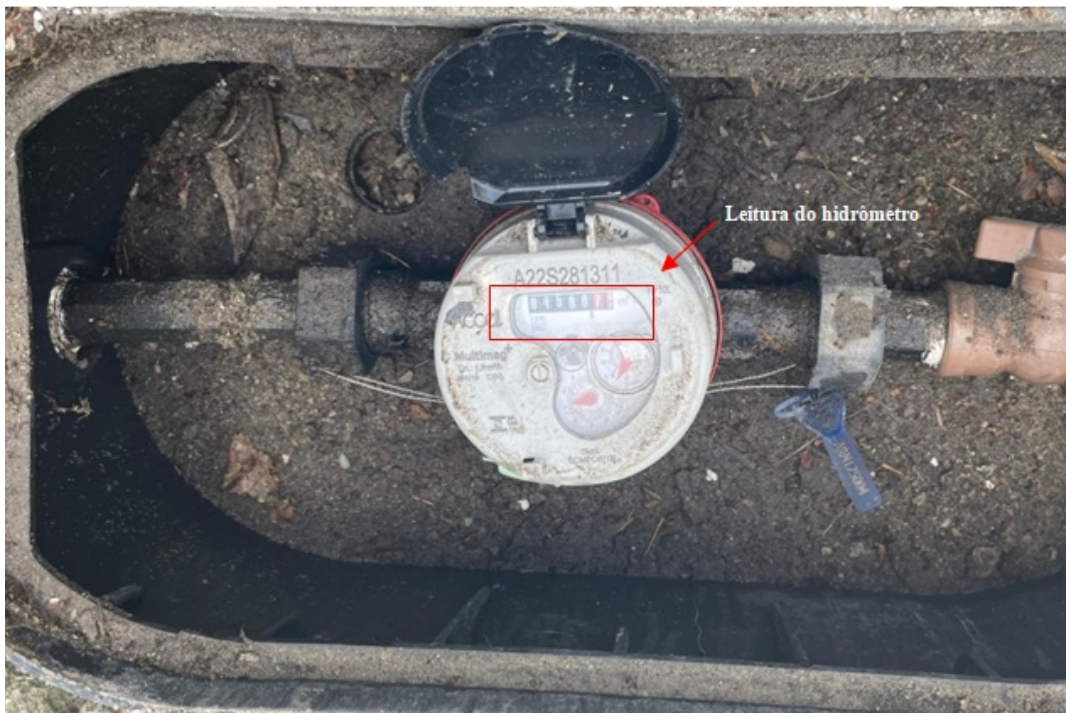
Foto 5 - Leitura do volume registrada no hidrômetro no momento da vistoria.
