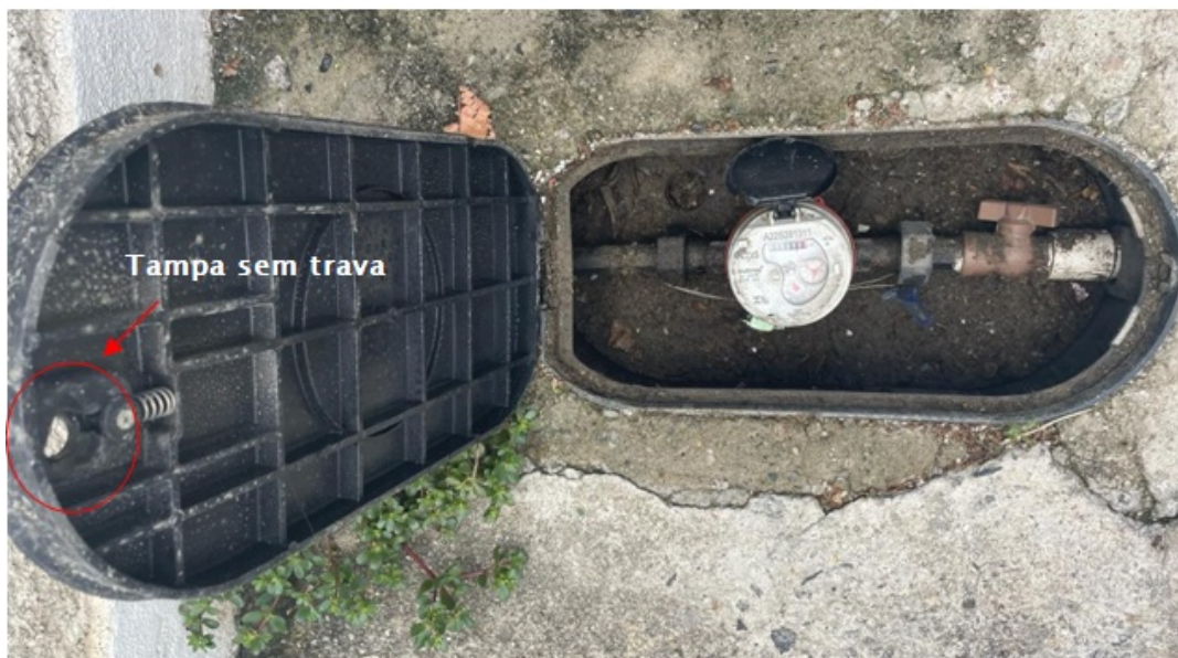
Foto 3 - Abrigo do hidrômetro com tampa, mas sem trava.
