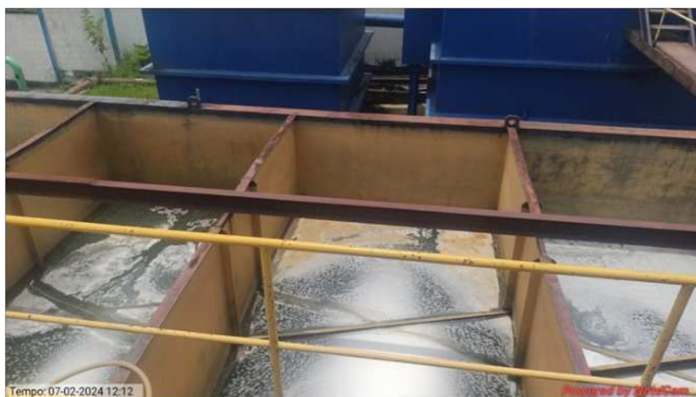
Foto 17 – Tanque de filtragem
