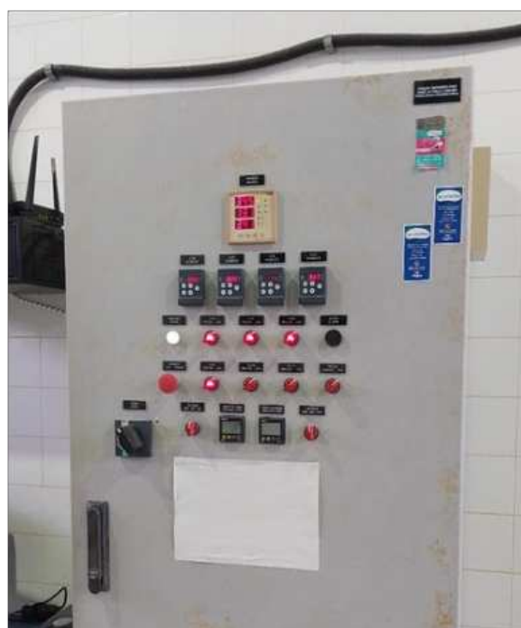
Foto 14 – Quadro de comando Foto
