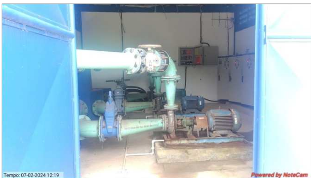
Foto 19 – Estação elevatória de água
