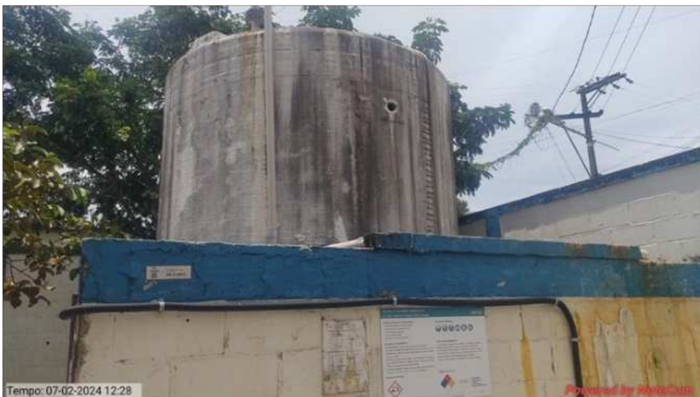
Foto 27 – Tanque de sulfato de alumínio
