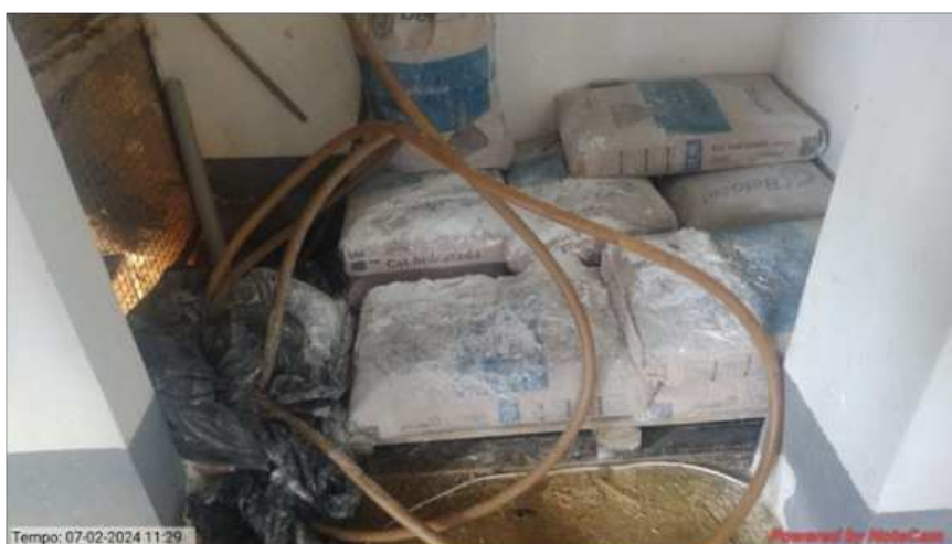
Foto 7 – Armazenamento de Cal hidratada
