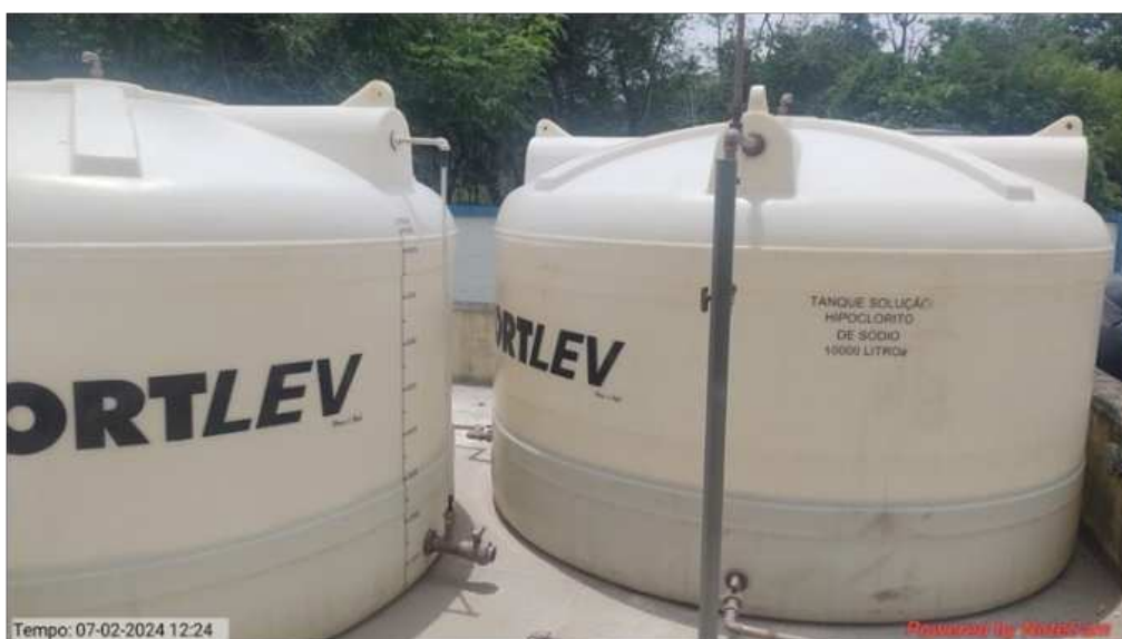
Foto 26 – Tanque de hipoclorito de sódio
