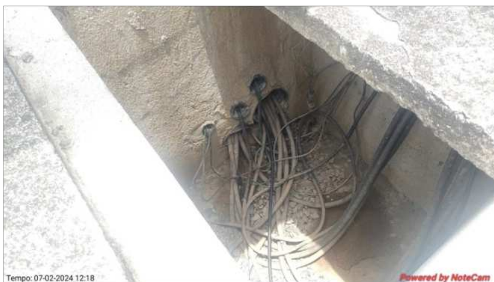
Foto 22 – Caixa de passagem elétrica
