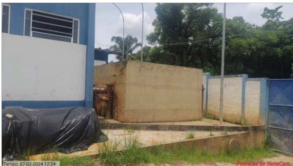
Foto 21 – Tanque de lodo
