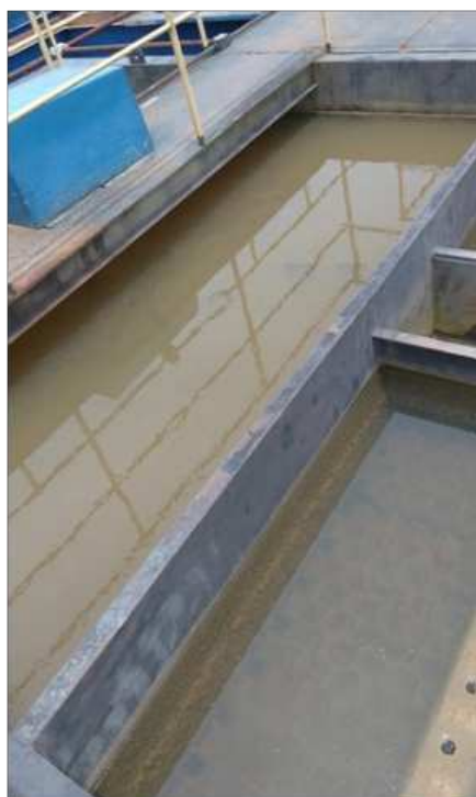
15 – Tanque de floculação ETA 1
