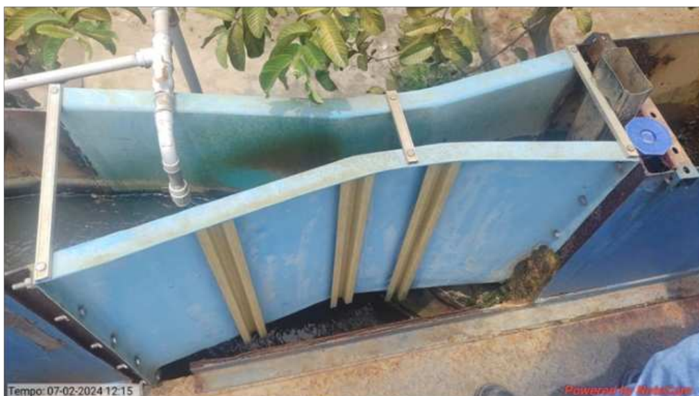
Foto 18 – Calha Pharshal águas brutas
