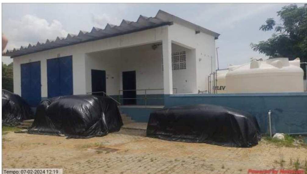
Foto 23 – Galpão geração de hipoclorito de sódio
