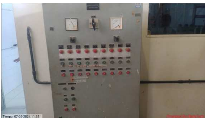
Foto 10 – Quadro de comando
