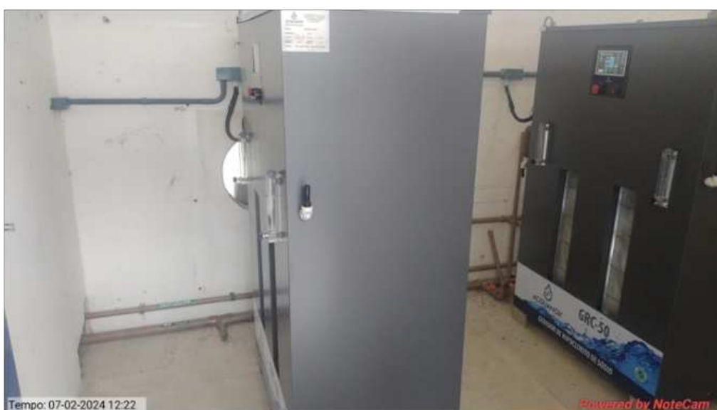
Foto 25 – Gerador de hipoclorito de sódio
