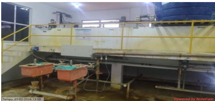
Foto 17 - Vista da sala de mistura de produtos químicos.
