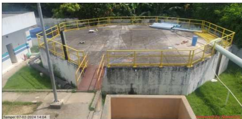
Foto 7 - Reservatório da ETA Manilha.
