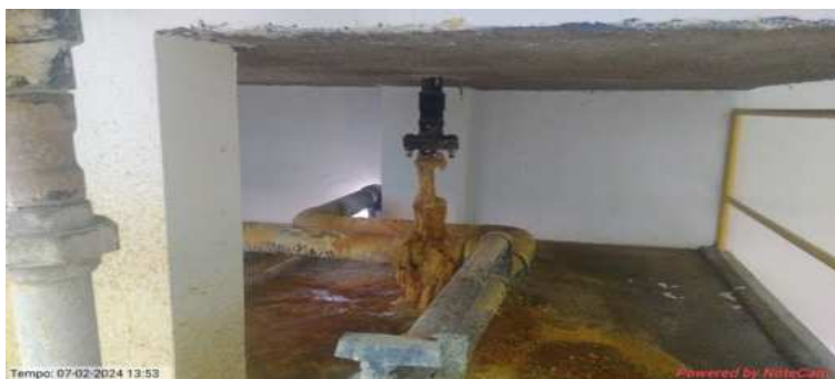
Foto 15- tubulação com excesso de sujidades.
