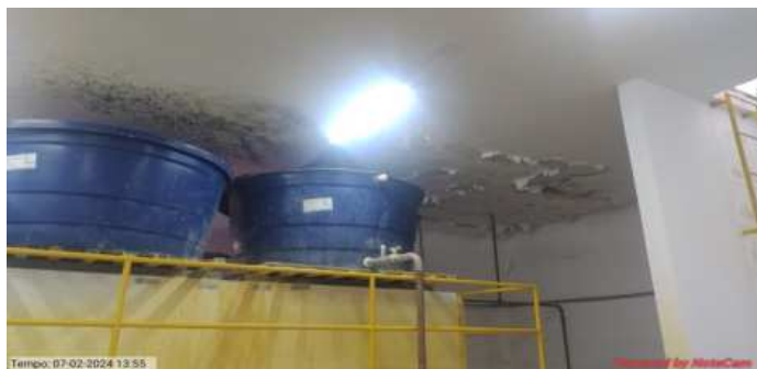
Foto 18 - Sala de mistura de produtos químicos.
