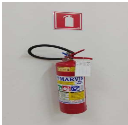
Foto 13 – Equipamento instalado de acordo com o código de segurança contra incêndio e pânico.
