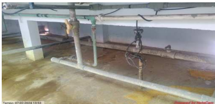
Foto 16– Tubulações com excesso de sujidades.
