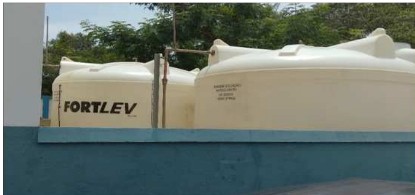
Foto 3 – Tanques de armazenagem de hipoclorito de sódio.
