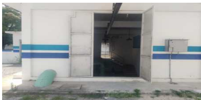
Foto 26- Casa de bombas da estação elevatória.
