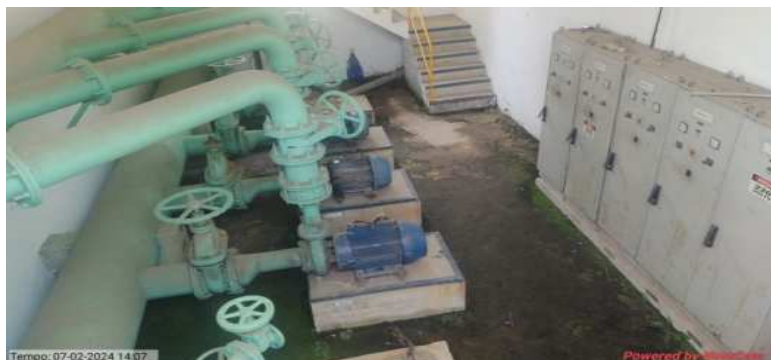
Foto 28 - Conjuntos motobomba de eixo horizontal.
