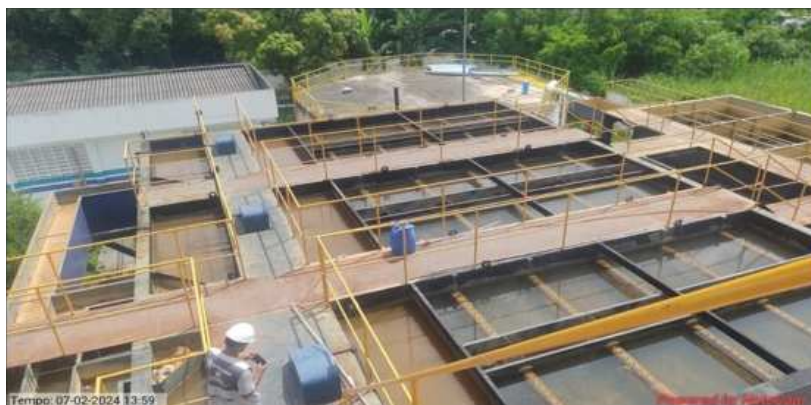
Foto 5 – Módulos da estação de tratamento de água.
