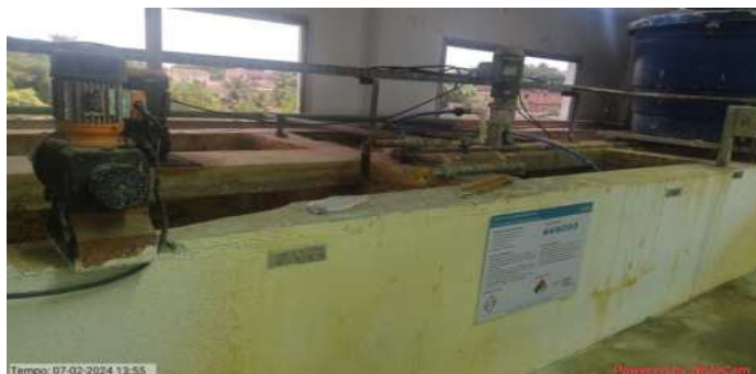
Foto 19 – Sala de preparação de Sulfato de Alumínio.
