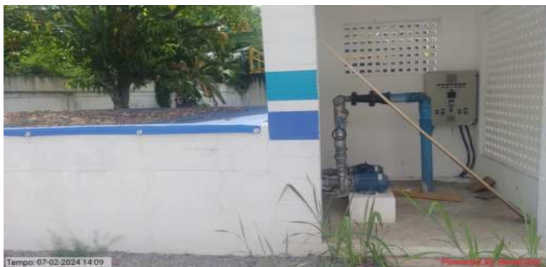
Foto 27 - PAINEL de controle e conjunto motobomba.
