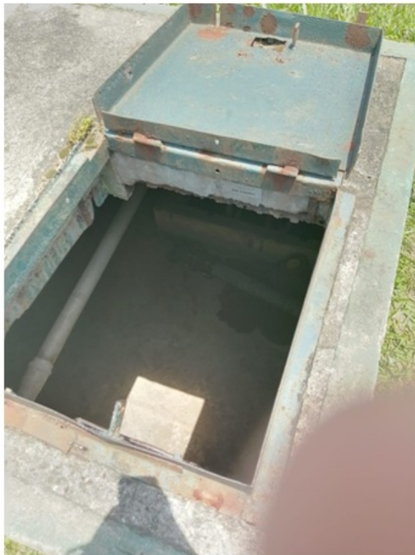
Foto 8 – Abrigo subterrâneo da motobomba e do painel de controle.
