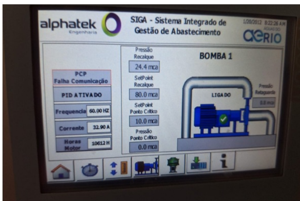
Foto 6 – Display de monitoramento da motobomba .
