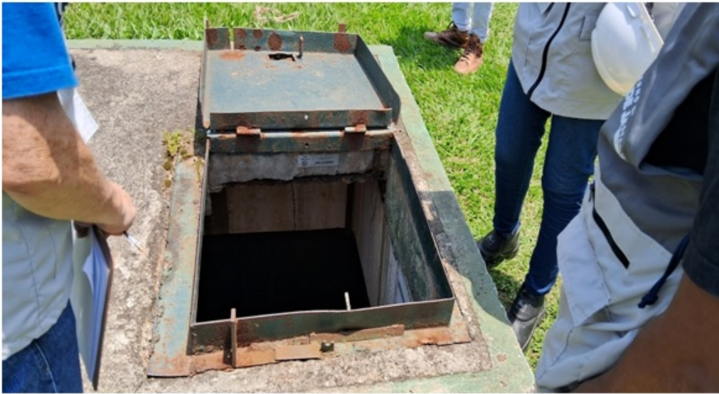
Foto 7 – Abrigo subterrâneo da motobomba e do painel de controle.
