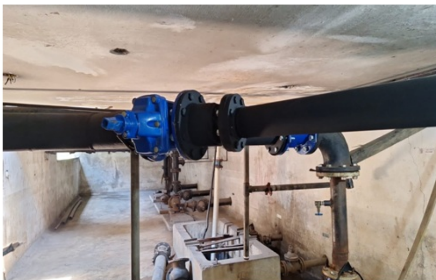
Foto 2 –Conjunto de tubulações e válvulas, ligadas ao recalque da elevatória, no abrigo da elevatória.
