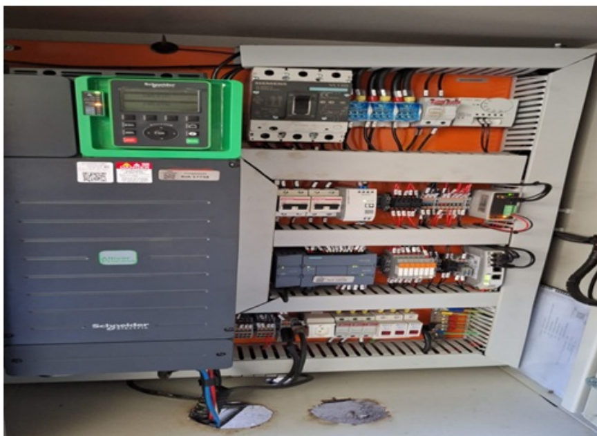
Foto 11 – Painel de controle da motobomba .
