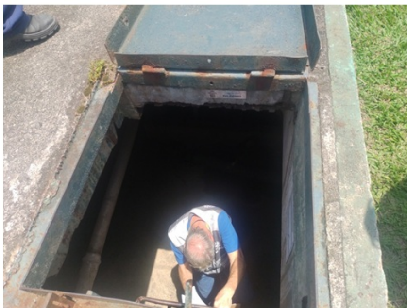
Foto 10 – Abrigo subterrâneo da motobomba e do painel de controle.
