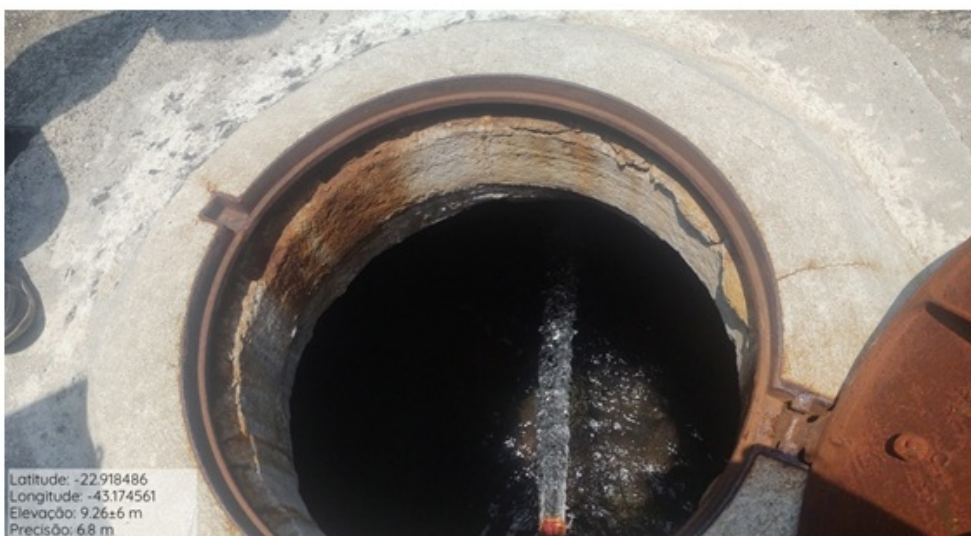
Foto 4 – Cisterna do Aterro sendo abastecida pela elevatória da Praça Paris.
