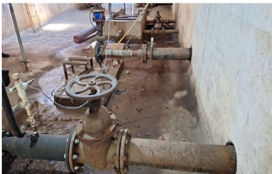
Foto 3 – Tubulação de retaguarda ligada a elevatória.
