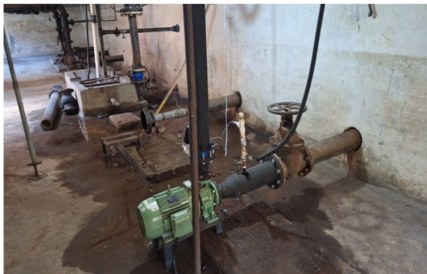
Foto 1 – Conjunto motobomba com tubulação de retaguarda (DN 100 mm), ligada à cisterna do aterro.
