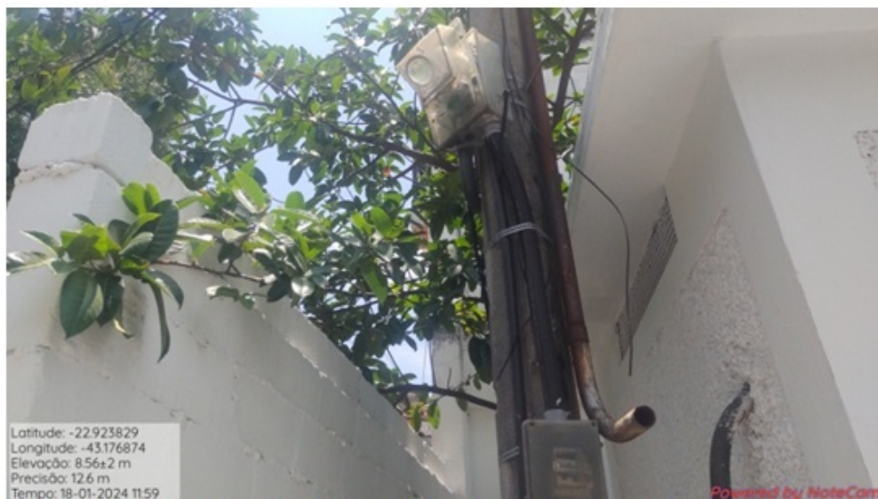
Foto 7 – Medidor do consumo de energia da EEAT, que é responsabilidade da concessionária de energia elétrica.
