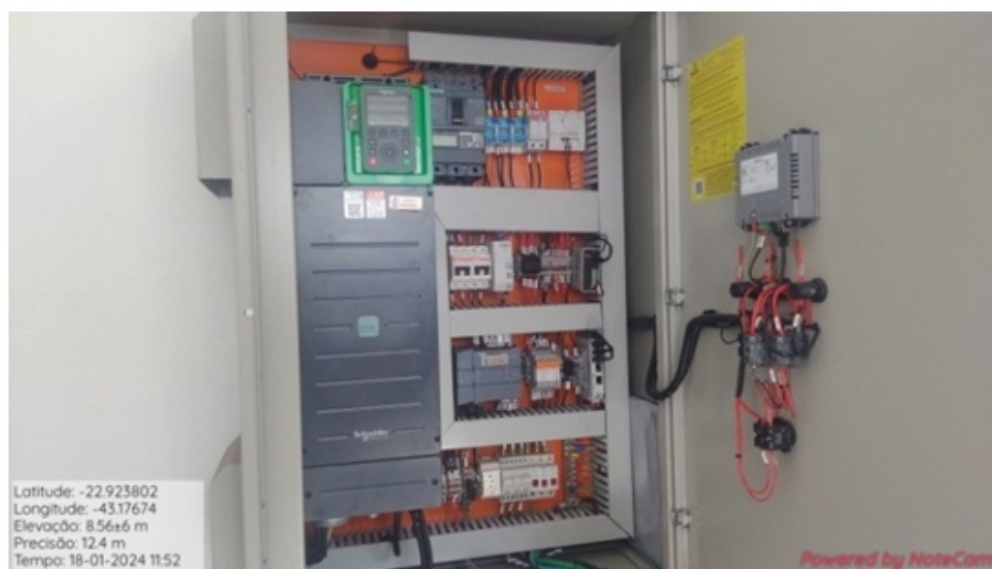
Foto 3 – Painel de controle, aberto, evidenciando os componentes elétricos de proteção e eletrônicos de controle (inversor de frequência e telemetria).
