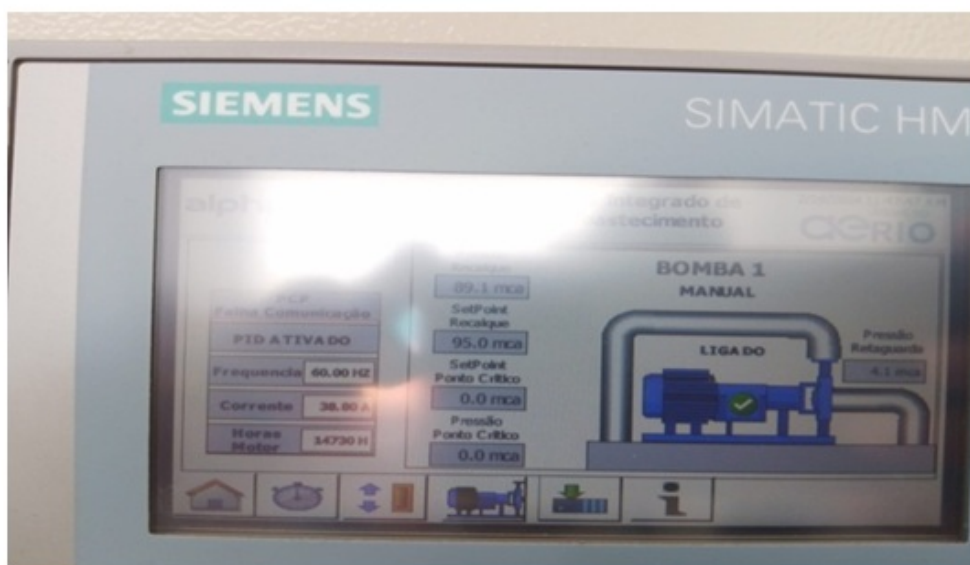
Foto 4 – Display de monitoramento da motobomba.
