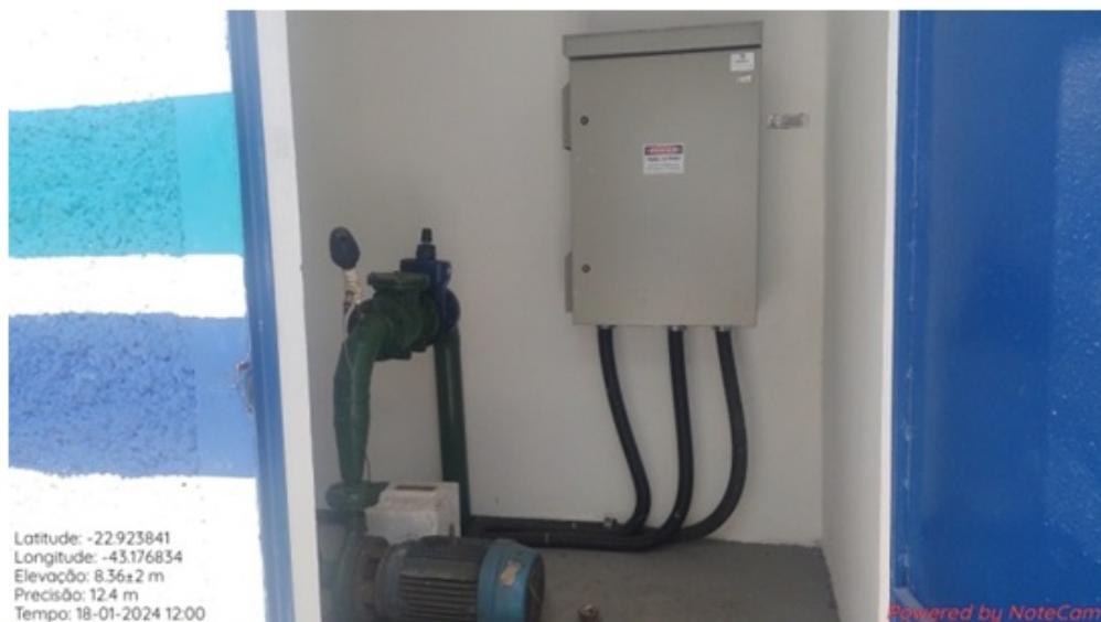
Foto 2 – Painel de controle, conjunto motobomba, cabeamento elétrico protegido com eletrodutos.
