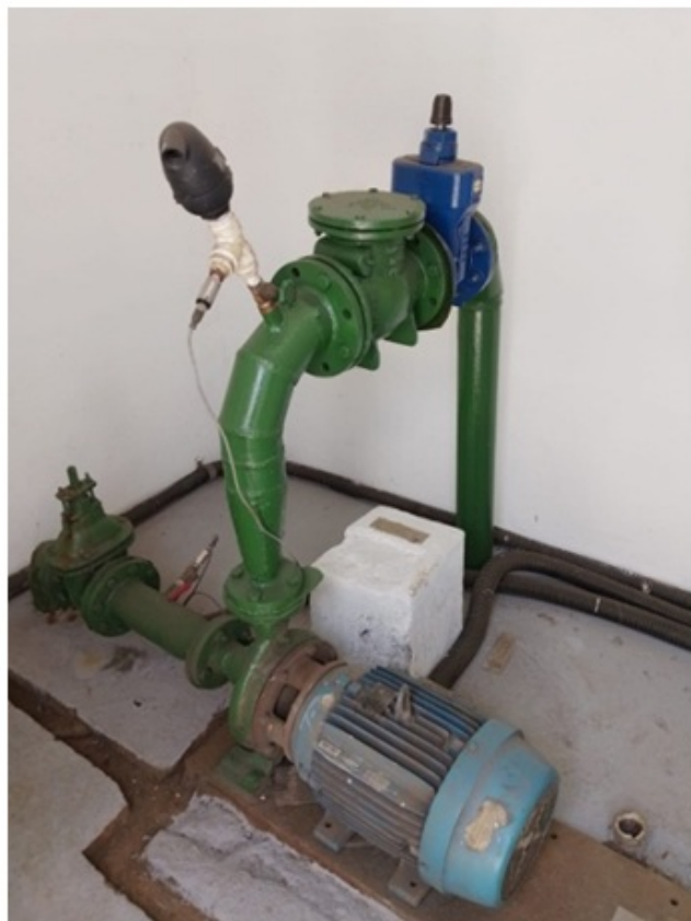
Foto 5 – Conjunto motobomba, tubulação de retaguarda e de recalque dotadas de válvulas.
