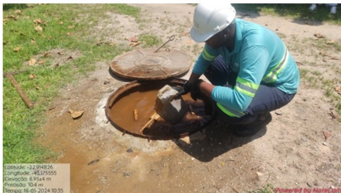
Foto 4 – Abrigo subterrâneo da motobomba sendo esgotado
