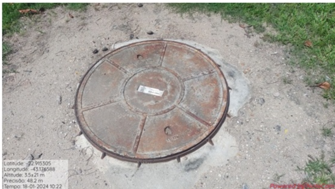
Foto 3 – Abrigo subterrâneo da motobomba
