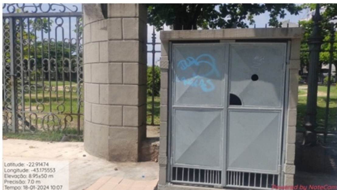
Foto 1 – Abrigo do painel de controle da elevatória
