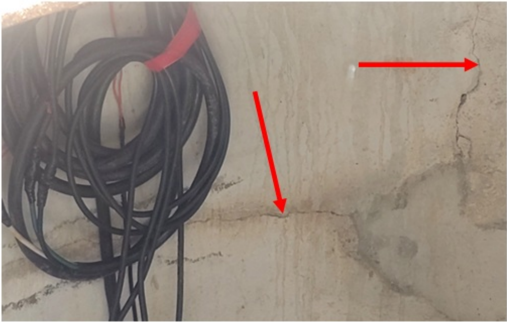
Foto 11 – Parede do abrigo da bomba, destaque para as trincas
