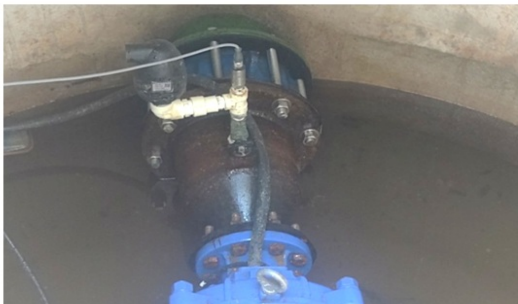
Foto 8 – Tubulação de retaguarda instalada na Motobomba
