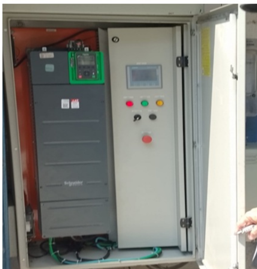
Foto 2 – Painel de controle da elevatória (aberto)
