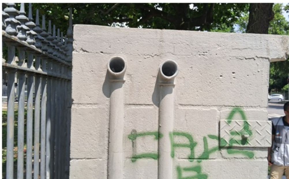
Foto 10 – Dutos de ventilação
