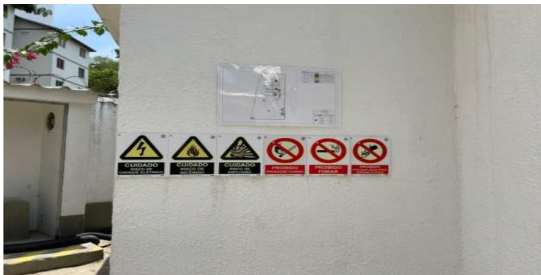
Figura 7 - Mapa de risco e sinalização dos painéis de controle/quadro de força.
