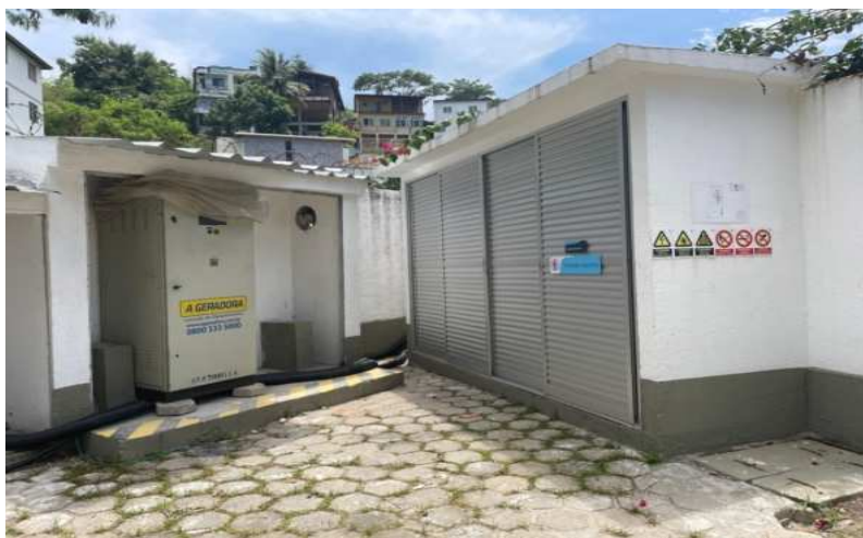
Figura 4 – Abrigo do painel de controle dos conjuntos motobombas e painel de equipamentos elétricos em ótimo estado de conservação e com acesso restrito.
