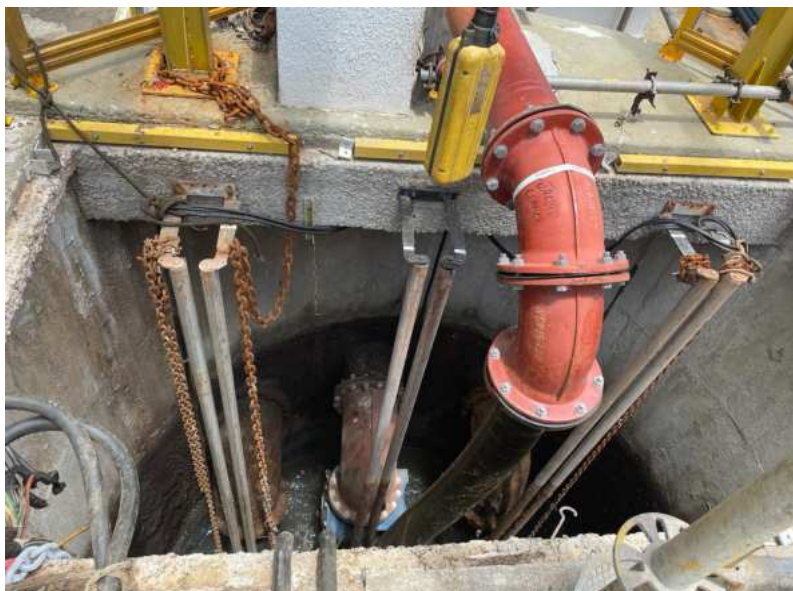
Figura 2 - Poço de sucção onde estão localizados os conjuntos motobombas submersíveis.
