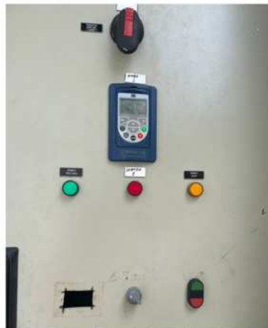
Figura 6 - Inversor de frequência do conjunto motobomba.
