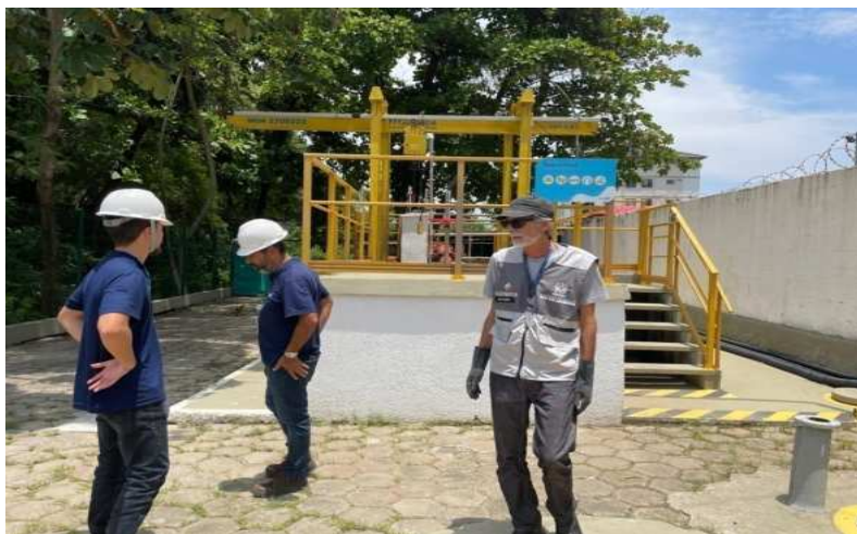
Figura 15 - Monovia com talha para içamento das bombas para manutenções.
