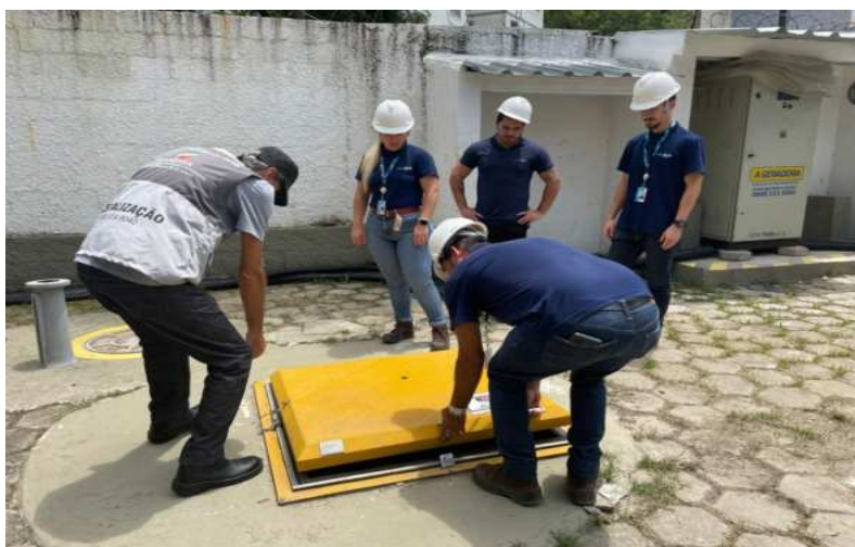
Figura 9 – Colaboradores da Concessionária realizando a abertura da caixa de areia, por onde chega o esgoto da elevatória, para inspeção.
