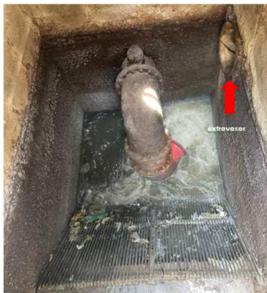
Figura 11 - Poço de gradeamento onde é realizada a retirada de resíduos sólidos do esgoto bruto e localização do extravasor.
