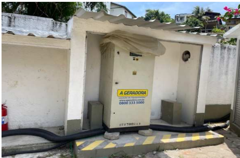
Figura 14 – Quadro elétrico do gerador de emergência.
