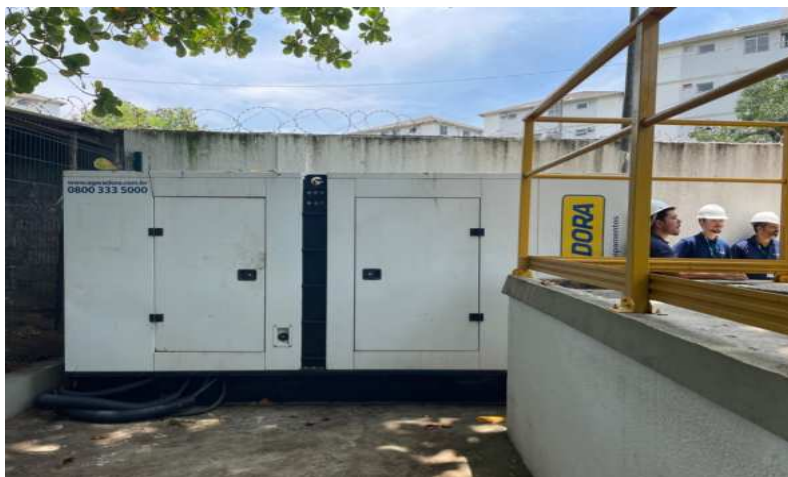
Figura 13 - Gerador de energia para futuras emergências.
