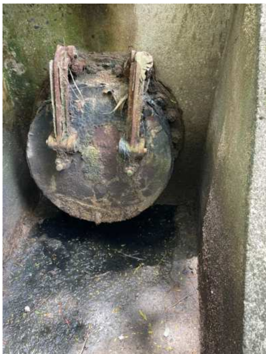
Figura 16- Extravador na posição fechada e sem sinais de vazamento.
