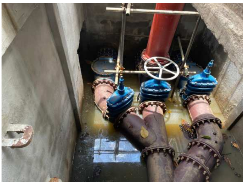
Figura 3 – Localização das válvulas de retenção manual para proteção antigolpe.
