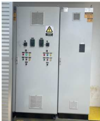
Figura 5 - Painel de controle dos conjuntos motobombas.
