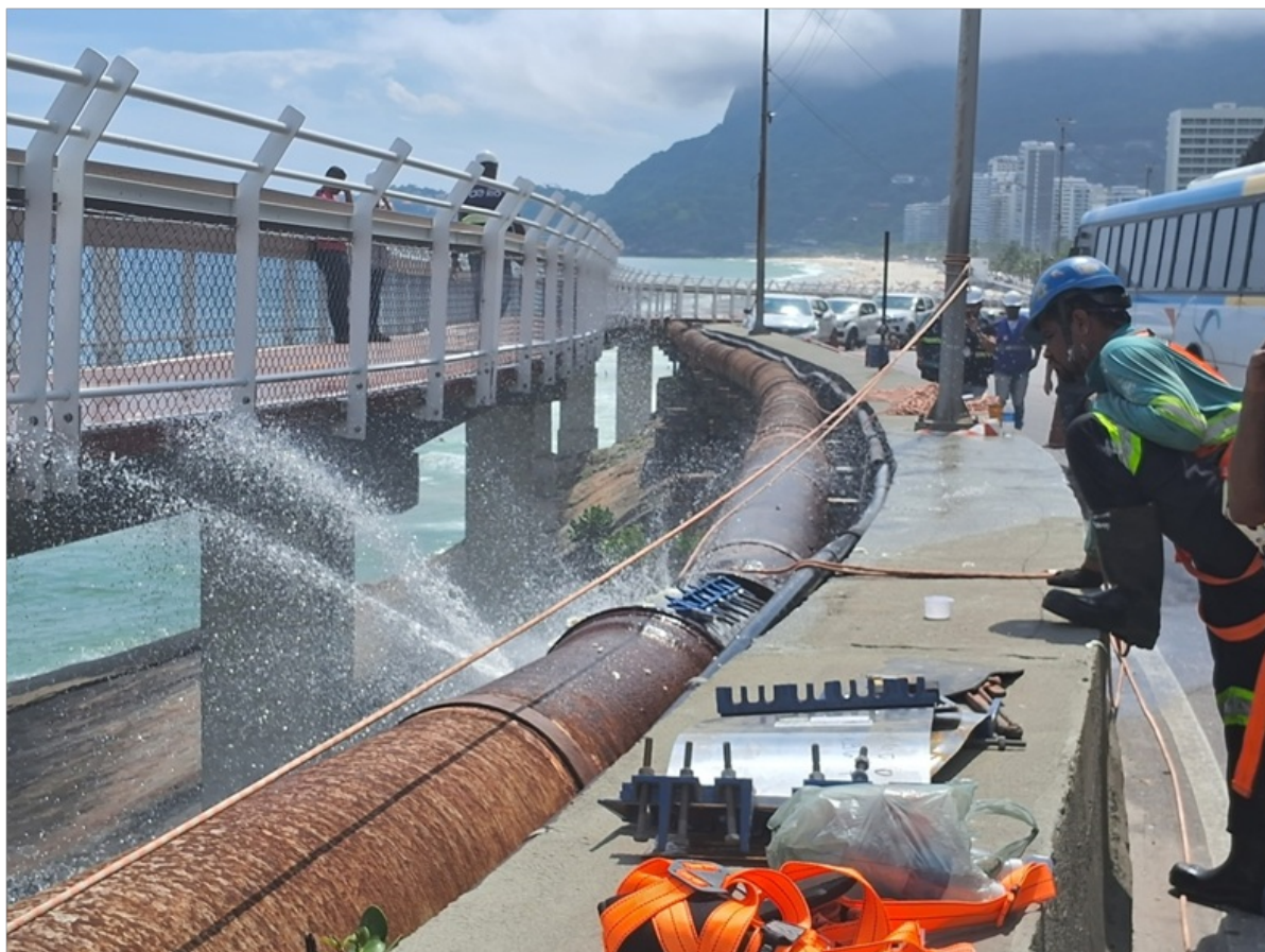
Foto 06 - Retorno do vazamento após retomada da EEE São Conrado
