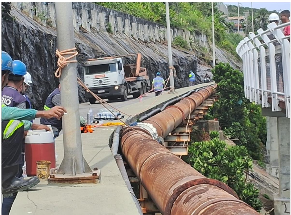
Foto 04 - Local do rompimento
