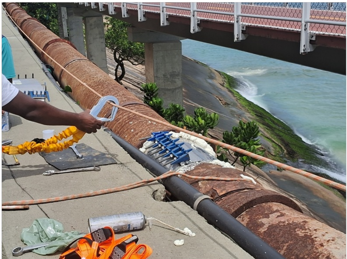
Foto 05 - Local do rompimento
