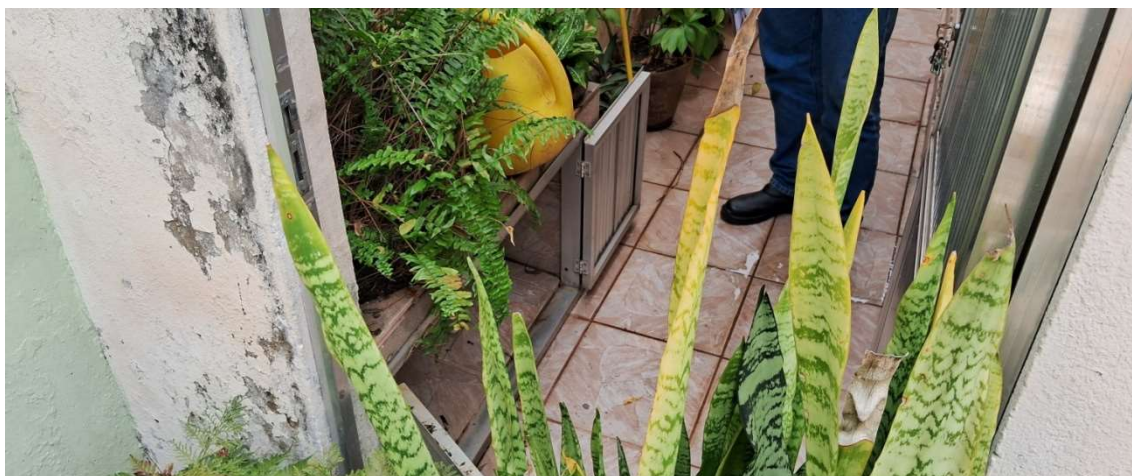
Foto 7 – Caixa de proteção do hidrômetro.
