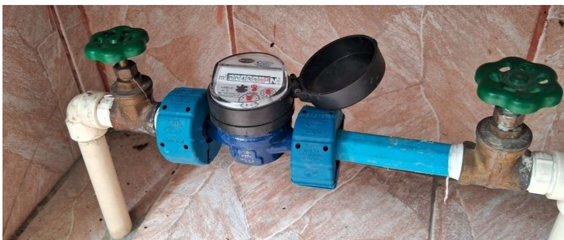
Foto 3 – Hidrômetro do imóvel nº 190 A, casa 1.
