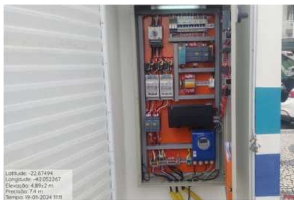
Foto 10: Pannel elétrico da nova estação elevatória
