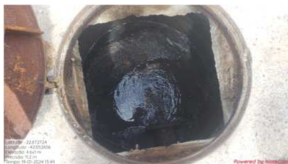
Foto 8: PV 006 – Receptor de águas pluviais
