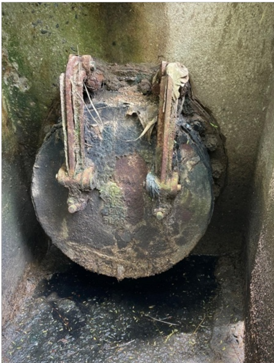
Figura 6 - Foto da válvula do extravasor que só é utilizada em manutenções do poço de sucção das bombas.
