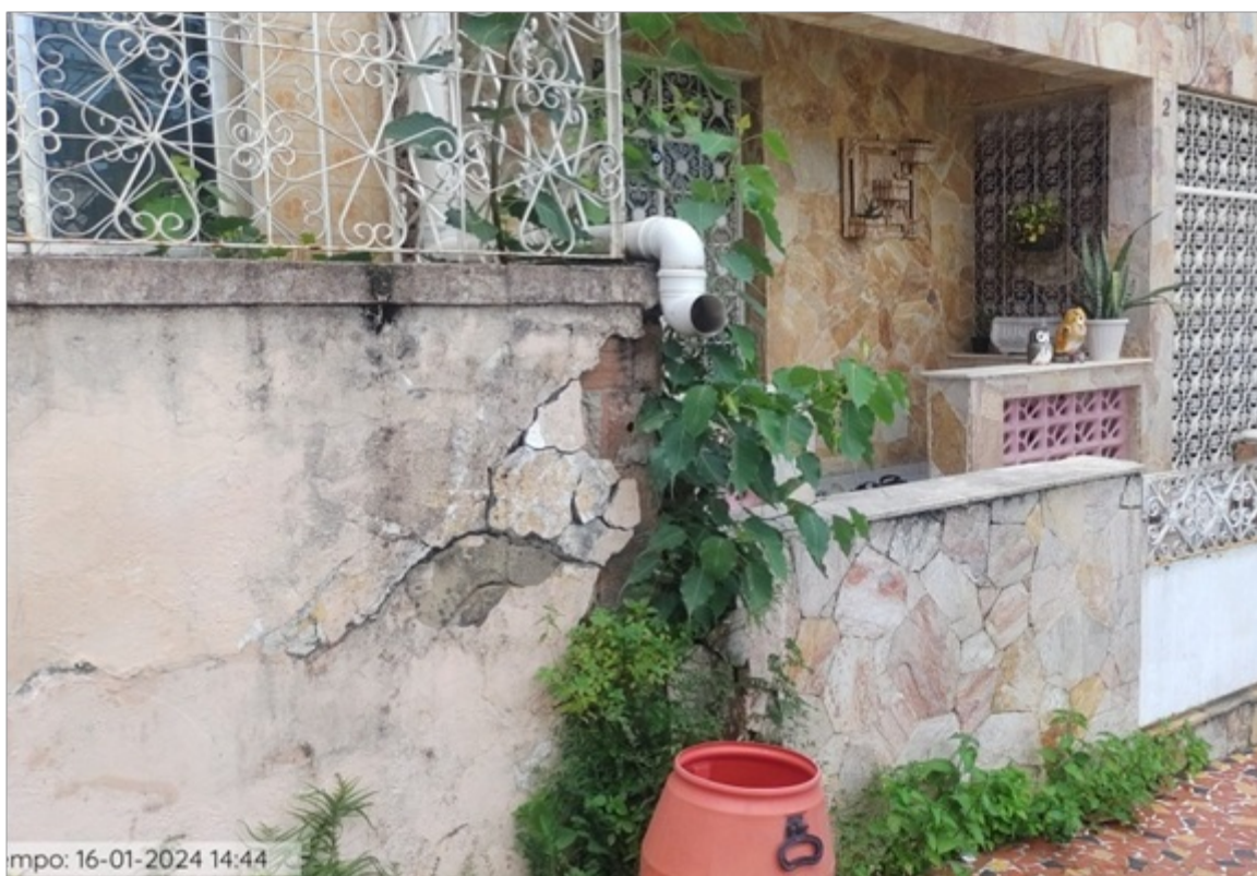
Foto 5: Dispositivo informal para coleta de águas pluviais
