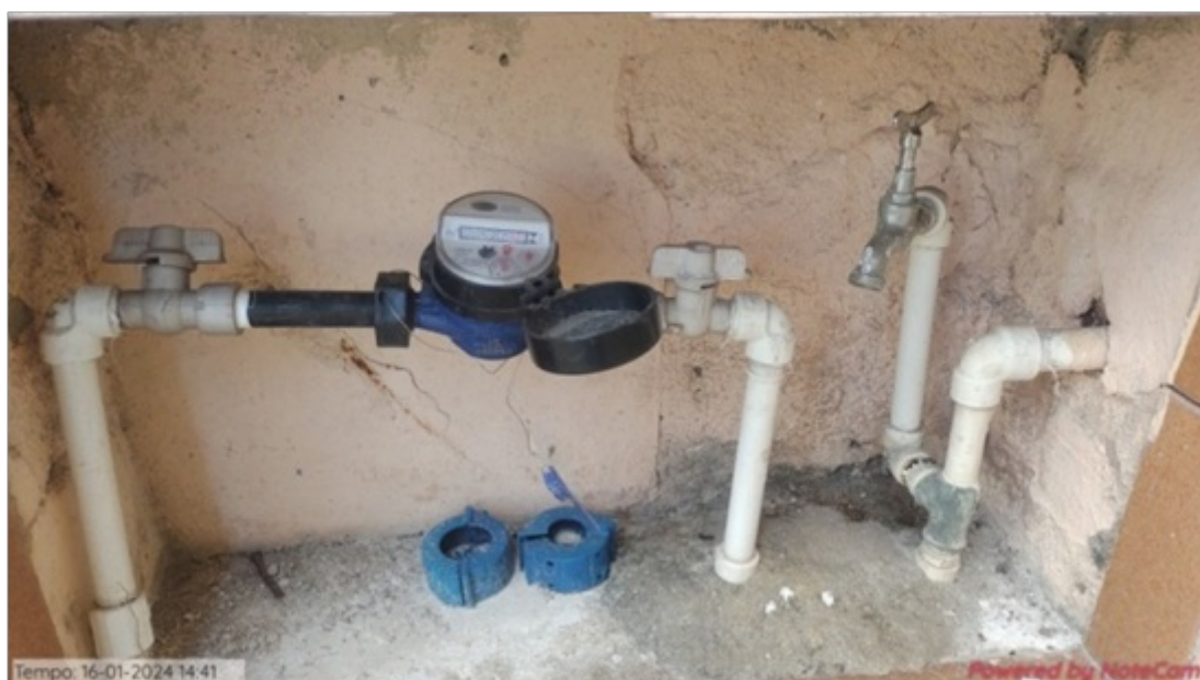
Foto 4: Hidrômetro do imóvel
