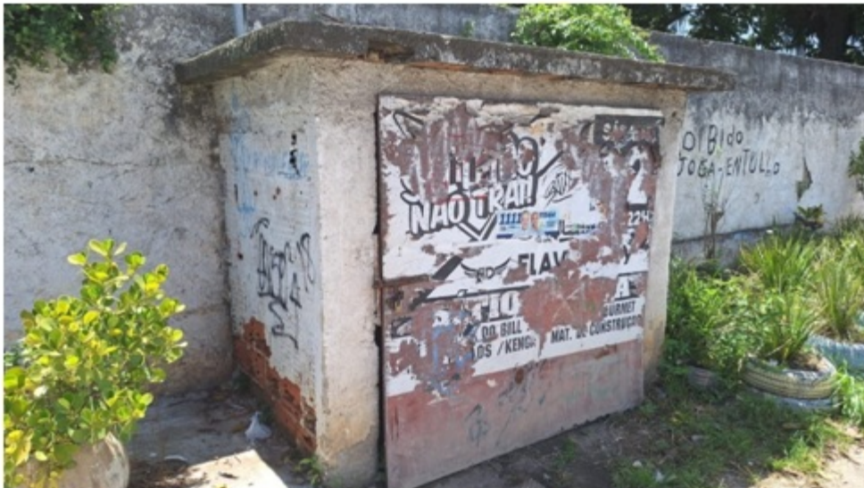
Foto 4: estação elevatória de água tratada localizada na Avenida Areia Branca.
