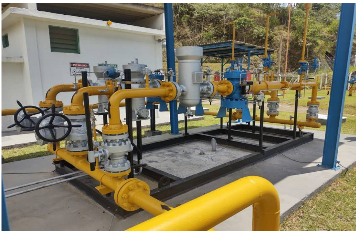
Foto 4: Estação de redução de pressão, primeiro corte.
