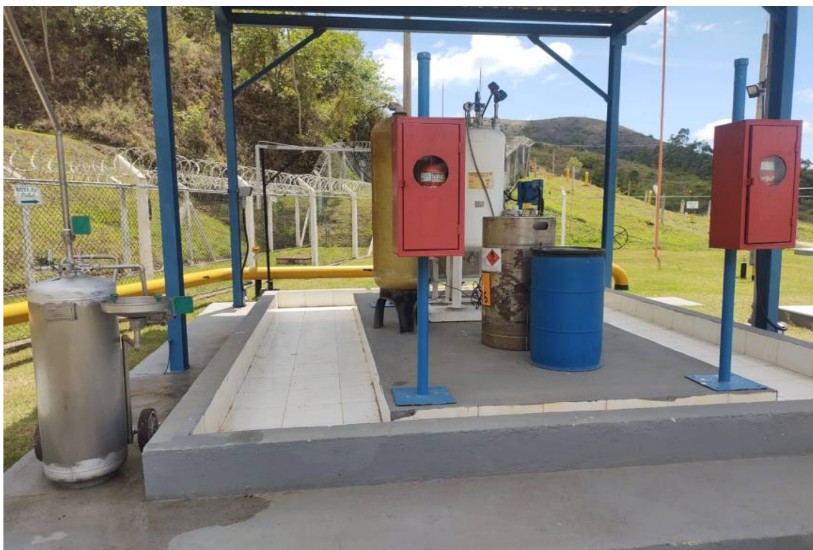
Foto 6: Sistema de odorização.
