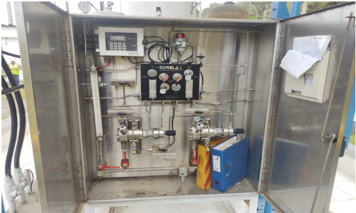
Foto 13: Painele de odoração com marcas de passagem de insetos.
