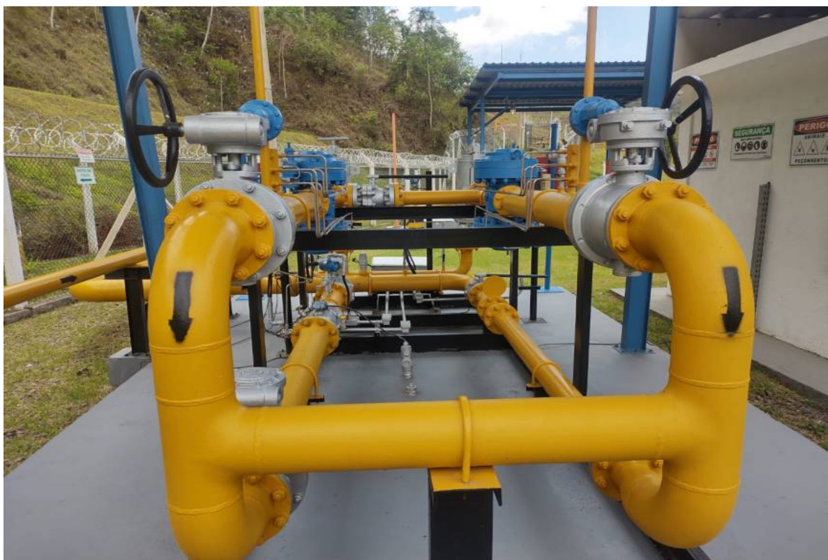
Foto 5: Estação de redução de pressão, segundo corte.
