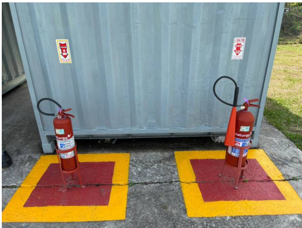
Foto 11: Extintores de incêndio sem capa de proteção.
