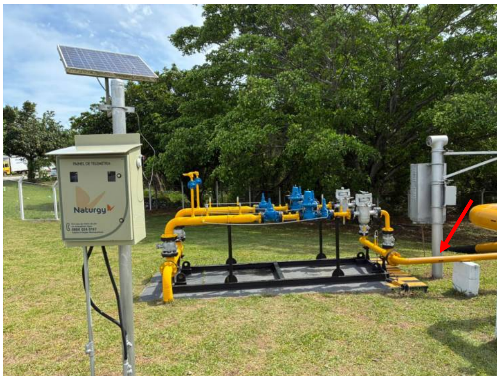
Foto 7: Derivação para a ERD; sistema de telemetria e painel fotovoltaico à esquerda.
