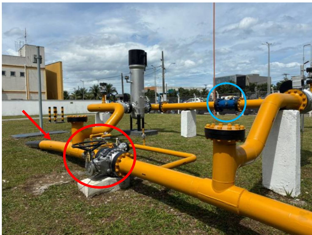
Foto 3: Entrada do gás do GASCABO e válvula de bloqueio (em vermelho); medidor de vazão (em azul).
