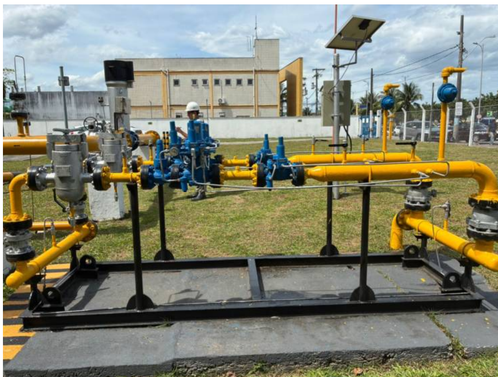
Foto 8: Vista da Estação de Regulação Distrital (ERD).
