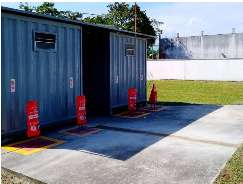
Foto 12: Extintores de incêndio com capa de proteção (foto enviada pela Concessionária).
