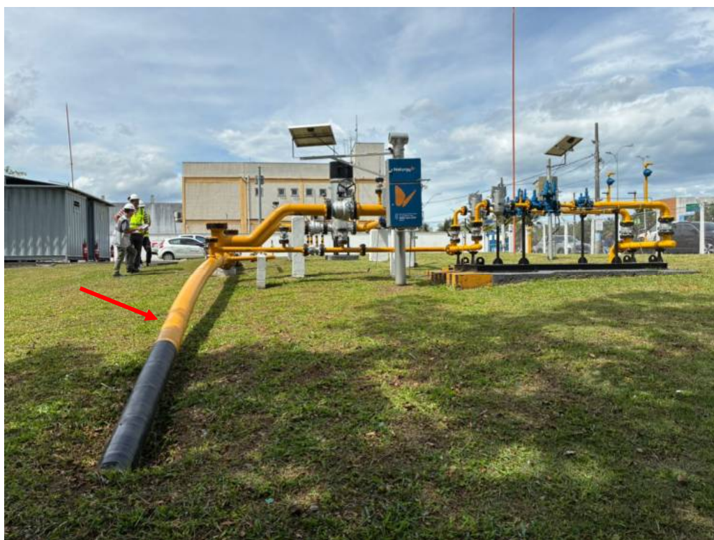
Foto 6: Saída do gás do GASCABO rumo à Arraial do Cabo.
