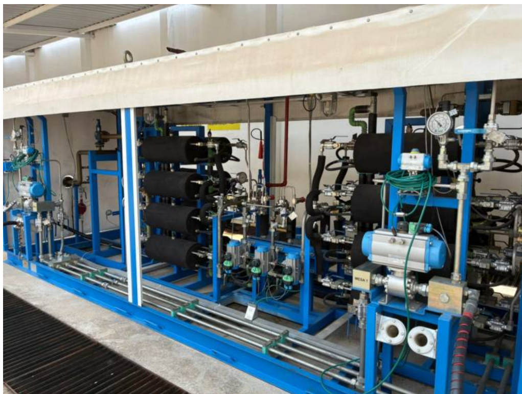
Foto 5: Unidade de Controle e Redução (RCU).
