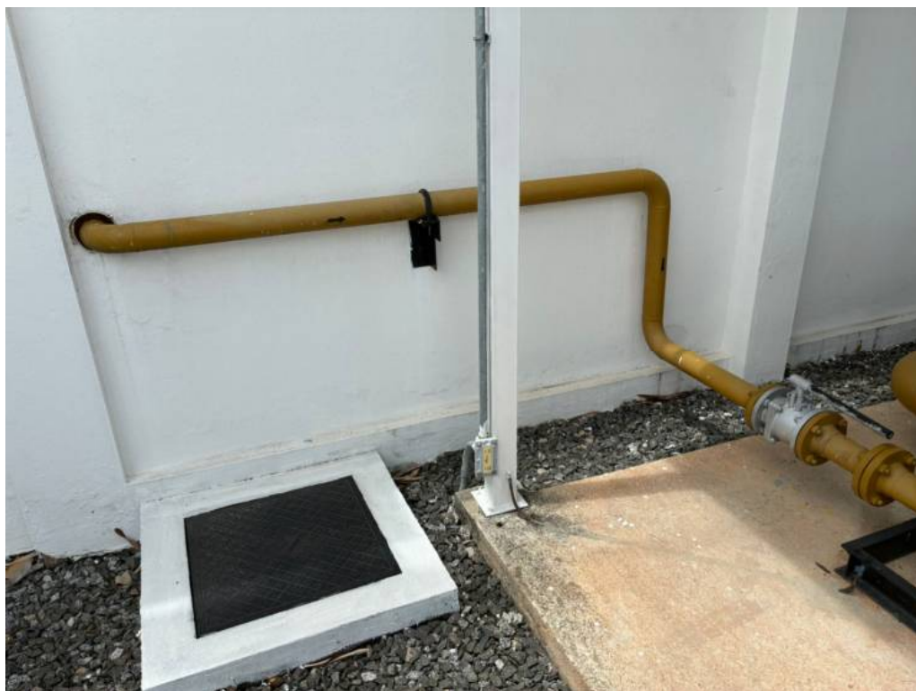
Foto 7: Linha de entrada da Estação de Regulação e Medição.
