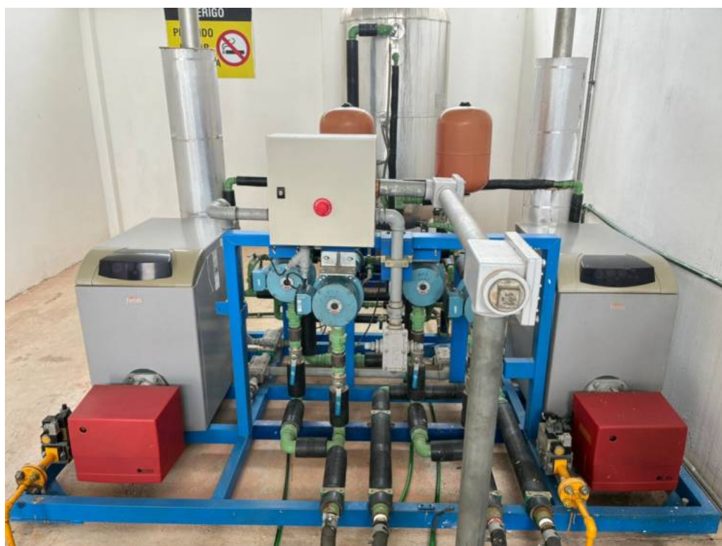
Foto 6: Sistema de aquecimento de água.
