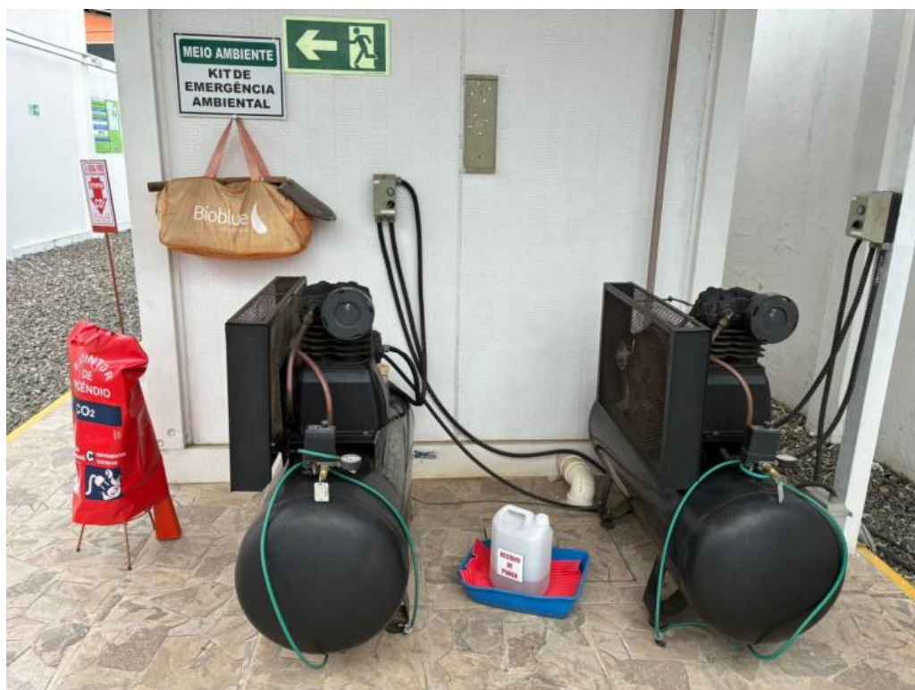
Foto 11: Compressores de ar para acionamento das válvulas da RCU.
