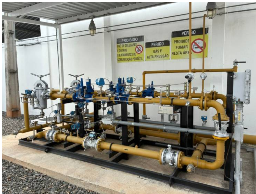
Foto 9: Estação de Regulagem e Medição.
