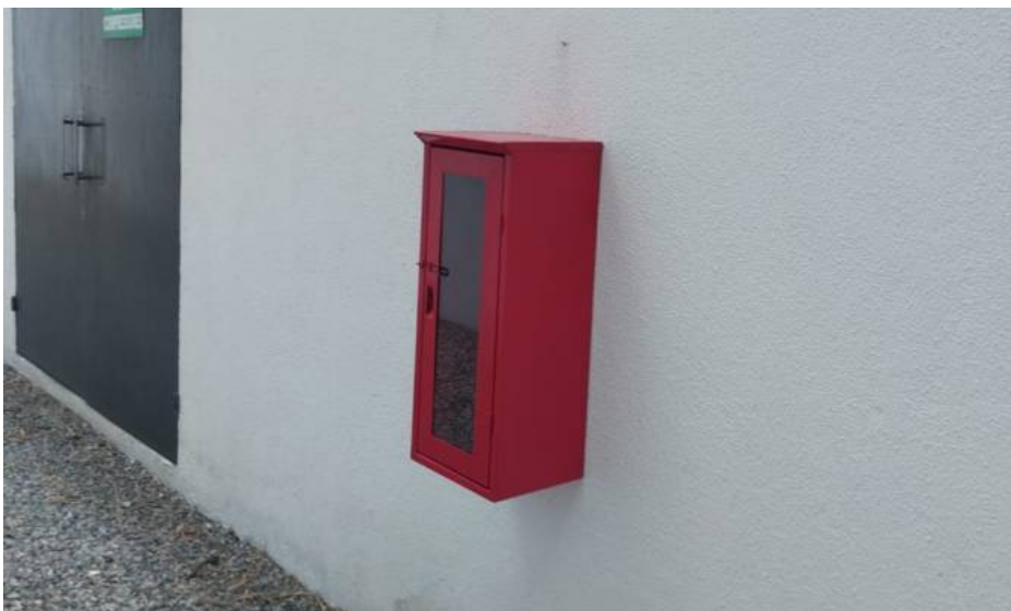
Foto 9: foto comprobatória da correção relacionada à proteção do extintor de incêndio enviada pelo gestor.
