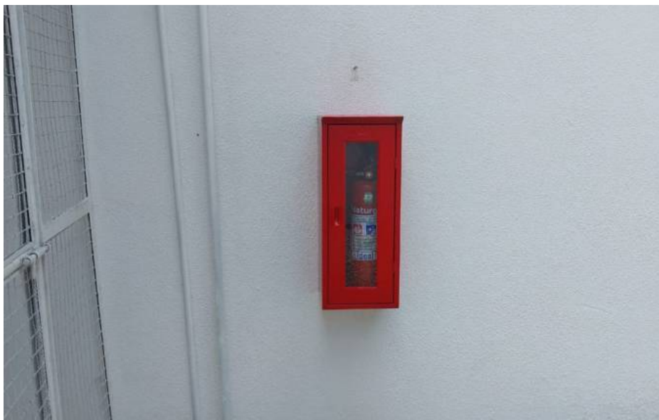
Foto 8: foto comprobatória da correção relacionada à proteção do extintor de incêndio enviada pelo gestor.
