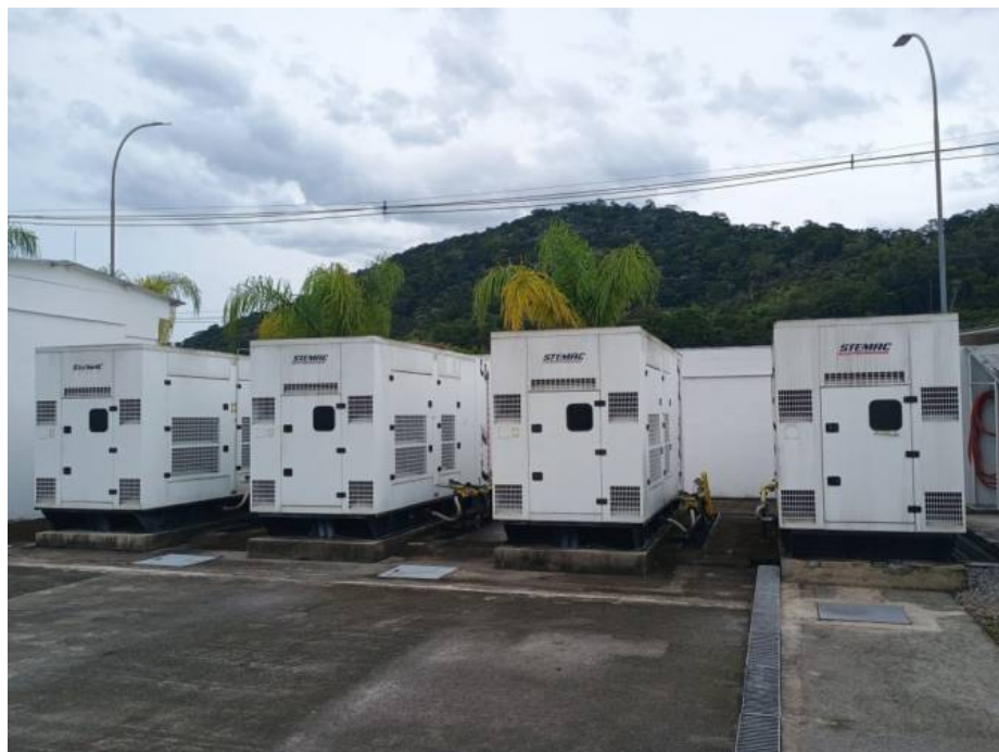
Foto 4: Geradores de energia à gás natural.
