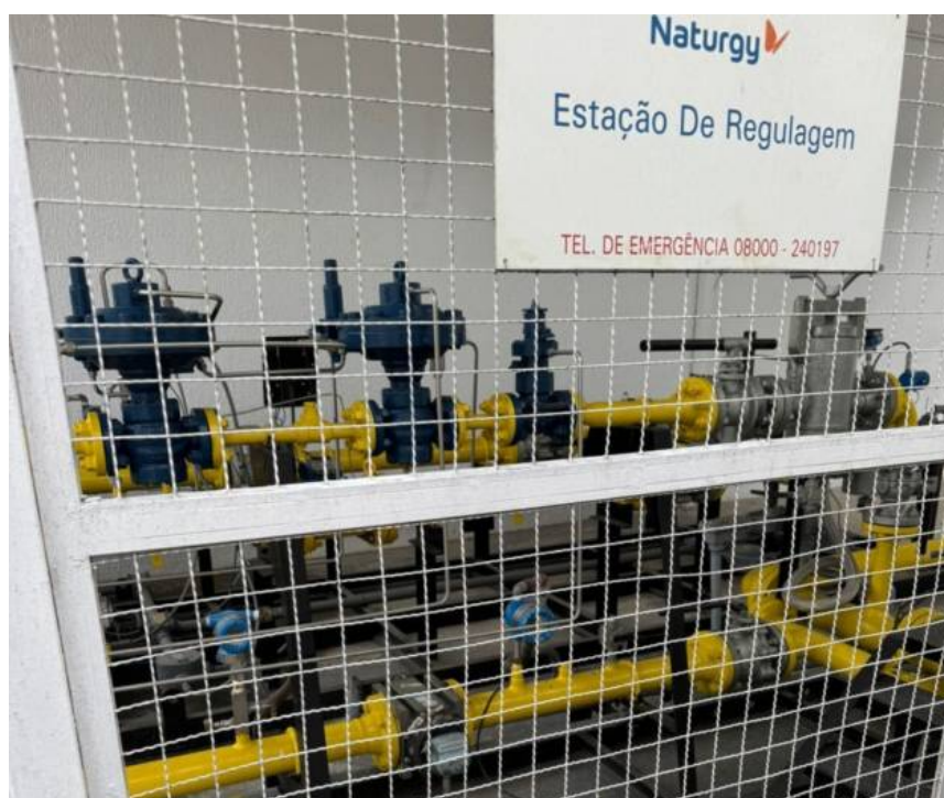
Foto 3: Estação de regulagem da concessionária.
