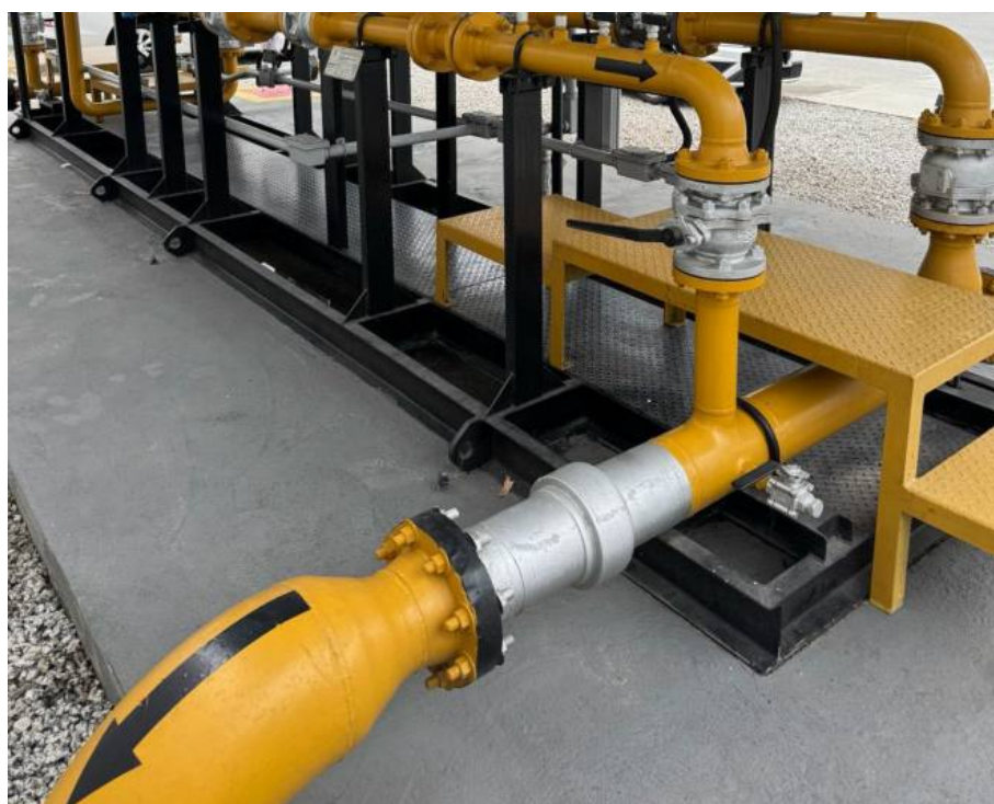
Foto 9: Saída do gás para a rede de distribuição no município e linha auxiliar sem medidor.
