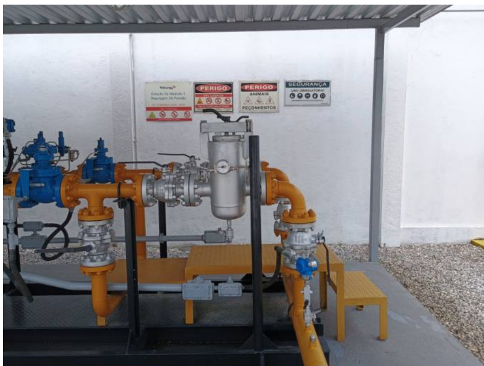
Foto 6: Conjunto de filtro e válvula.
