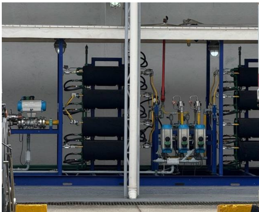
Foto 3: Parte do sistema responsável pelo aquecimento do gás.
