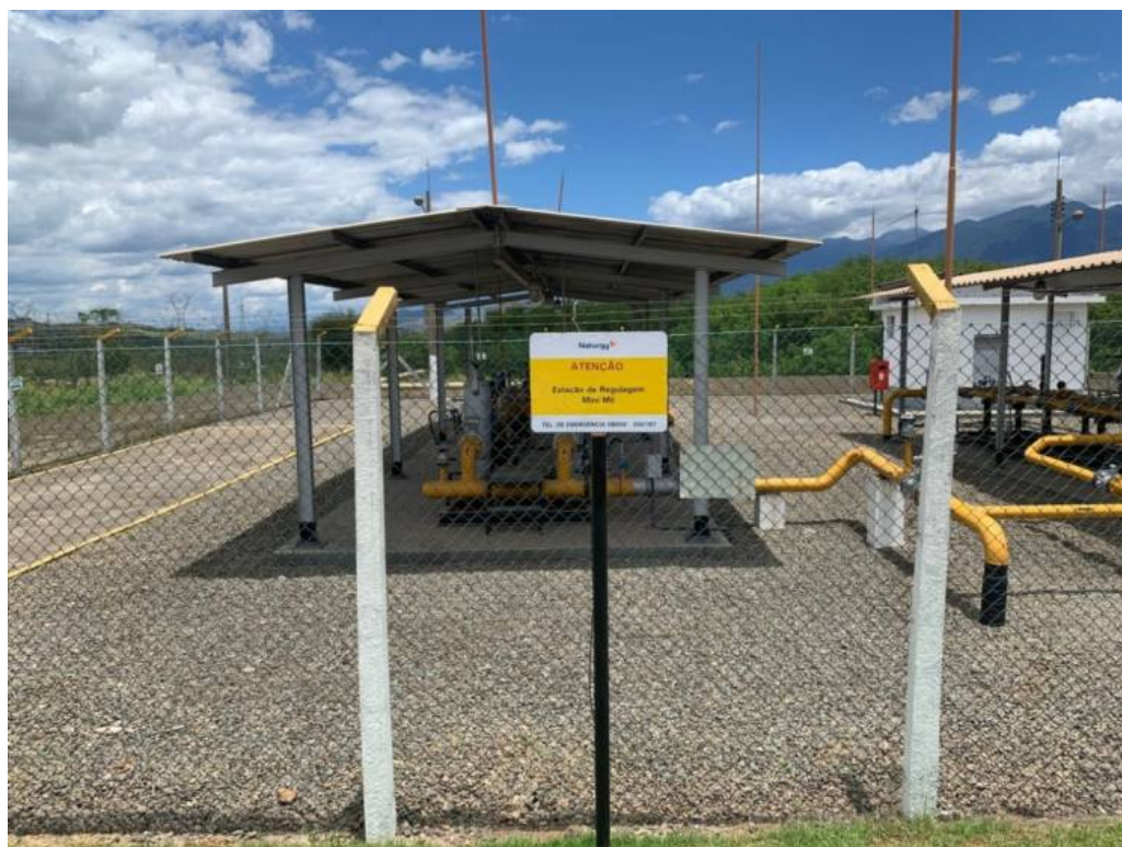
Foto 2: Placa de identificação da ER Mini Mil.
