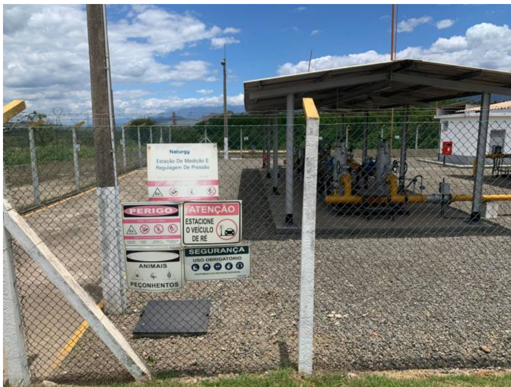
Foto 3: Placas de identificação da estação e de sinalização de segurança.
