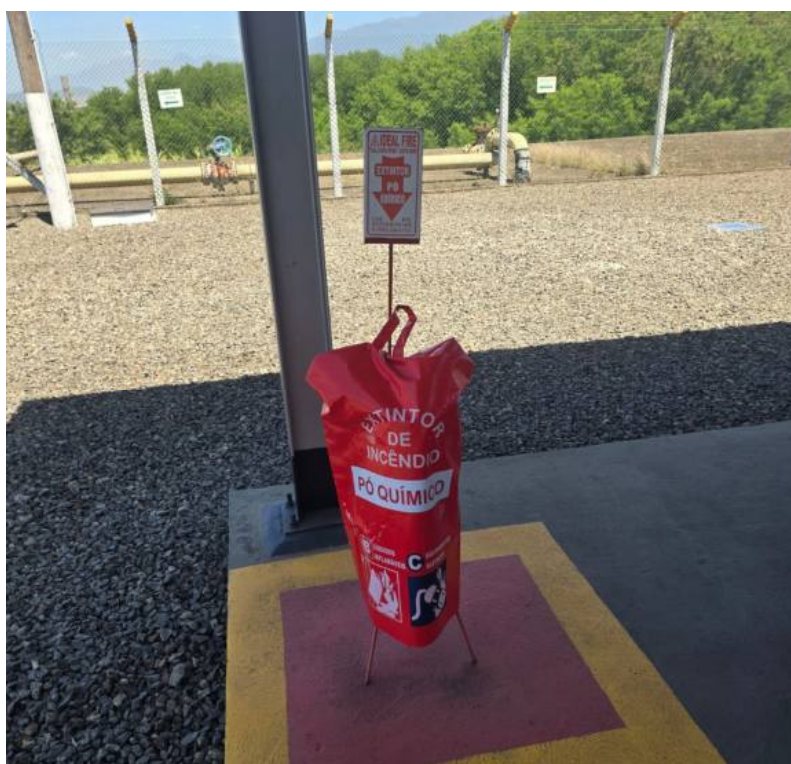
Foto 8: Extintor de incêndio com capa de proteção (foto enviada pela Concessionária).
