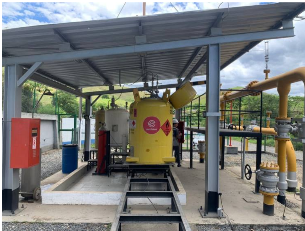
Foto 7: Tanque de armazenamento de odorante.
