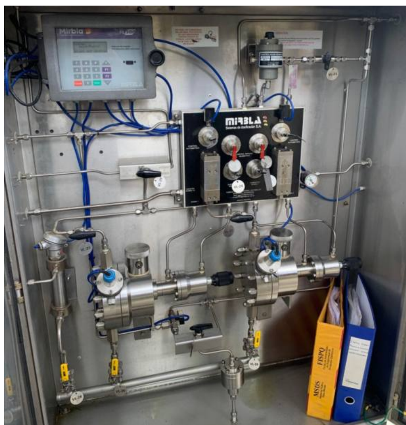
Foto 6: Painei de controle do sistema de odoração.
