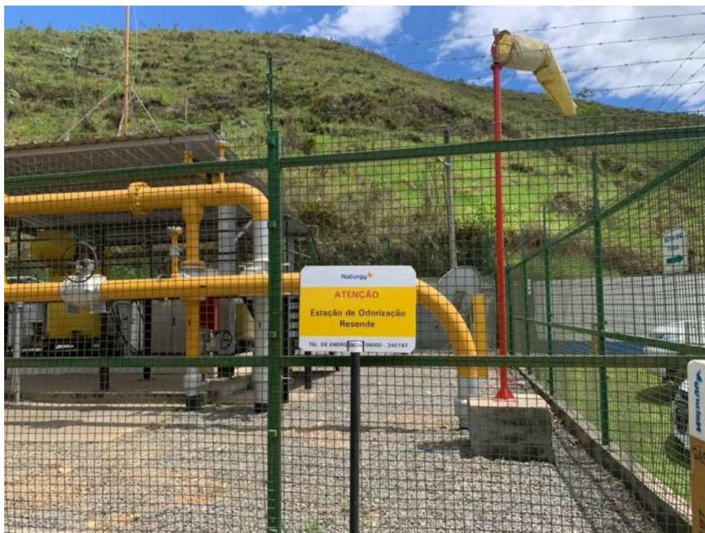
Foto 1: Placa de identificação da estação.
