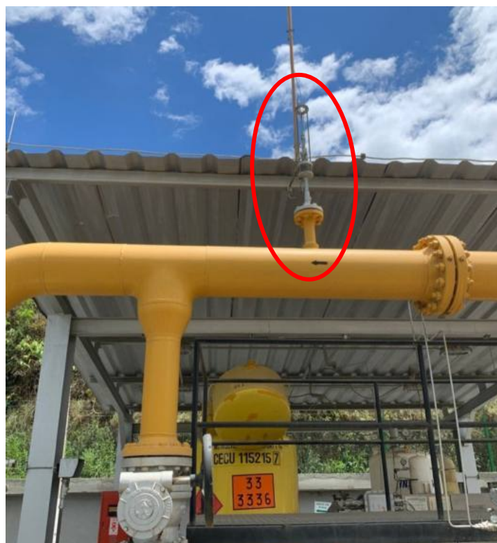
Foto 4: Sistema de injeção de odorante na linha de saída do gás.
