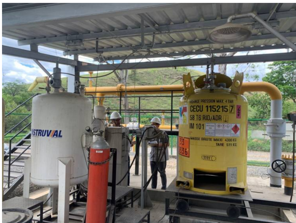
Foto 8: Sistema de odorização da estação.
