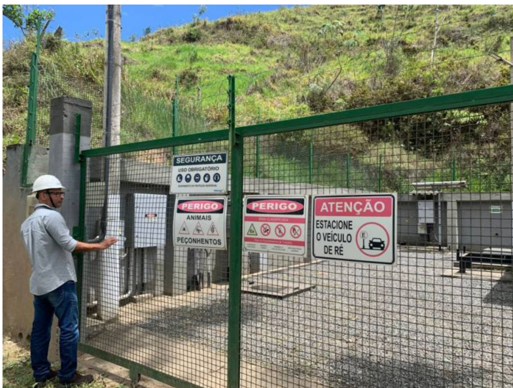
Foto 2: Entrada da estação com placas de sinalização de segurança.
