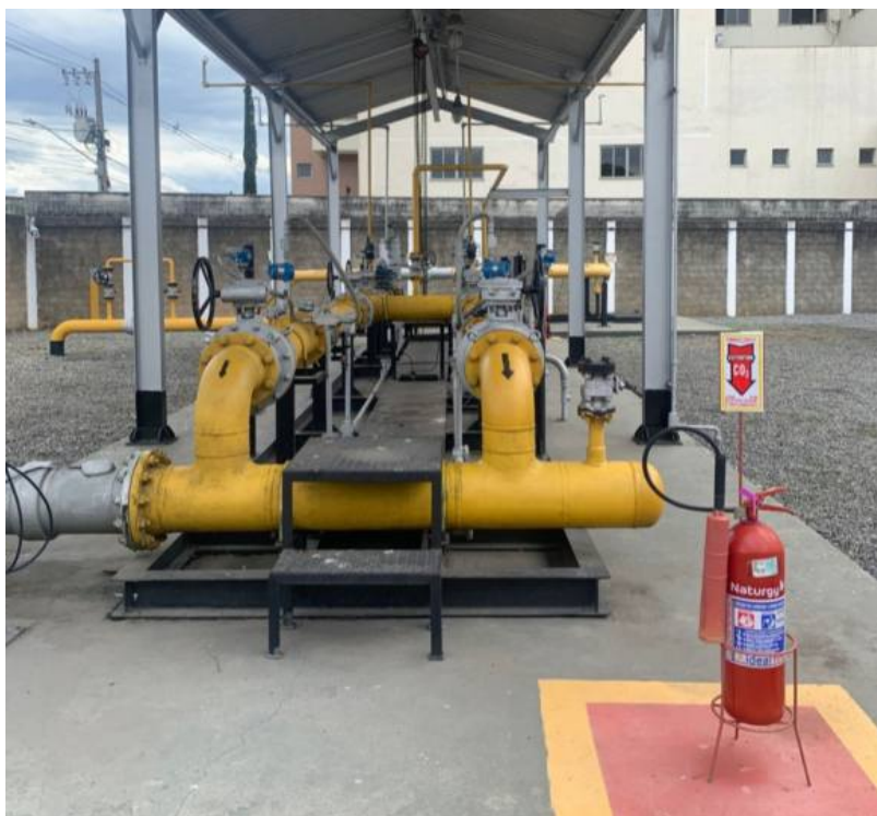
Foto 5: Linhas de saída da estação; extintor de incêndio sem capa de proteção.
