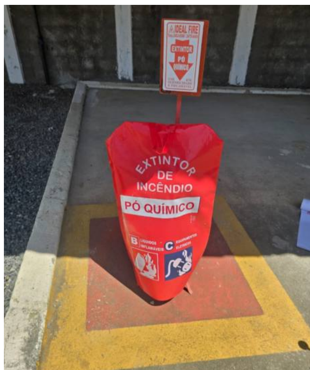
Foto 10: Extintor de incêndio com capa de proteção (foto enviada pela Concessionária).
