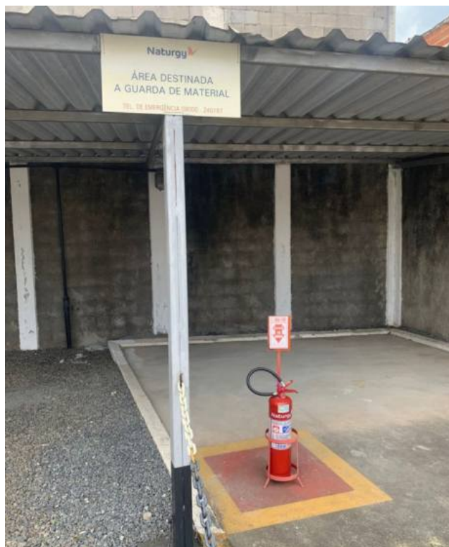
Foto 9: Extintor de incêndio sem capa de proteção.
