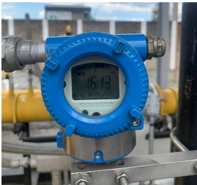
Foto 4: Medida de pressão de saída do gás.
