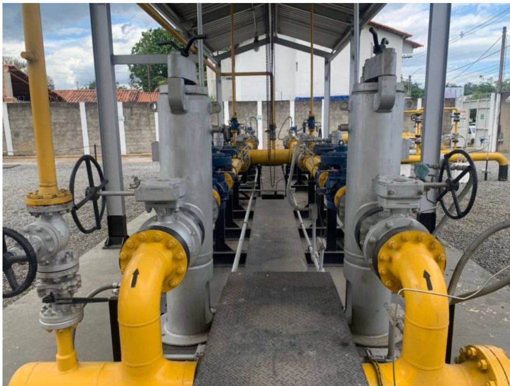
Foto 3: Linhas de entrada da estação, com suas válvulas, filtros, reguladores e medidores.
