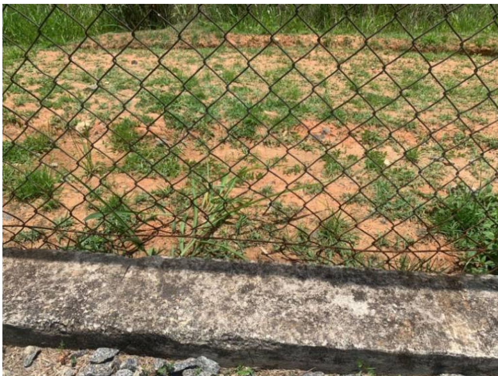
Foto 11: Falha na cerca de proteção da estação.
