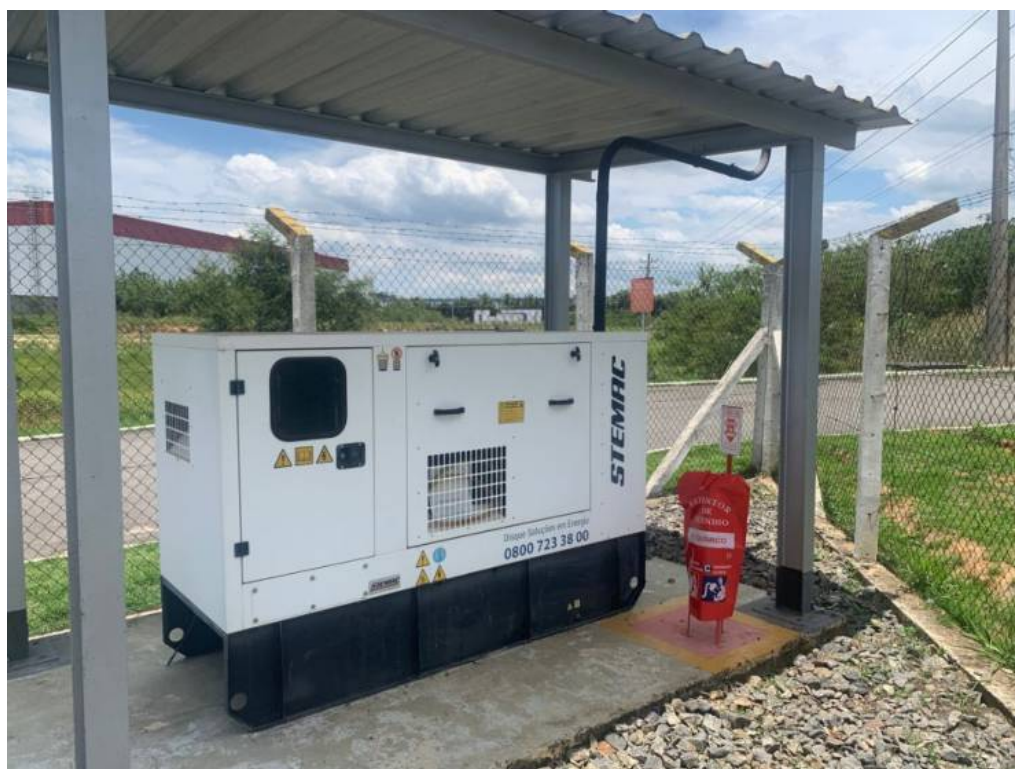
Foto 10: Gerador de energia e extintor de incêndio com capa de proteção.
