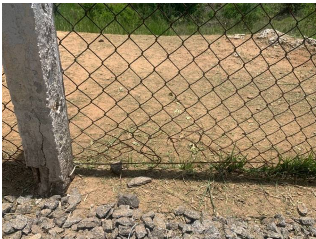
Foto 12: Falha na cerca de proteção da estação.
