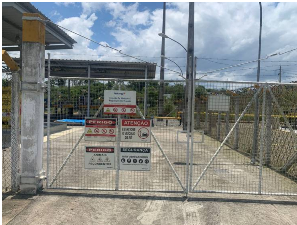
Foto 1: Entrada da ERM Cidade do Aço, com placas de sinalização de segurança.
