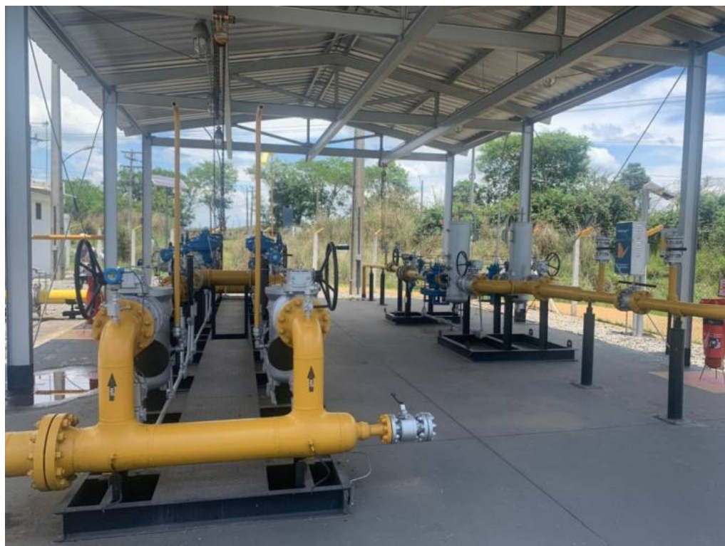
Foto 3: Entrada do gás na ETC (à esquerda), vindo da NTS.
