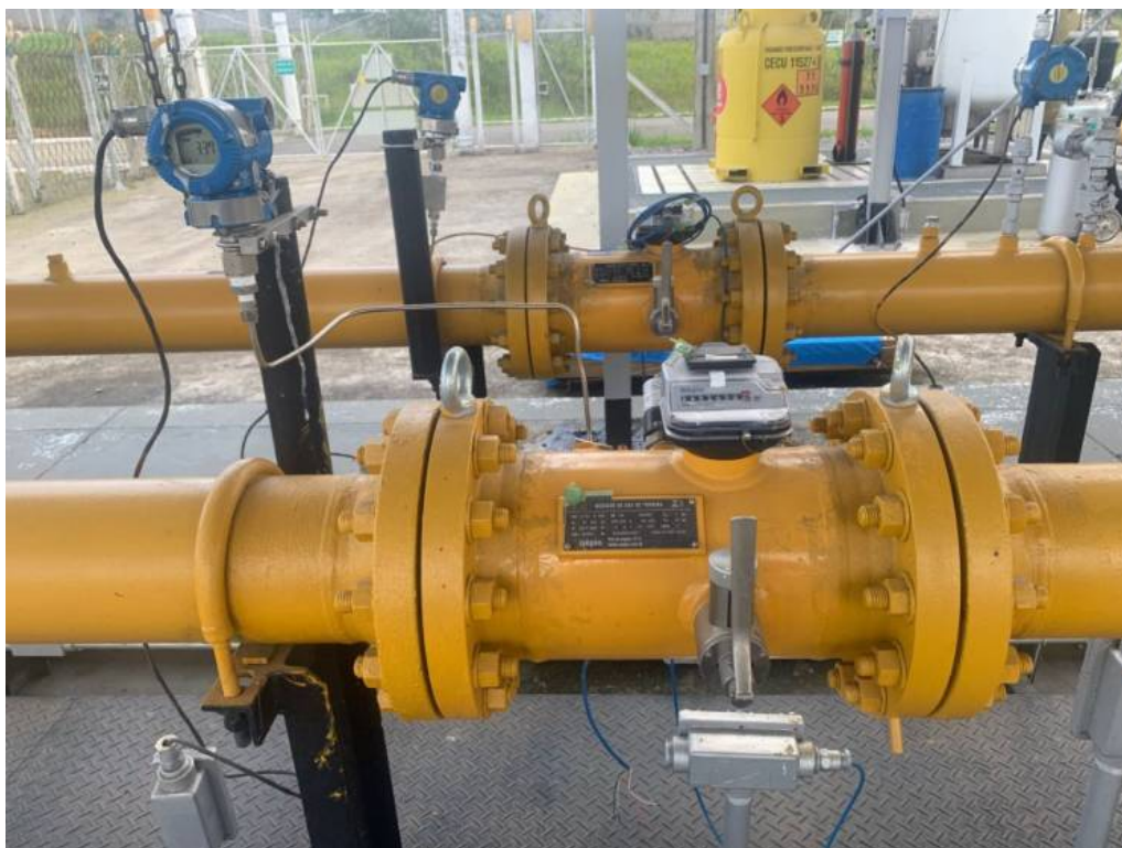
Foto 4: Medidores e conversores nas duas linhas da ETC.
