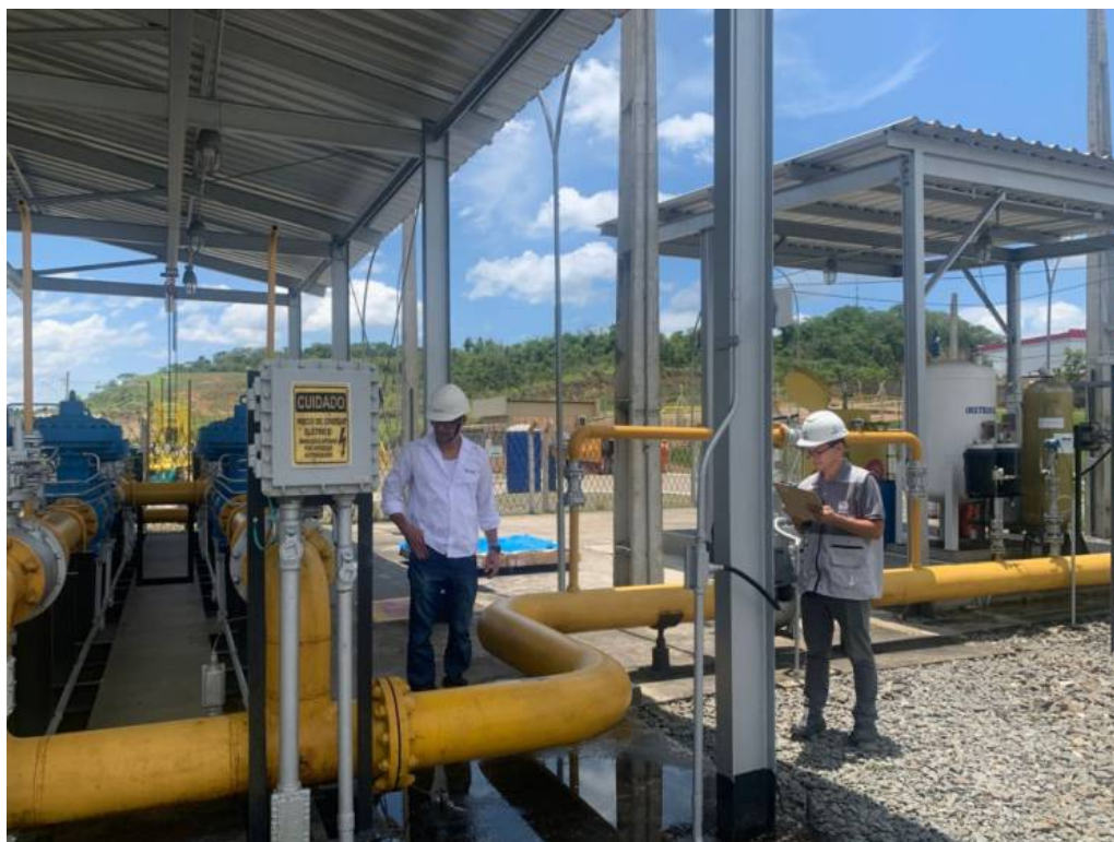
Foto 5: Saída do gás da ETC; sistema de odoração ao fundo (à direita).
