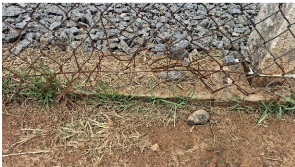
Foto 14: Falha na cerca reparada (foto enviada pela Concessionária).
