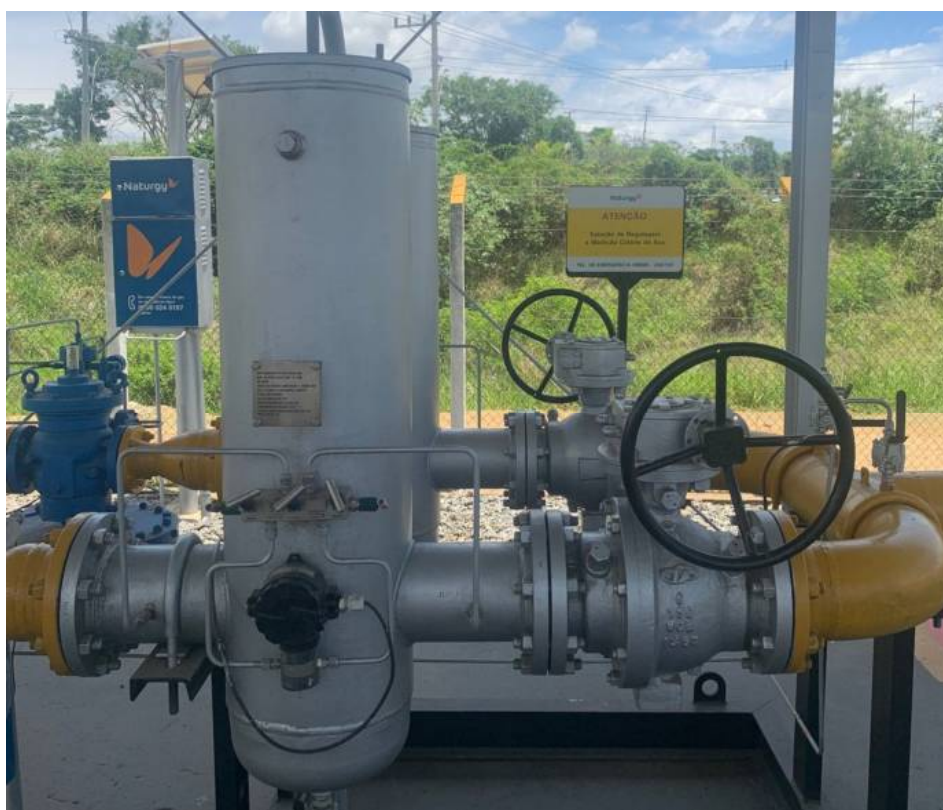
Foto 8: Filtros e válvulas da ERD; placa de identificação da estação ao fundo.
