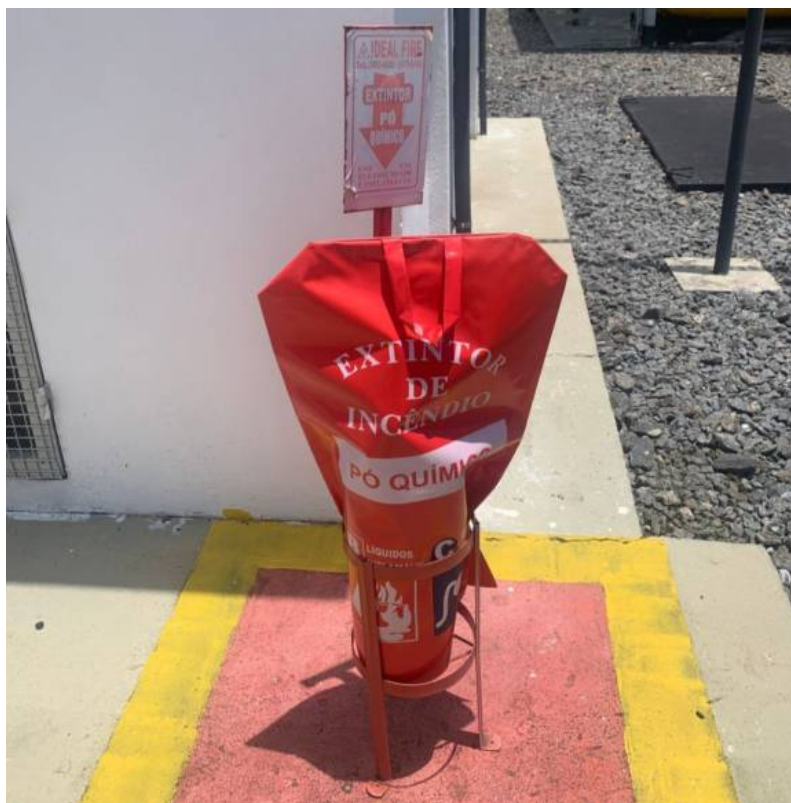
Foto 9: Extintor de incêndio com capa de proteção.
