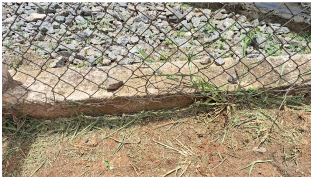
Foto 13: Falha na cerca reparada (foto enviada pela Concessionária).
