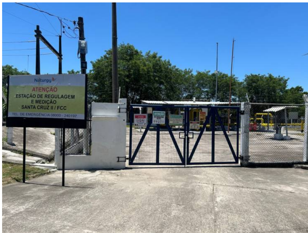
Foto 1: Placa de identificação da estação e portão de entrada com placas de sinalização de segurança.
