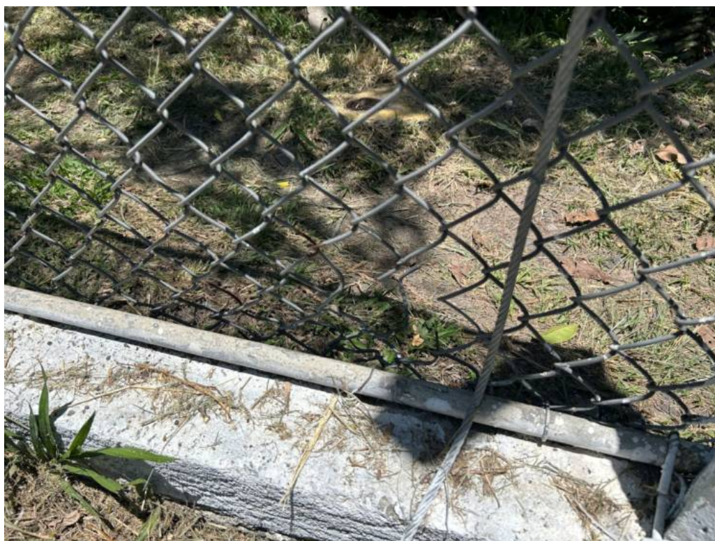
Foto 10: Falha na cerca de proteção da estação.
