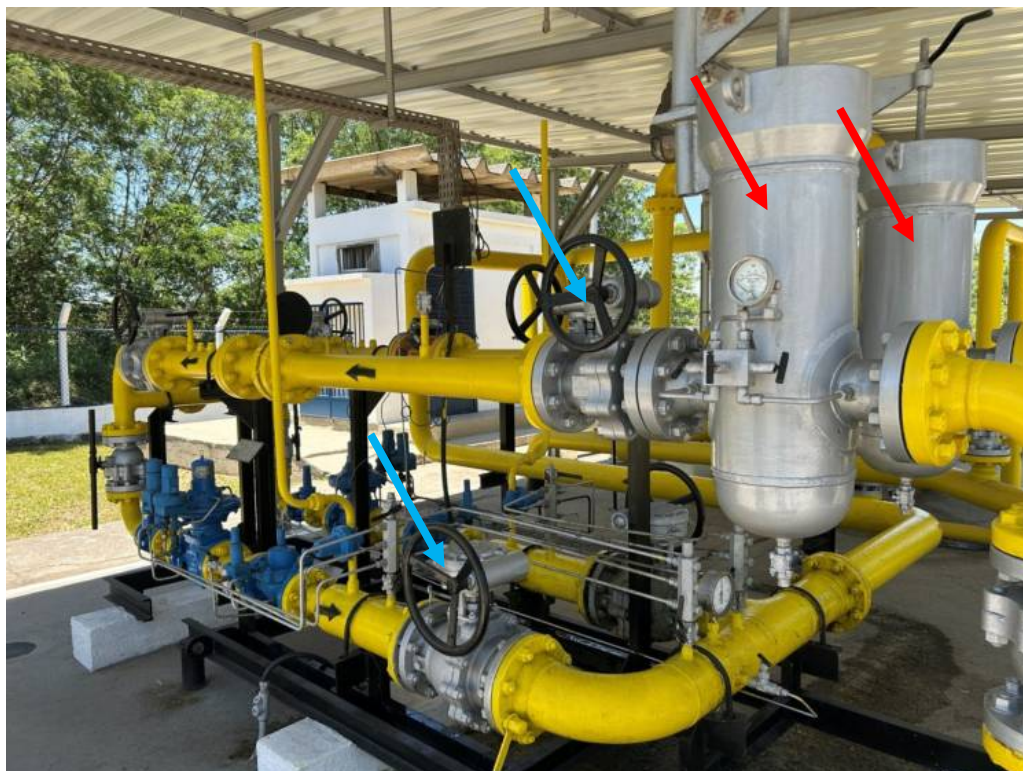
Foto 4: Filtros (setas vermelhas) e válvulas (setas azuis).
