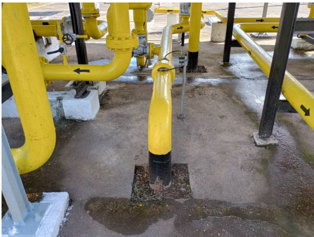
Foto 3: Entrada do gás na estação.
