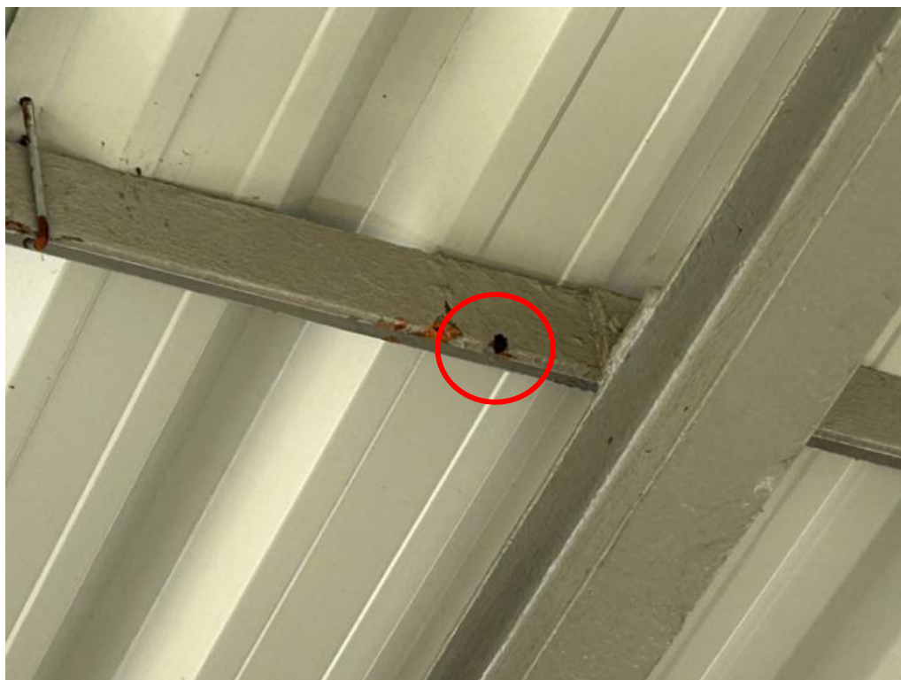
Foto 8: Ninho de marimbondo na cobertura da estação.
