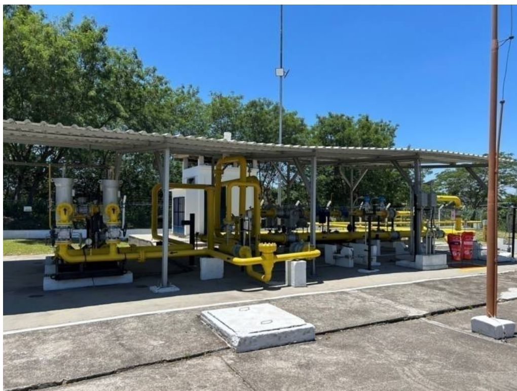
Foto 2: Visão geral da estação de regulagem e medição.
