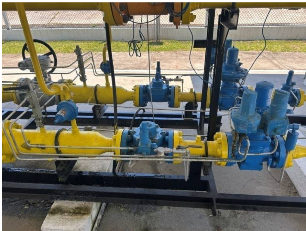
Foto 5: Conjunto de reguladores.
