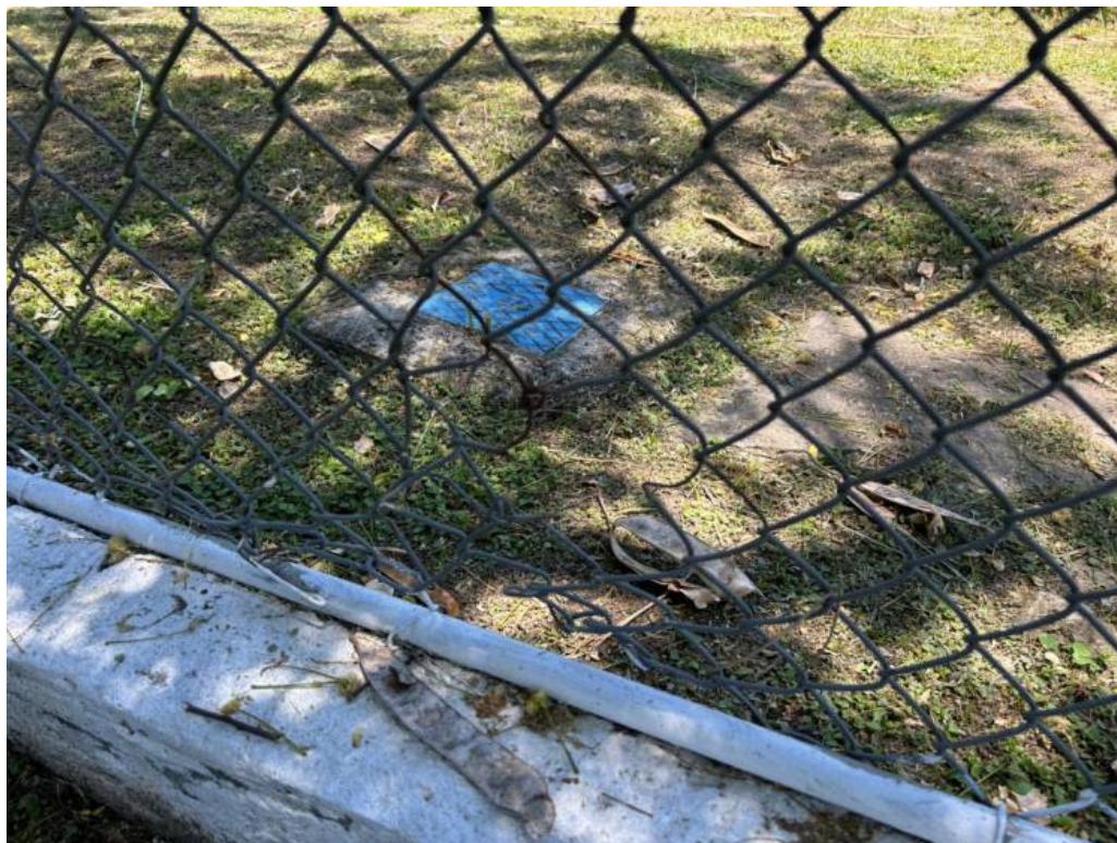
Foto 9: Falha na cerca de proteção da estação.
