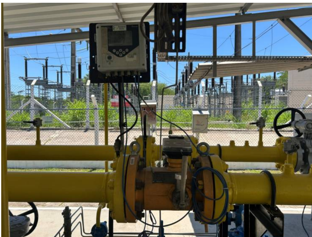
Foto 6: Medidor e conversor.
