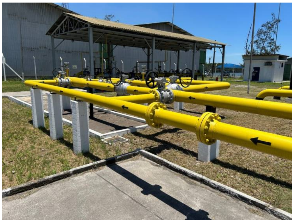
Foto 8: Canhão receptor de PIG (duto de aço de 8").
