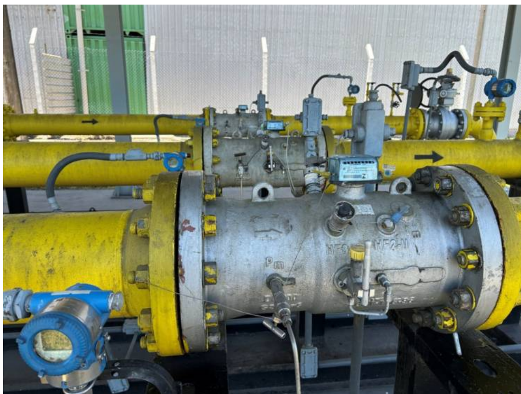
Foto 6: Três linhas de medição, cada uma com medidor e conversor.
