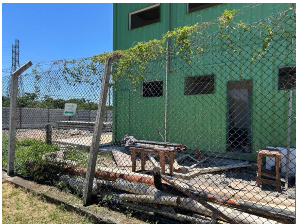
Foto 10: Presença de vegetação sobre a cerca e suporte instável devido a apoio irregular de materiais.
