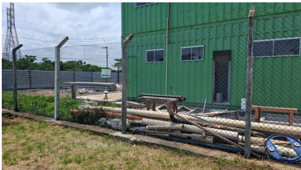
Foto 12: Cerca e suporte reparada (foto enviada pela Concessionária).
