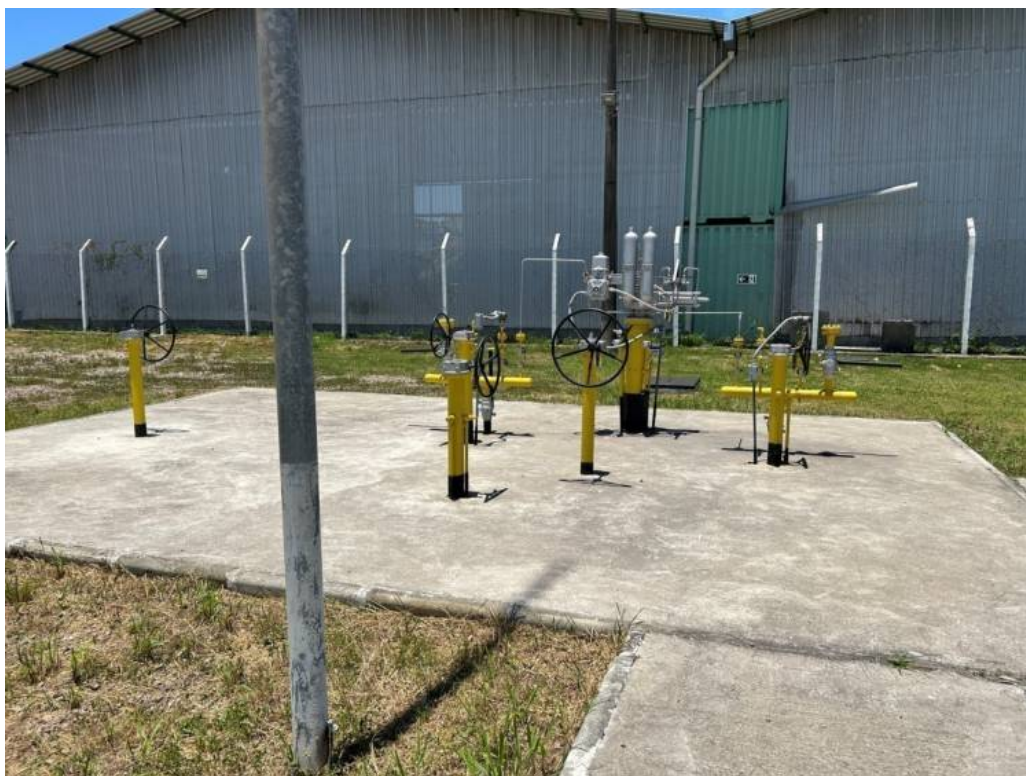
Foto 9: Conjunto de válvulas telecomandadas.
