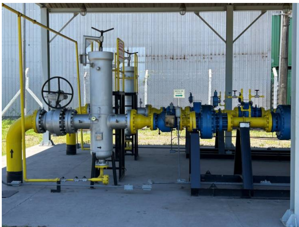
Foto 4: Duas linhas de entrada, cada uma com válvulas de bloqueio, filtros e reguladores.
