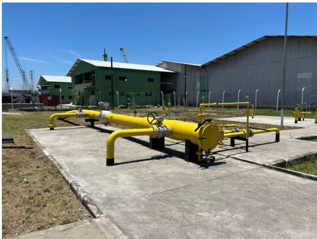
Foto 7: Canhão receptor de PIG (duto de aço de 16").
